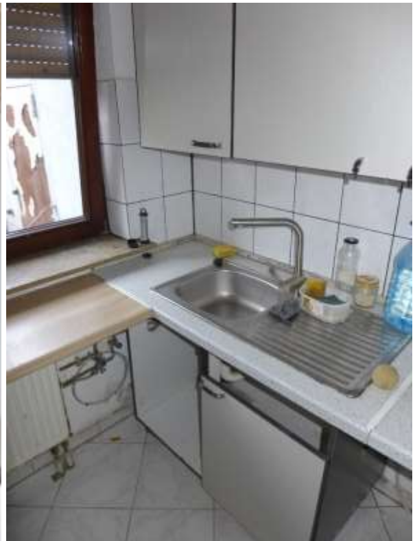
30 b Zustand Küche Wohnung Nr. 12
