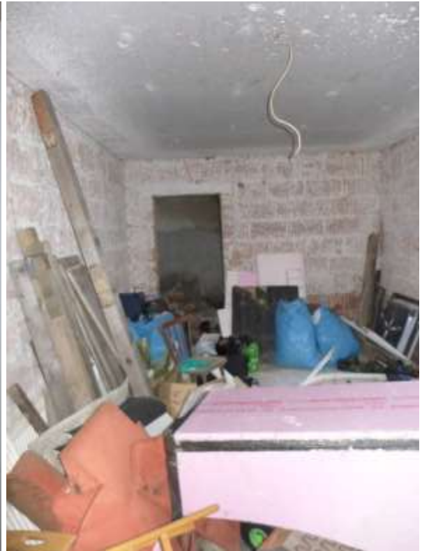
23 b Zustand Hausmeisterraum Wohnhaus B
