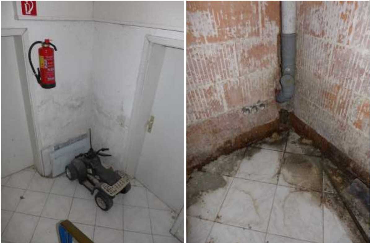
15 Feuchteschäden Kellergeschoss Wohnhaus B
