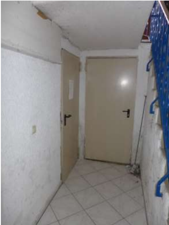
21 a Zustand Kellerflur Wohnhaus B
