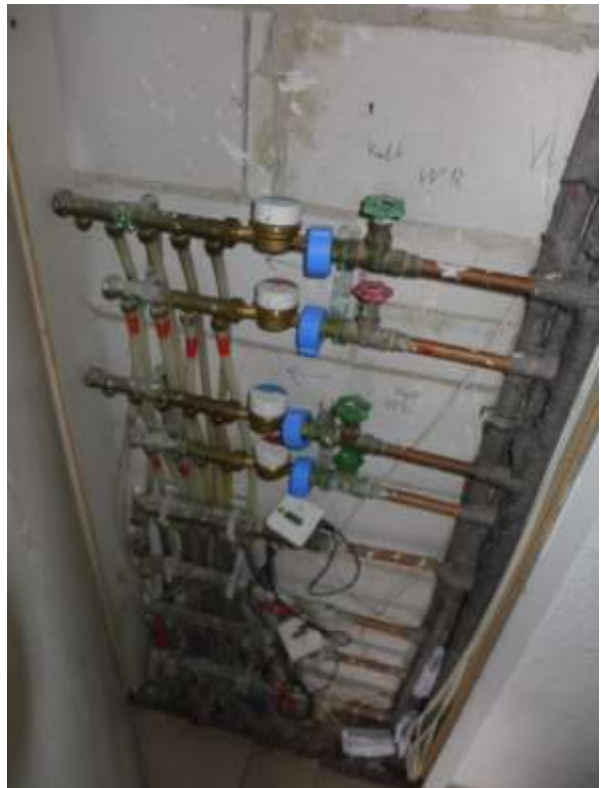
26 b Heizverteilung Wohnhaus B
