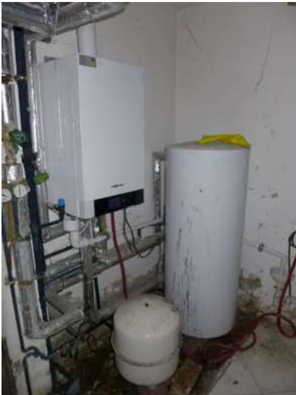
22 a Heizung Wohnhaus B
