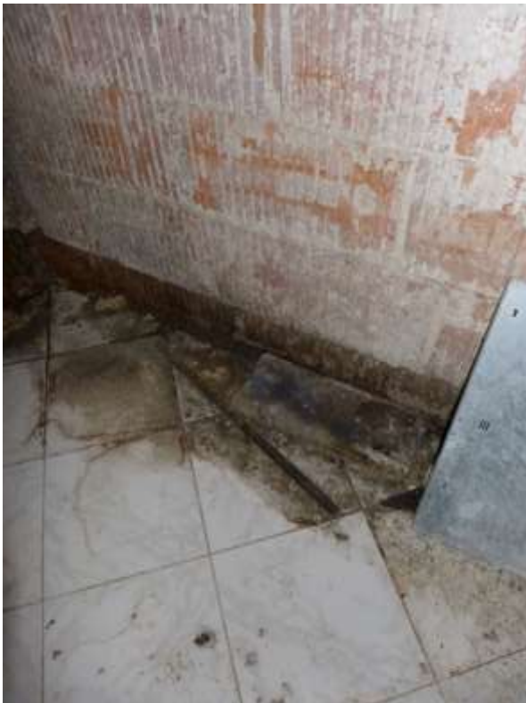
24 a Feuchteschäden Keller Wohnhaus B
