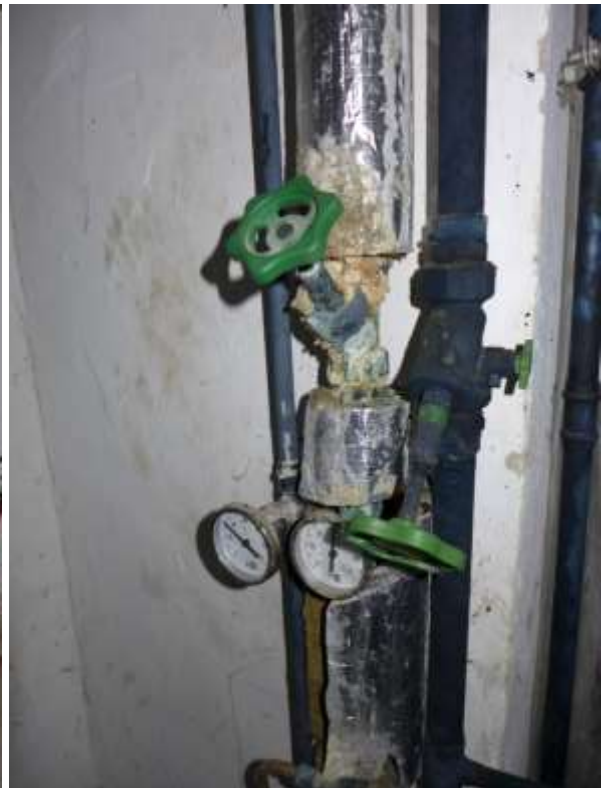
22 b Zustand Leitungen Wohnhaus B
