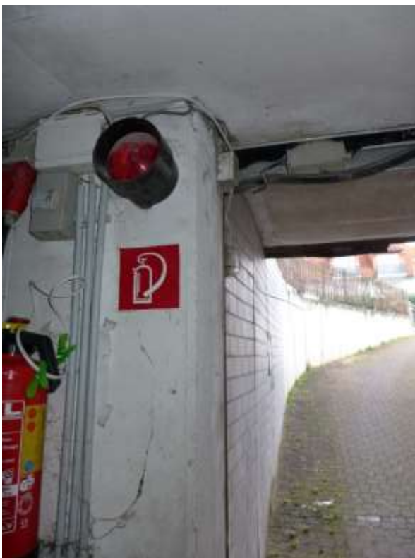
10 a Zustand Toreinfahrt
