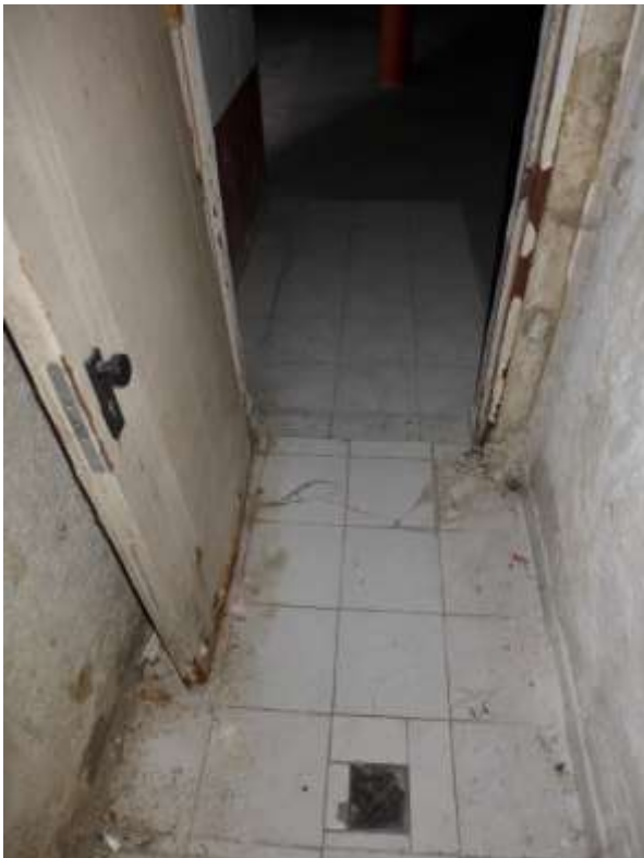
26 a Zustand Tiefgaragentür Wohnhaus B
