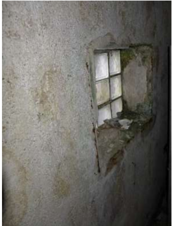
25 b Feuchteschäden Wohnhaus B
