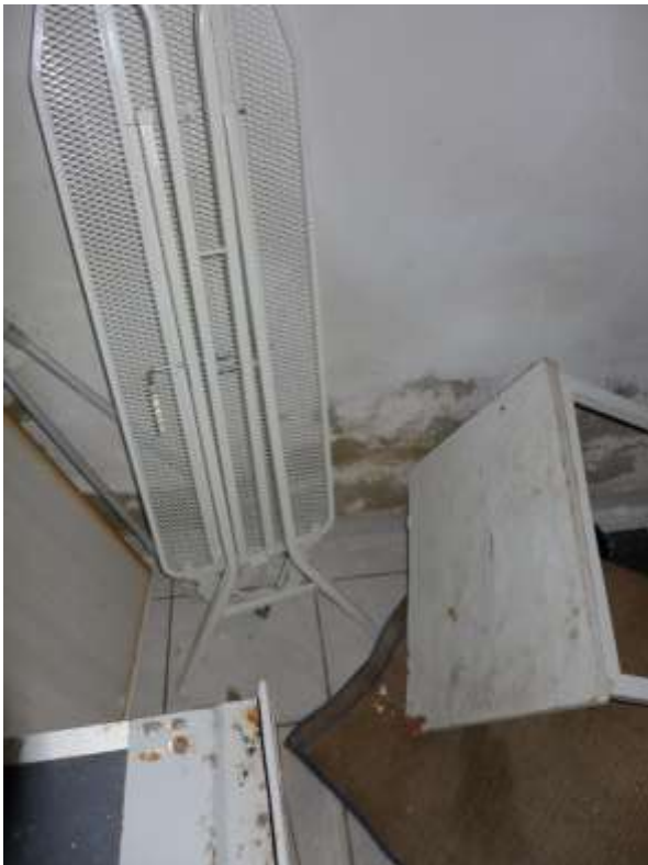
20 a Feuchteschäden Keller Wohnhaus A
