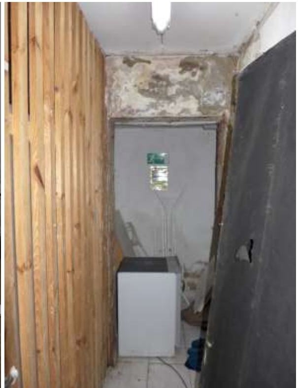
20 b Zustand Kellerflur Wohnhaus A
