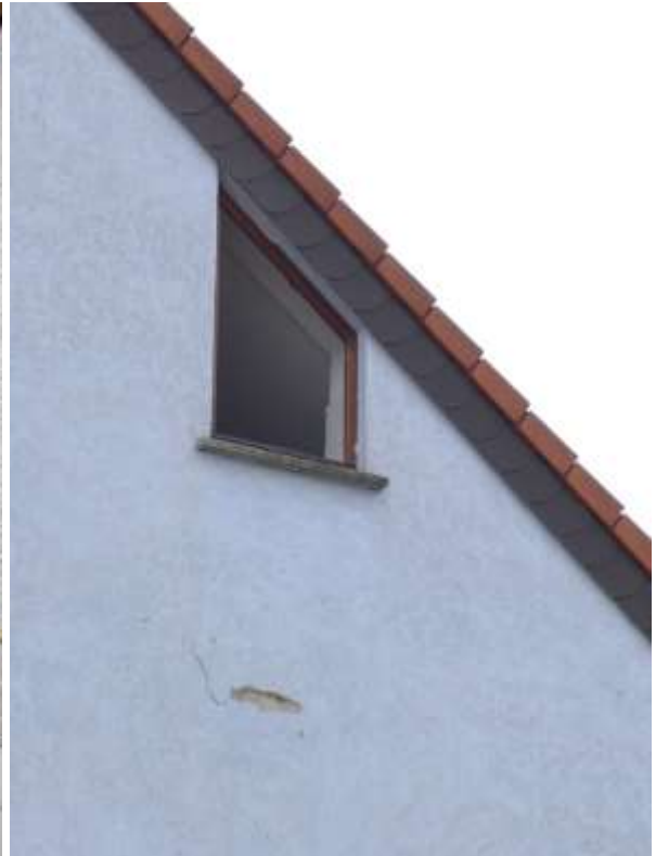
29 b Fassadenschäden Wohnhaus A
