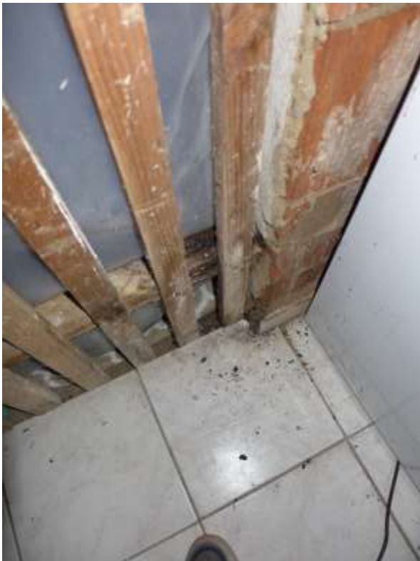
24 a Feuchteschäden Keller Wohnhaus A
