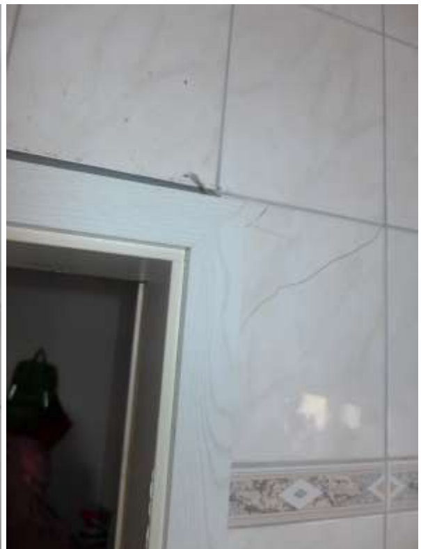
36 b schadhafte Wandfliesen Bad Whg. Nr. 8
