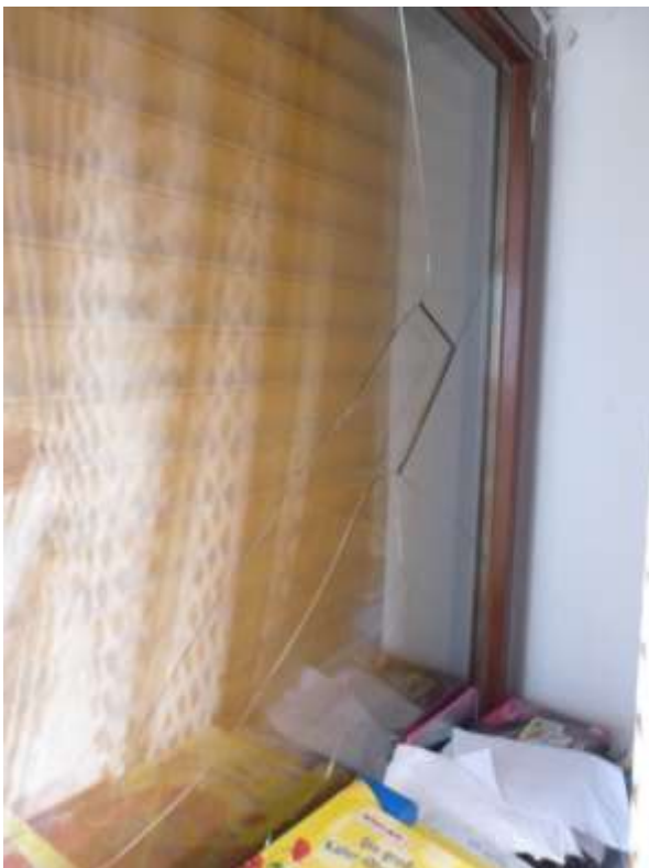
40 a schadhafte Glasscheibe Whg. Nr. 8
