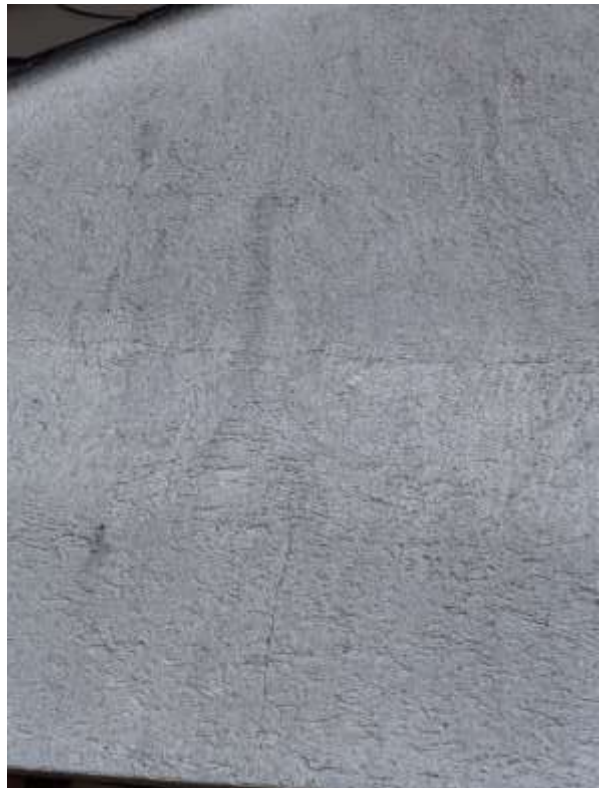
32 b schadhafter Putz Fassade Whg. Nr. 8
