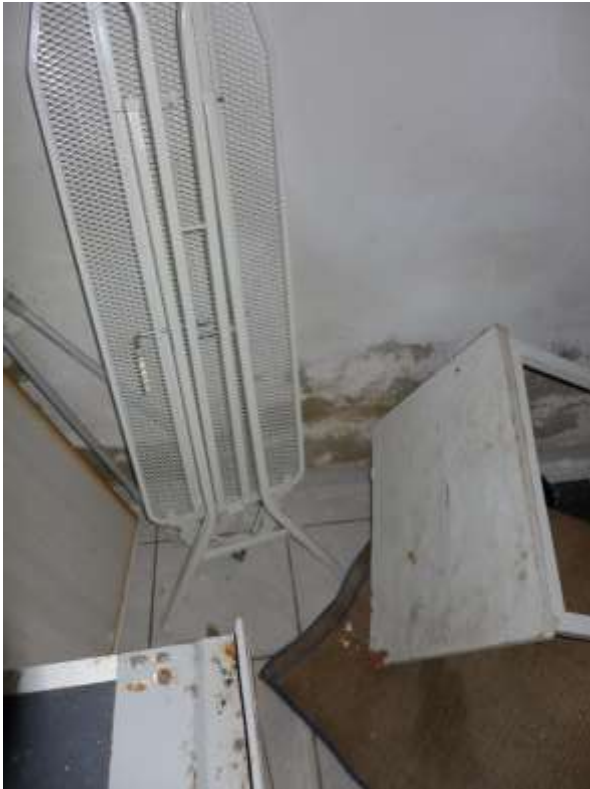
23 a Feuchteschäden Keller Wohnhaus A
