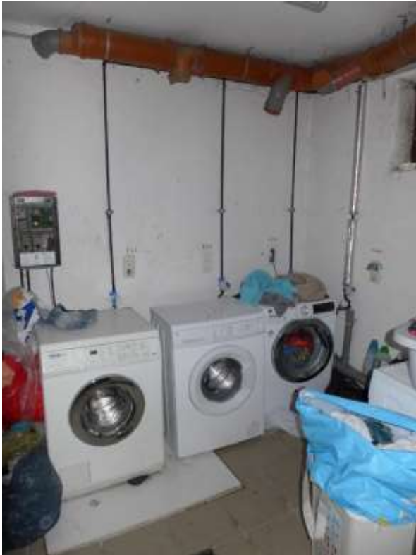
25 a Waschküche Keller Wohnhaus A
