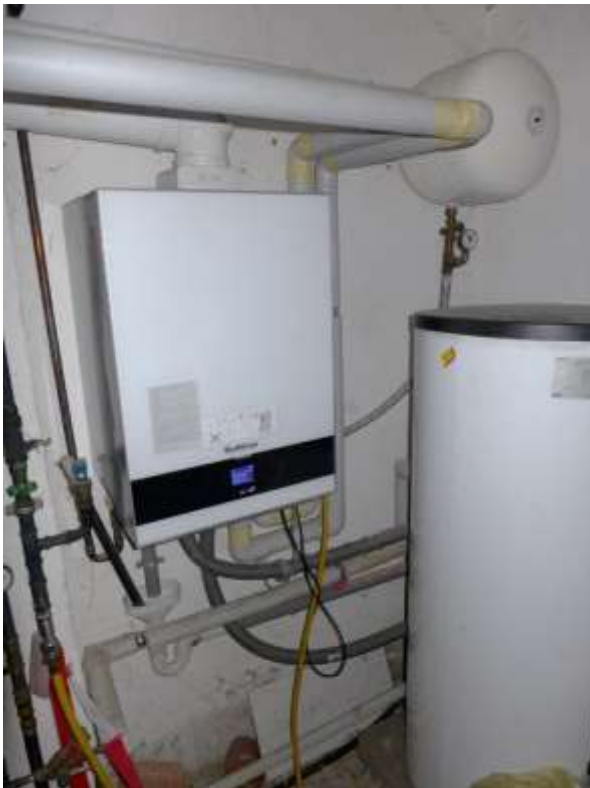
26 a Heizung Wohnhaus A
