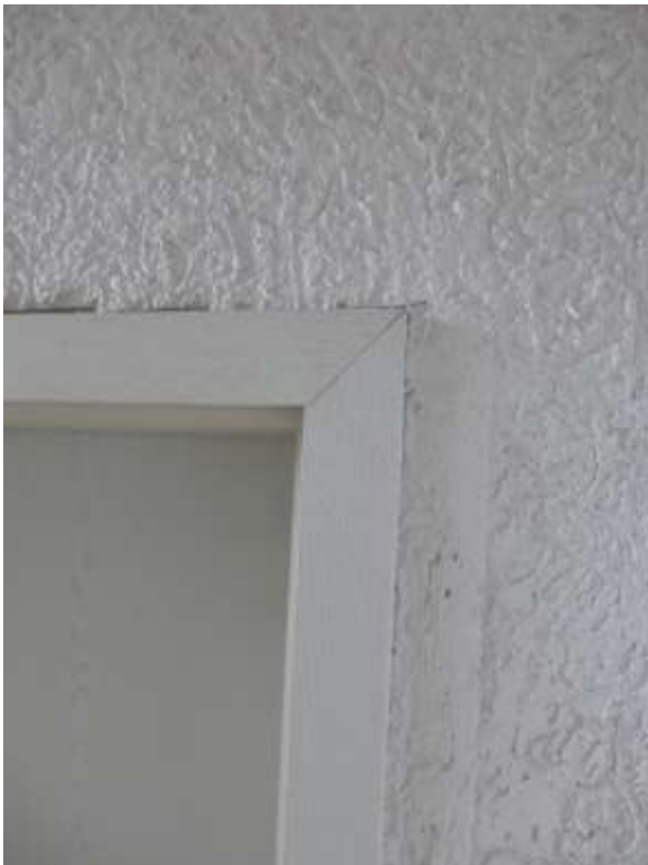
28 a mangelhafte Ausführung Wandputz
