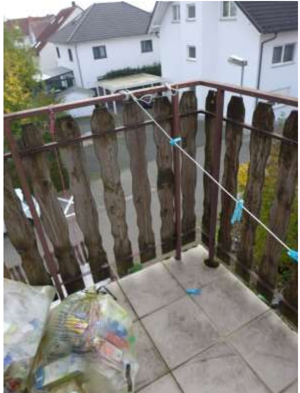
31 b Zustand Balkon Whg. Nr. 8
