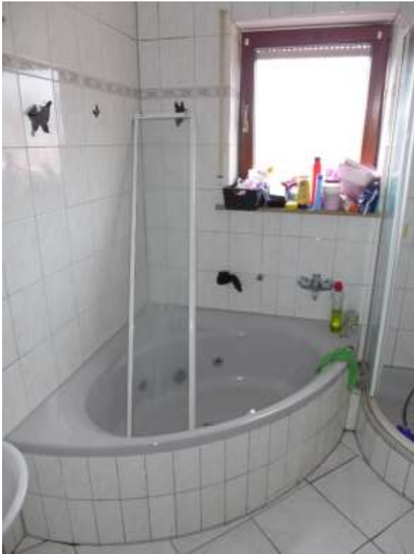
35 a Zustand Bad Whg. Nr. 8
