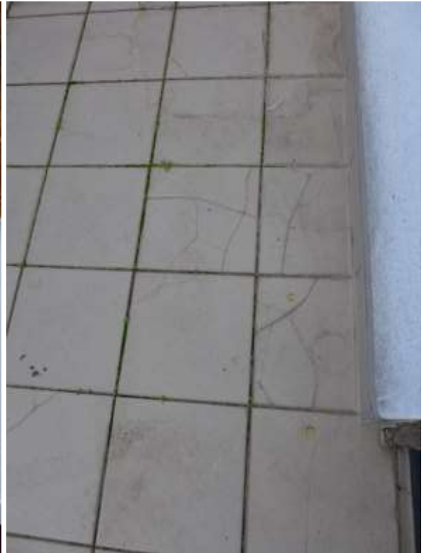
39 b defekte Fliesen Balkon Whg. Nr. 8
