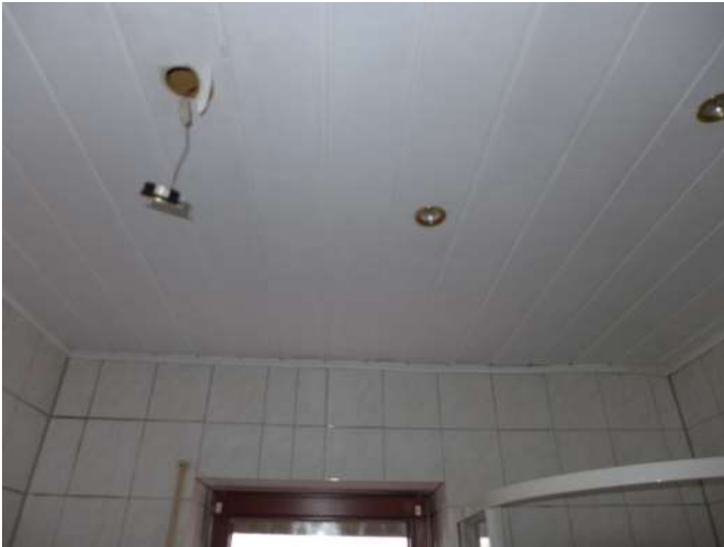
37 a schadhafte Paneelendecke Whg. Nr. 8
