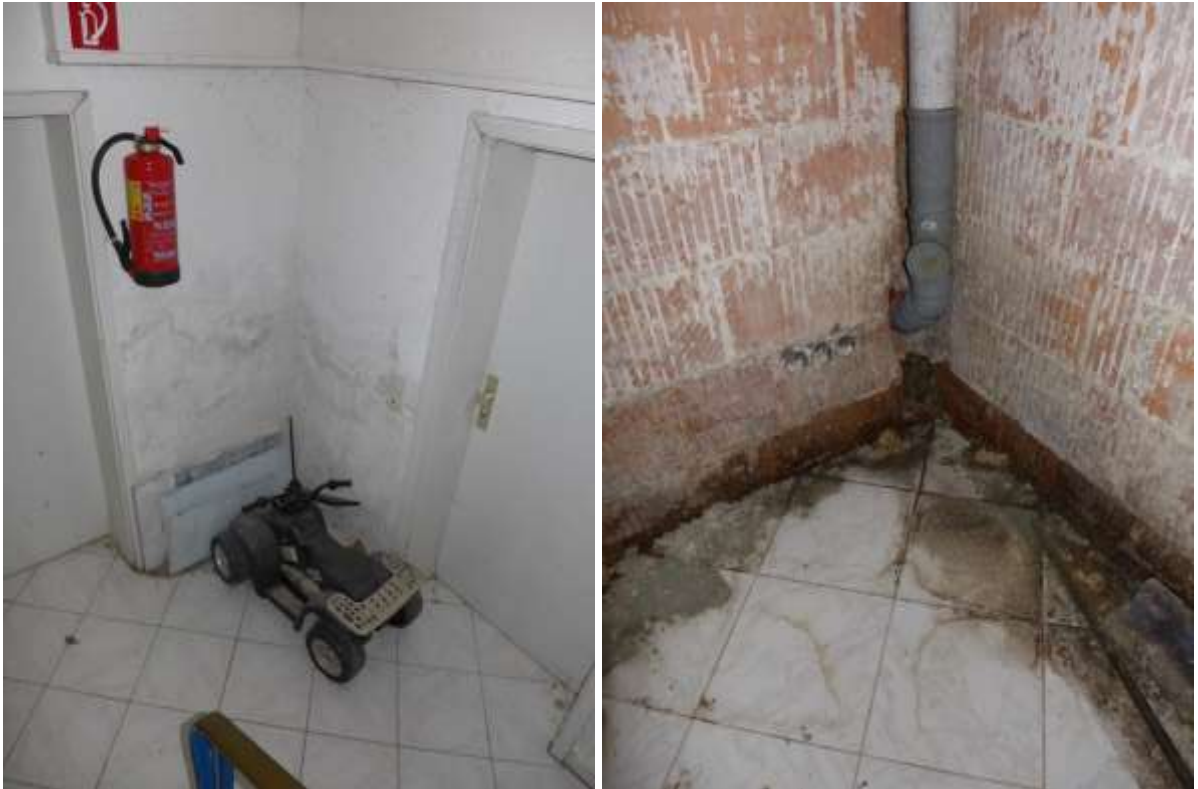
15 Feuchteschäden Kellergeschoss Wohnhaus B
