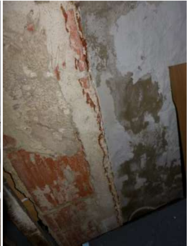
23 b Feuchteschäden Keller Wohnhaus A
