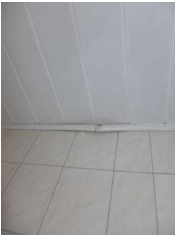
36 a schadhafte Paneelendecke Whg. Nr. 8
