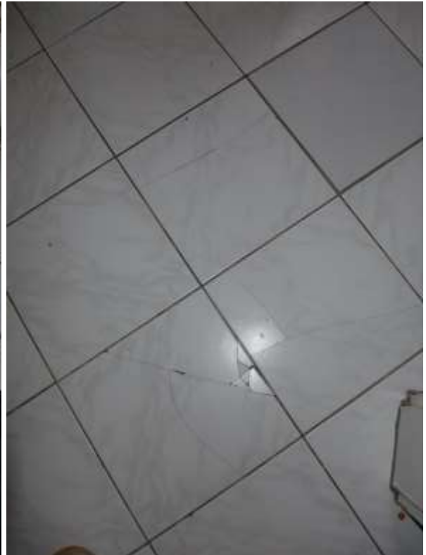
33 b schadhafte Fliesen Whg. Nr. 8
