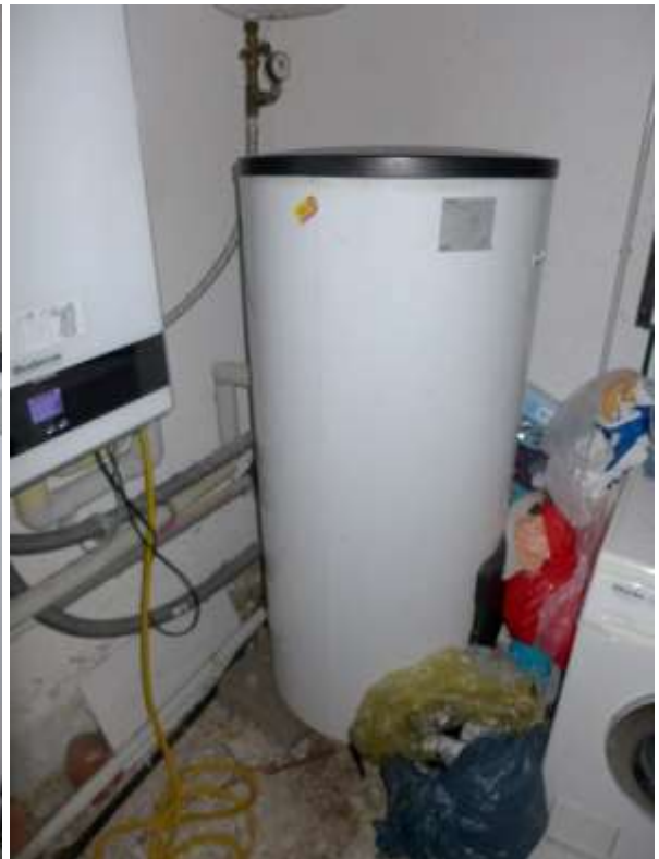
26 b Warmwasser Wohnhaus A
