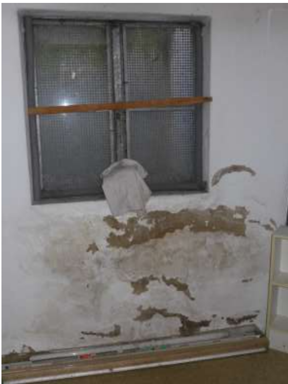
30 a Keller Neubau, Wandfeuchte
