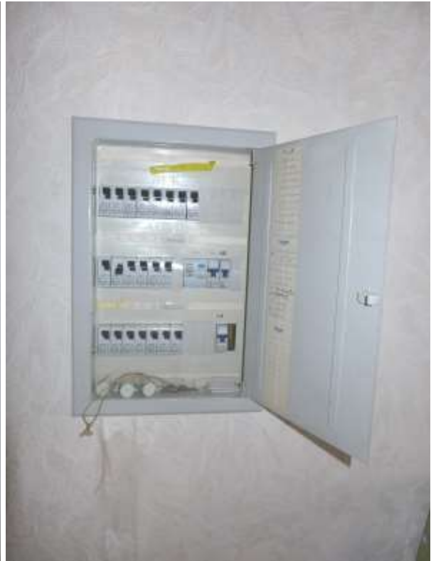
29 b Elektroverteilung Neubau
