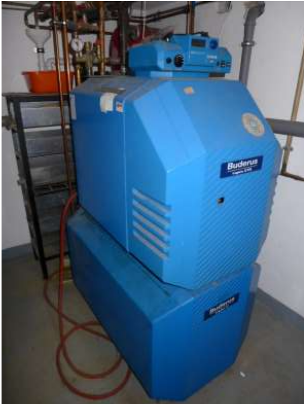
31 a Heizung Kellergeschoss
