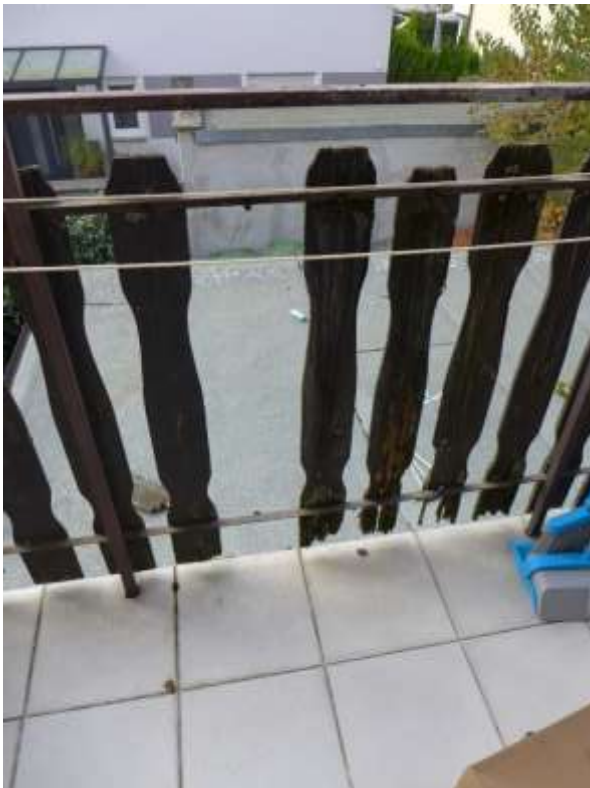
32 a schadhafter Balkon Whg. Nr. 6
