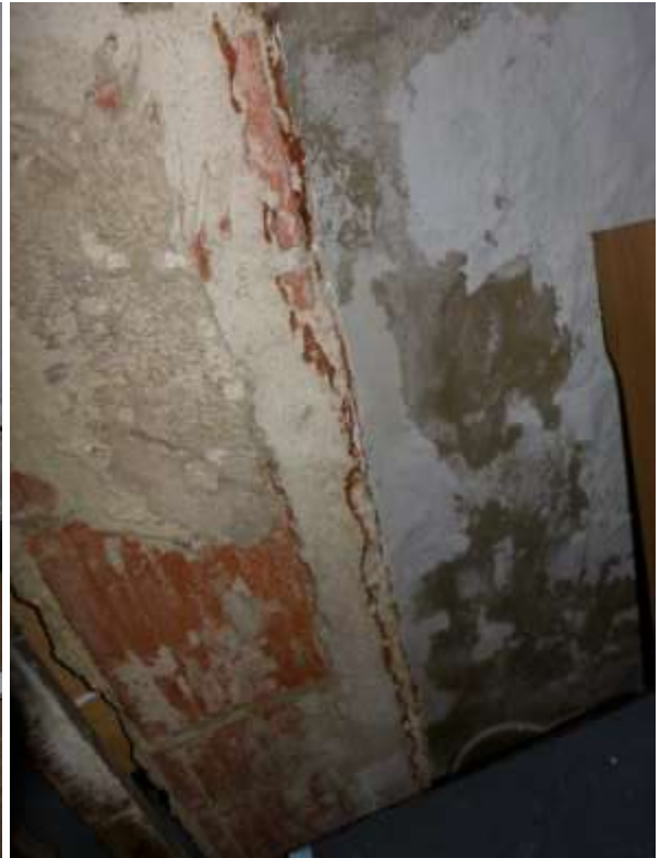
23 b Feuchteschäden Keller Wohnhaus A
