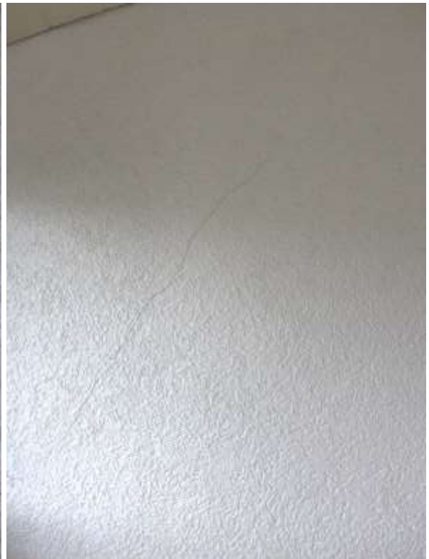
28 b Risse Treppenhaus Wohnhaus A
