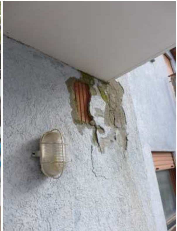
32 b schadhafter Putz Fassade Whg. Nr. 6
