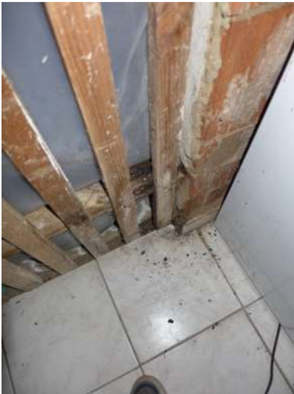
24 a Feuchteschäden Keller Wohnhaus A
