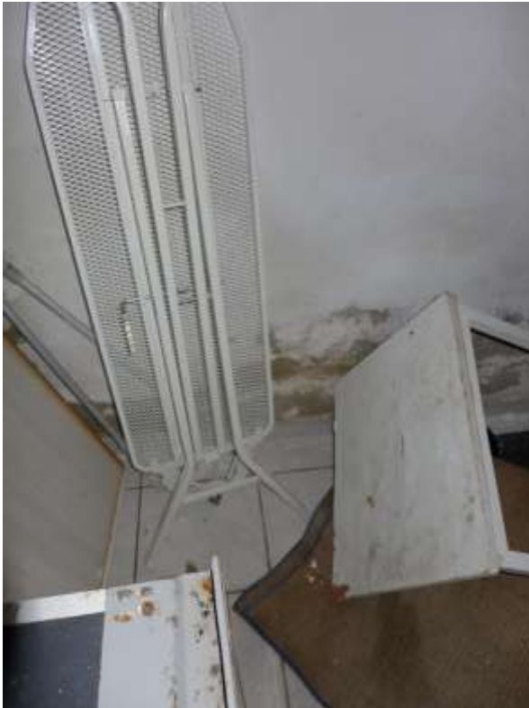
23 a Feuchteschäden Keller Wohnhaus A
