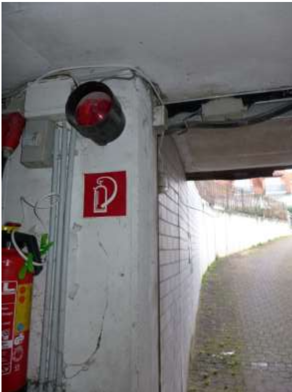
10 a Zustand Toreinfahrt
