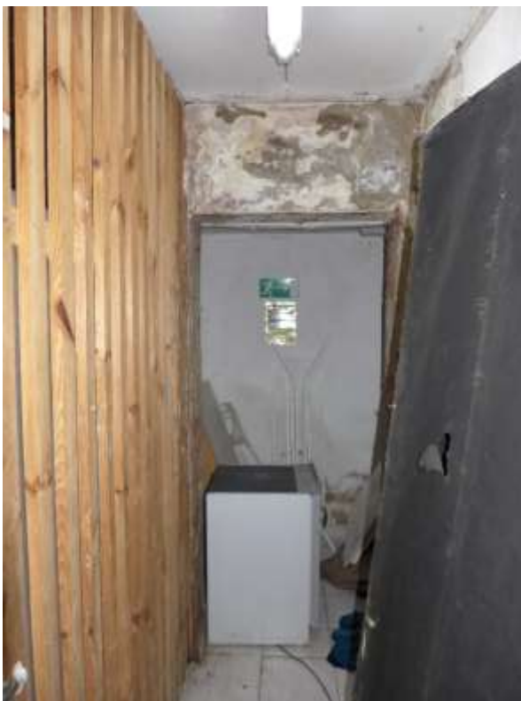
22 a Zustand Kellerflur Wohnhaus A
