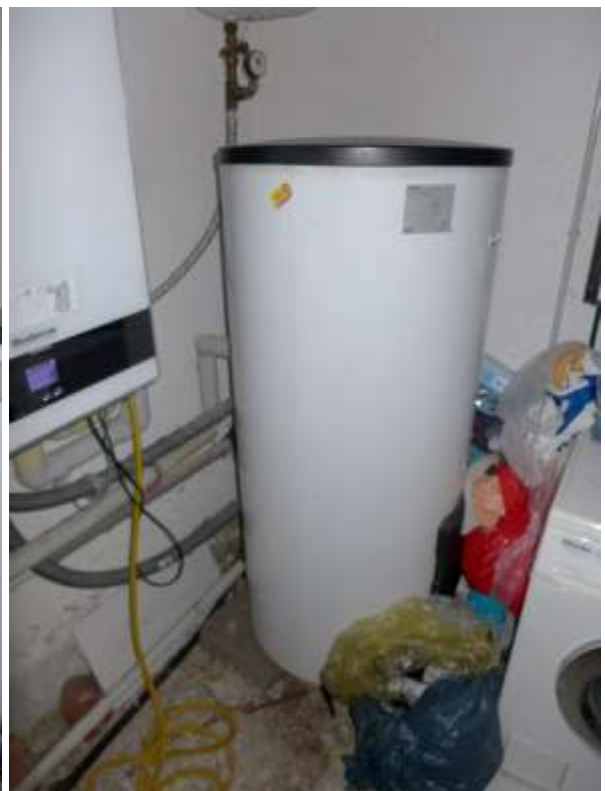
26 b Warmwasser Wohnhaus A
