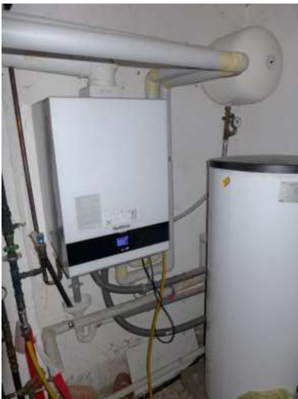
26 a Heizung Wohnhaus A
