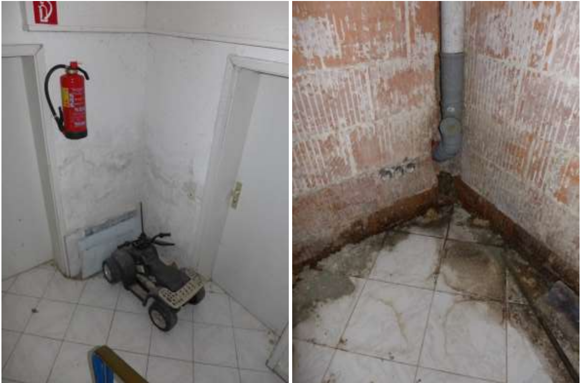
15 Feuchteschäden Kellergeschoss Wohnhaus B
