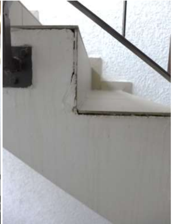
27 b Mängel Treppe Wohnhaus A
