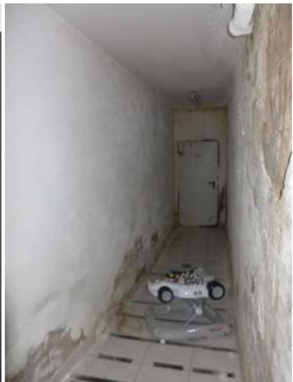
22 b Zustand Kellerflur zur TG Wohnhaus A
