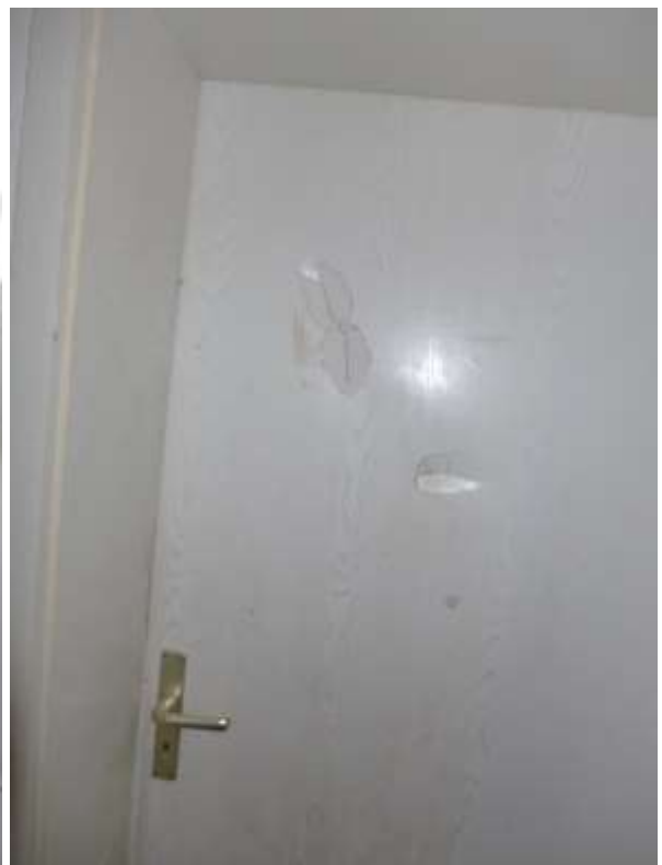
36 b beschädigte Innentüren Whg. Nr. 1
