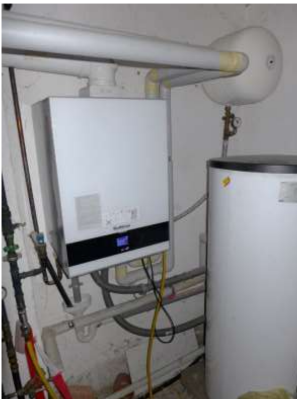
26 a Heizung Wohnhaus A
