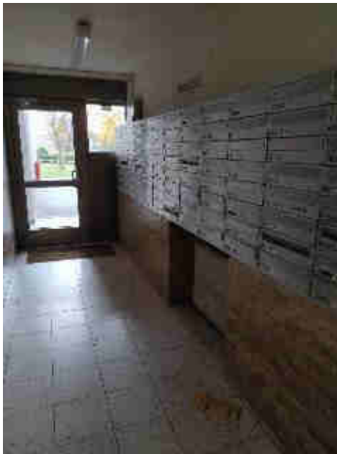
Bild 9: Briefkastenanlage im Eingangsflur
