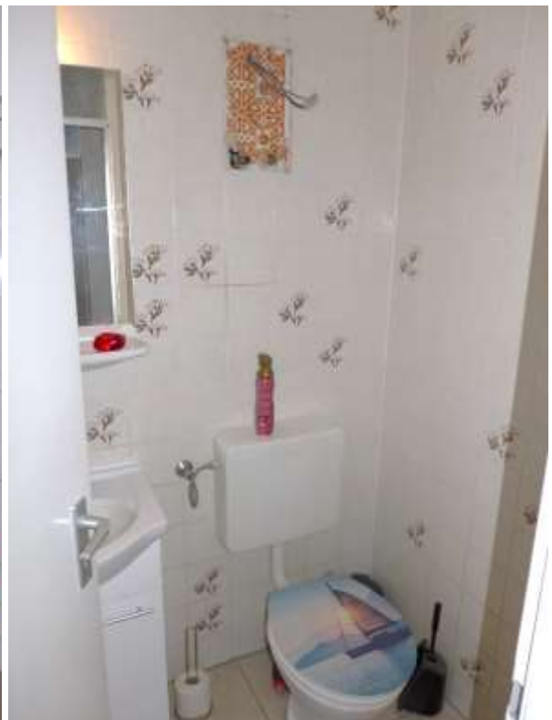
16 b WC, fehlender Durchlauferhitzer
