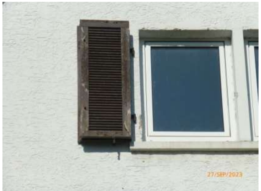
Fensterladen mit Unterhaltungsstau
