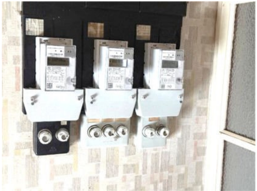
Abb. 9: Foto des SV; haustechnische Installationen überaltert
