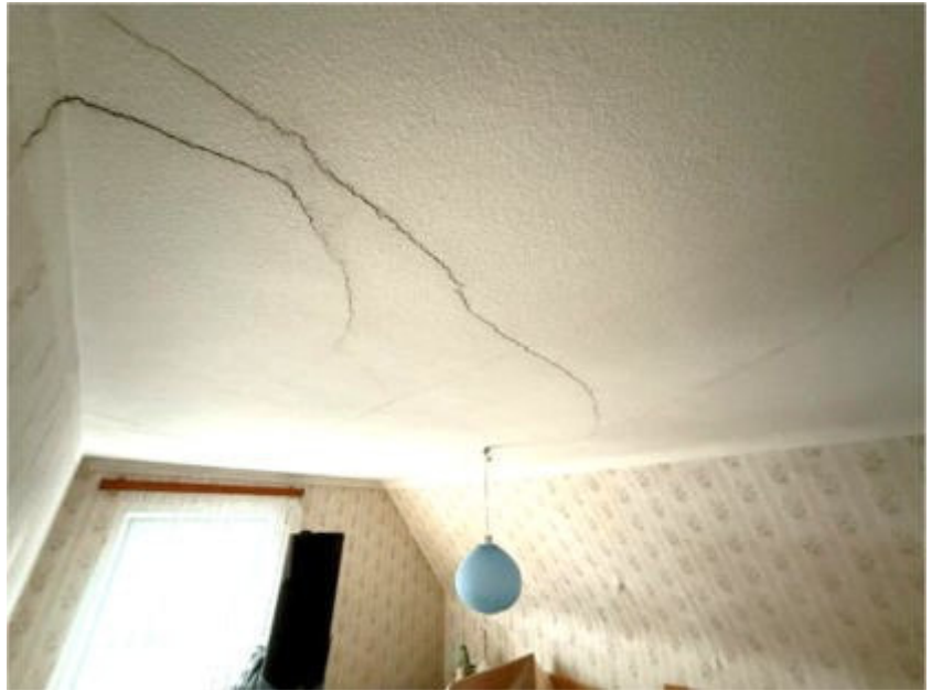
Abb. 5: Foto des SV; Wand-/Deckenbekleidungen überaltert/schadhaft (DG)
