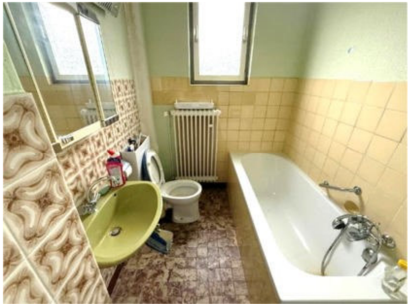
Abb. 7: Foto des SV; Sanitärobjekte überaltert/verbraucht, Boden- und Wandbeläge überaltert (EG)
