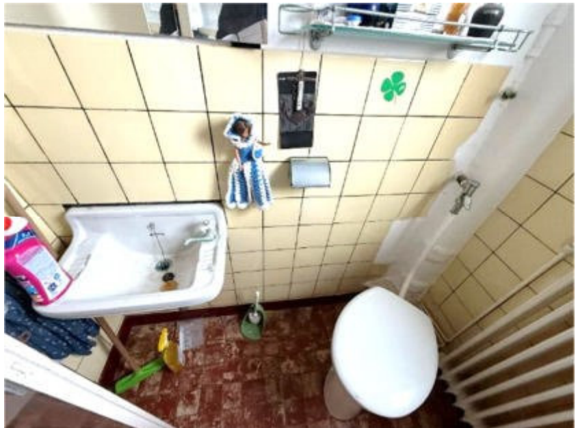
Abb. 6: Foto des SV; Sanitäröbekte überaltert/verbraucht, Boden- und Wandbeläge überaltert (OG)
