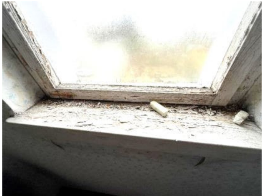
Abb. 3: Foto des SV; Fenster schadhaft (DG)
