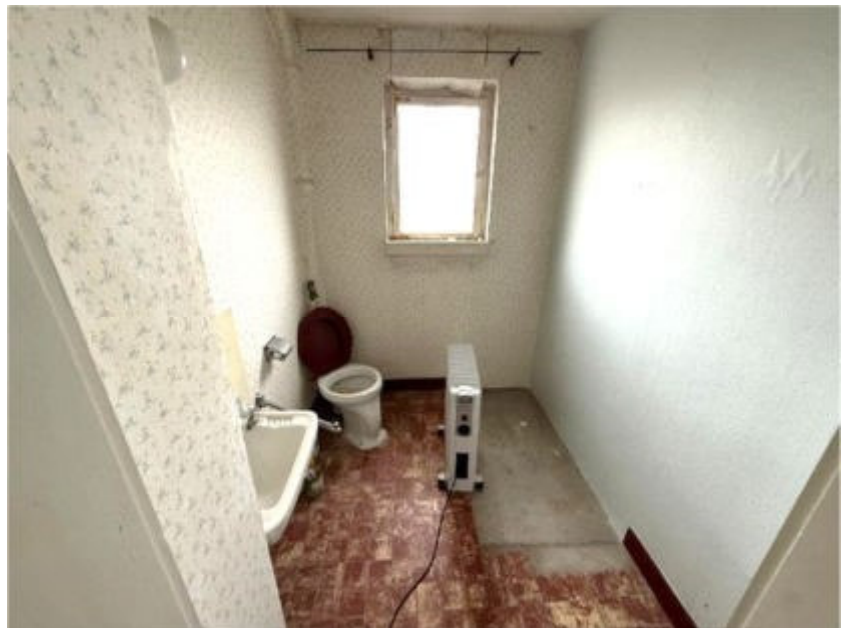
Abb. 8: Foto des SV; Sanitärobjekte überaltert/verbraucht, Boden- und Wandbeläge schadhaft (DG)
