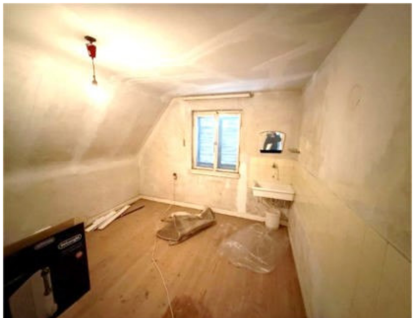
Abb. 4: Foto des SV; Wand-/Deckenbekleidungen überaltert/ schadhaft/ fehlend (DG)
