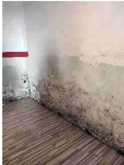
Bild 10: Zimmer im UG mit Schimmelbefall
