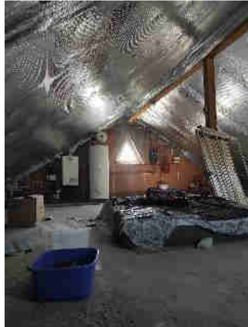
Bild 18: Heizungsanlage im Speicherraum
