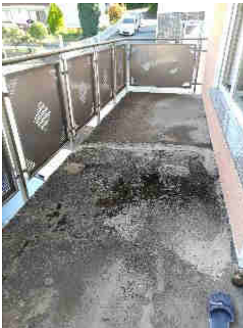
Bild 11: fehlender Balkonbelag im EG und OG
