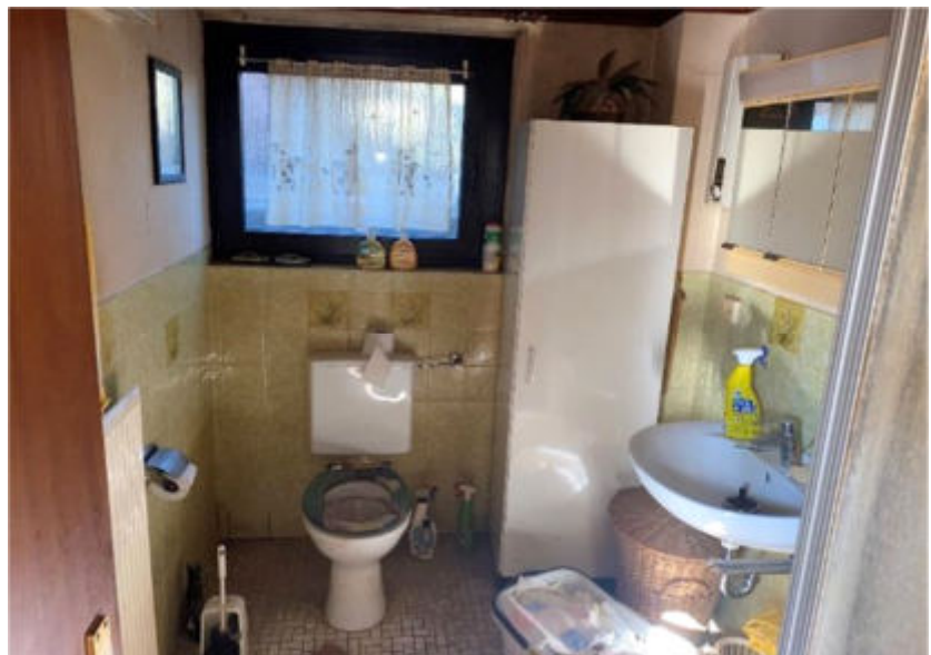
Abb. 3: Foto des SV; Duschbad UG, Sanitärobjekte und Raumbooberflächen überaltert
