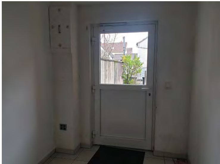
Hauseingangsbereich mit Hauseingangstür und Rissbildungen im Mauerwerk (Gemeinschaftseigentum)
