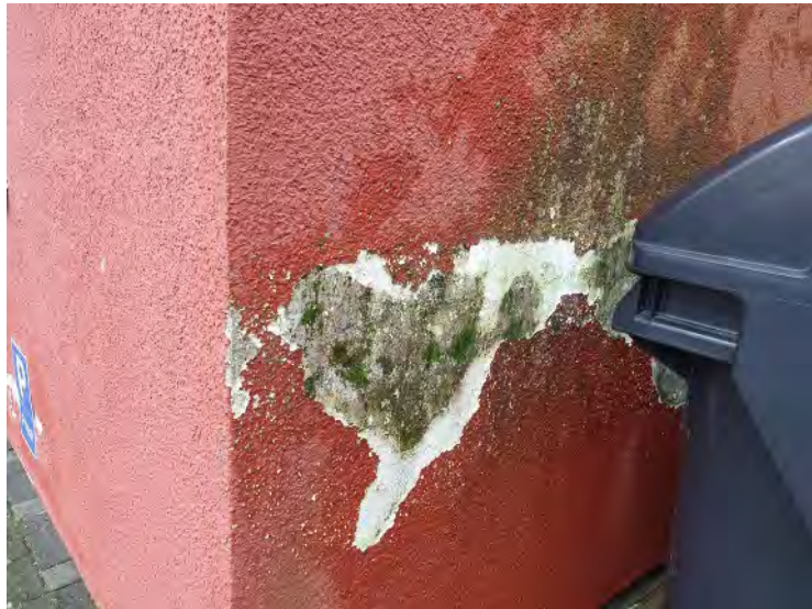
Putzabplatzungen mit Schimmelflechte an der Fassade (Gemeinschaftseigentum)
