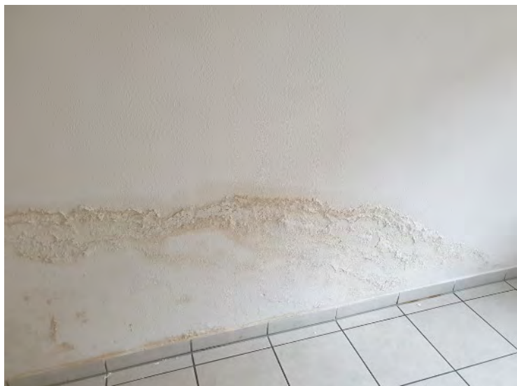
Großflächige Feuchteschäden im Hauseingangsbereich (Gemeinschaftseigentum)
