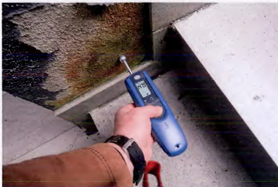
Abb. 56: 147,9 Digits Wandfeuchte oberhalb des Sockels (= nass)
