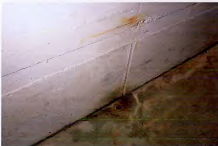
Abb. 70: Feuchtedurchtritt im Arbeitsfugenstoß der Kelleraußenwand der Schwimmbads
