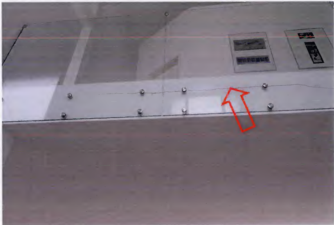
Abb. 41: Horizontalriss in der Deckenstirnseite der DG-Galerie
