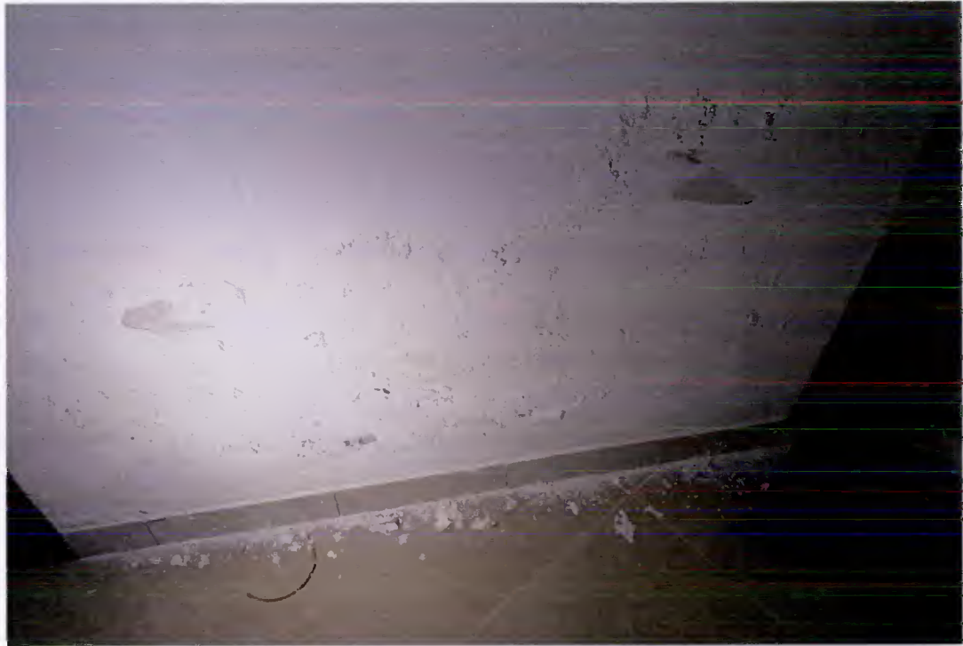
Abb. 46: Putz- und Farbablösungen auf der Wandoberfläche im Keller
