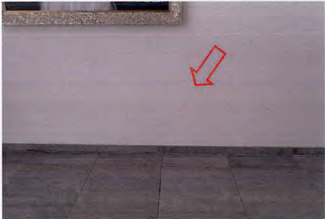
Abb. 21: Feuchteränder auf dem Putz im Wohnzimmer weisen auf aufsteigende Feuchte hin
