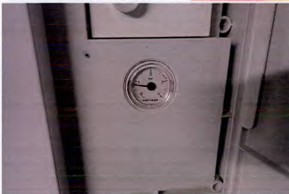
Abb. 15: auf unter 1 bar abgesunkener Wasserdruck im Heizkreislaufsystem
