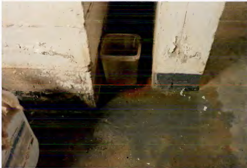
Abb. 68: Feuchtemängel im Übergang Boden zur Beckenwand u. Pfeiler
