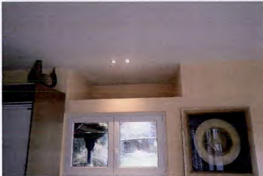
Abb. 62: Nische über dem Fenster der südlichen Schwimmbadwand m. Feuchteflecken
