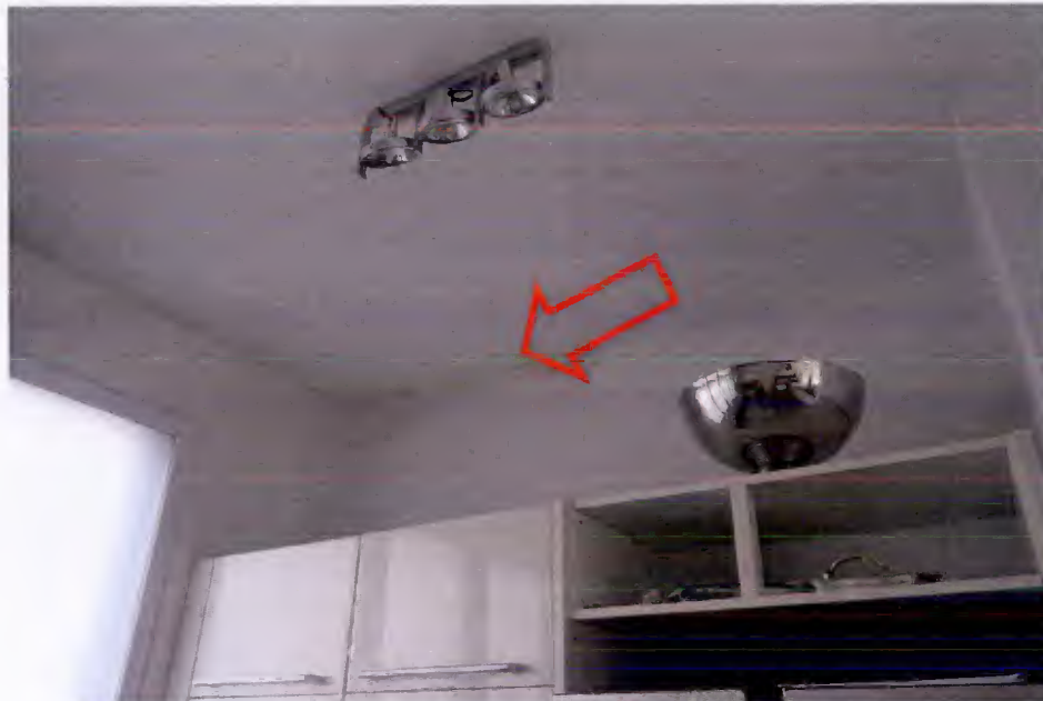
Abb. 16: Feuchte- und Schimmelflecke an der Küchenaußenwand u. Decke
