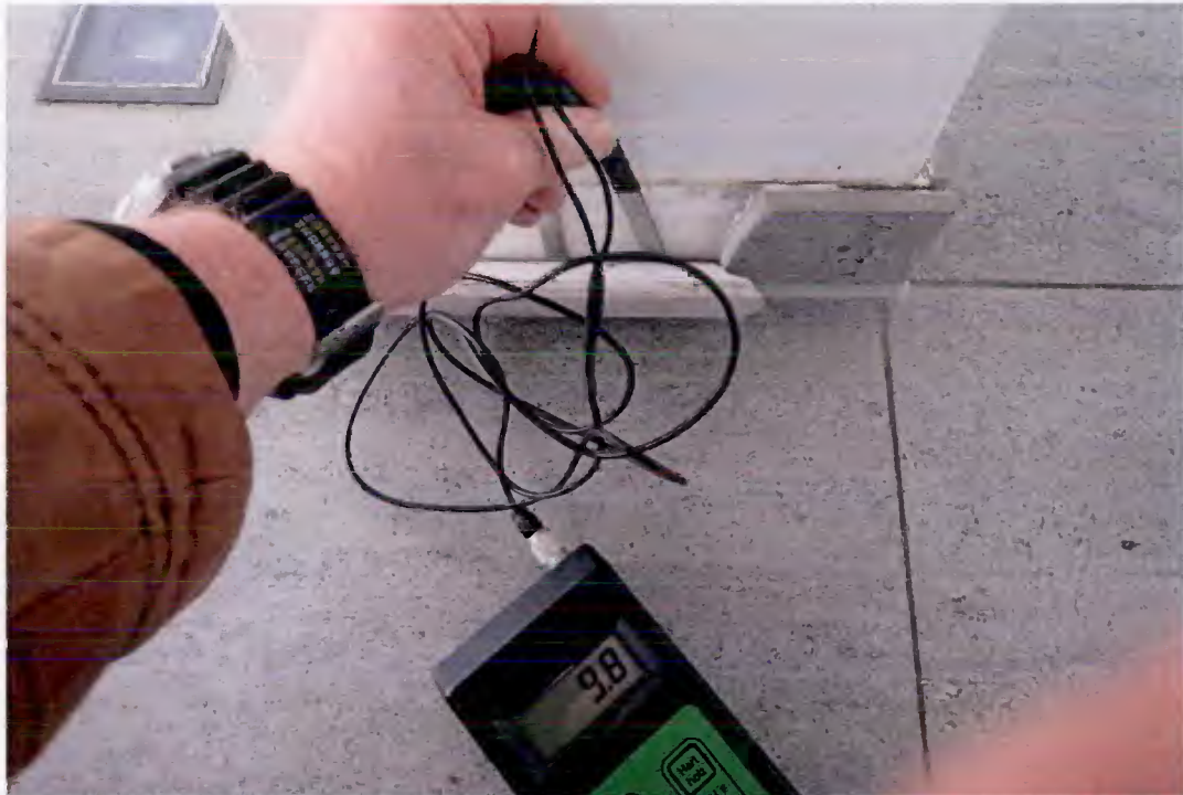
Abb. 39: 9,8 Digits Putzfeuchte am Wohnzimmerfeiler
