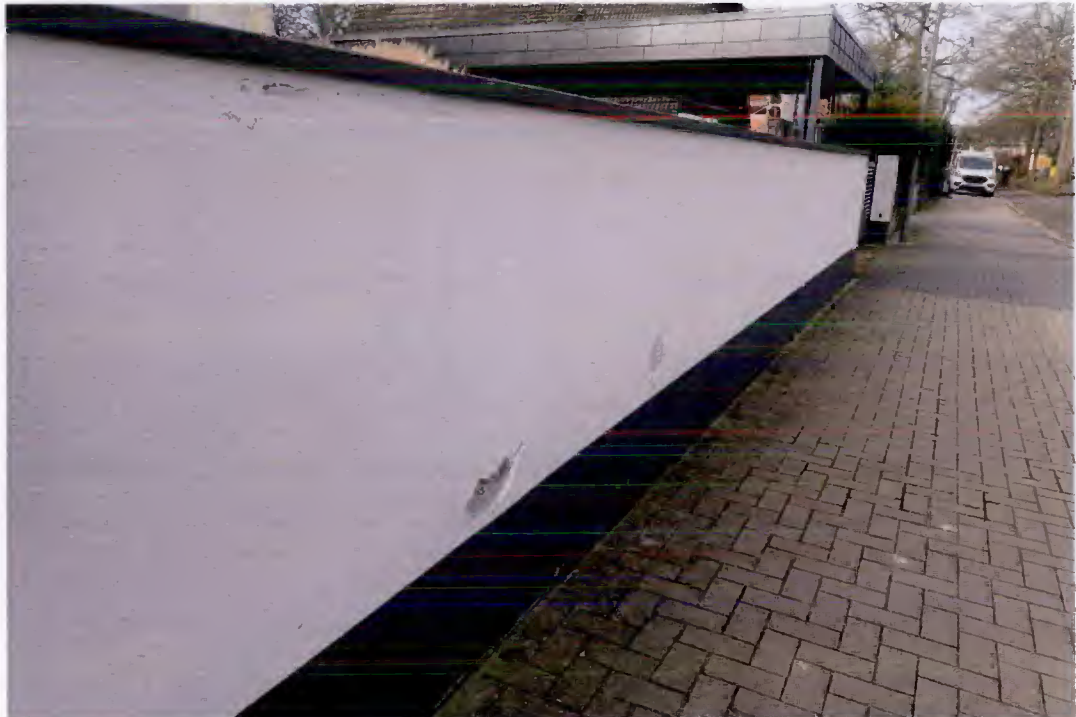
Abb. 56: Putzschäden an der Einfriedungsmauer unterhalb der Abdeckung u. am Sockel
