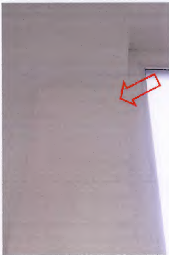
Abb. 17: Feuchteflecke im Übergang Wand zur Dachschräge
