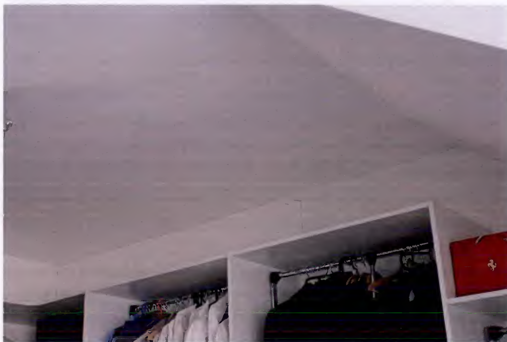
Abb. 33: Riss in der verputzten Giebelwand in der Ankleide sowie zur Decke/Wand
