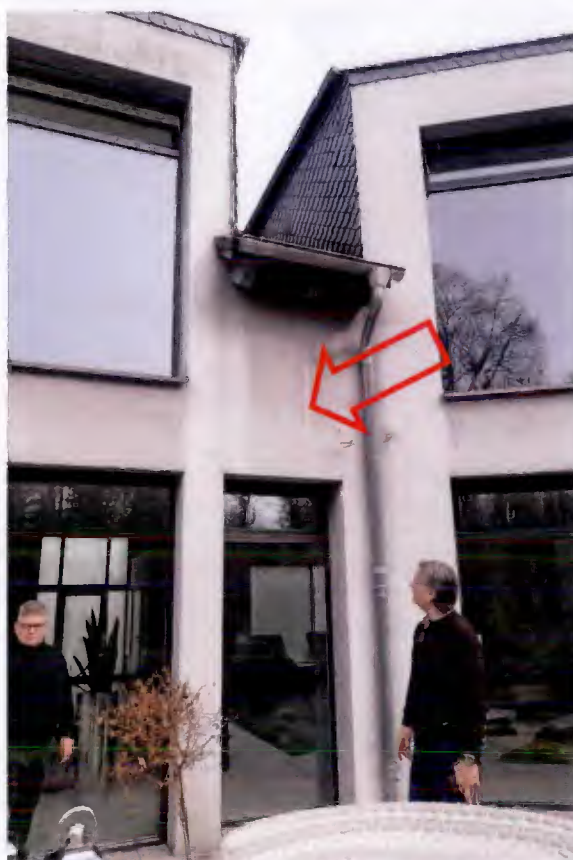
Abb. 10: Ablaufspuren unterhalb der Sparren
