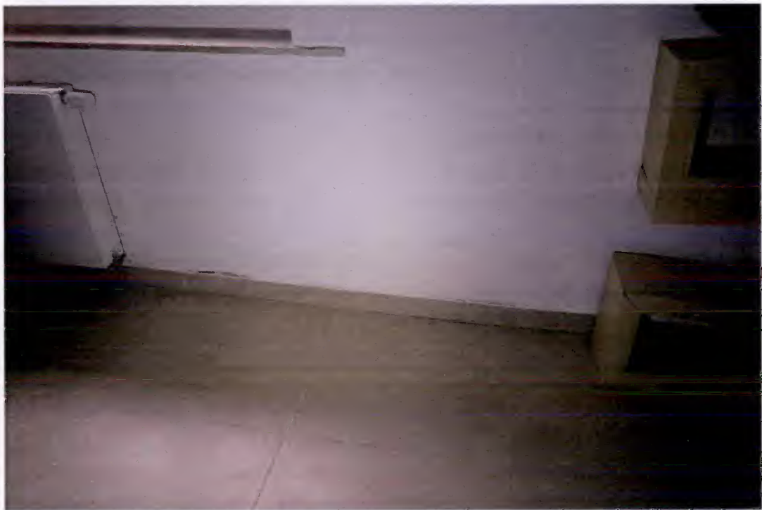
Abb. 47: Feuchteflecke auf der straßenseitigen Kelleraußenwand
