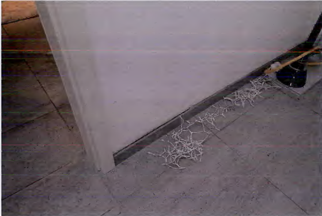
Abb. 34: Wand-Feuchteflecke u. abgelöste Sockelfliesen an der Galerietrennwand zu den Schlafräumen
