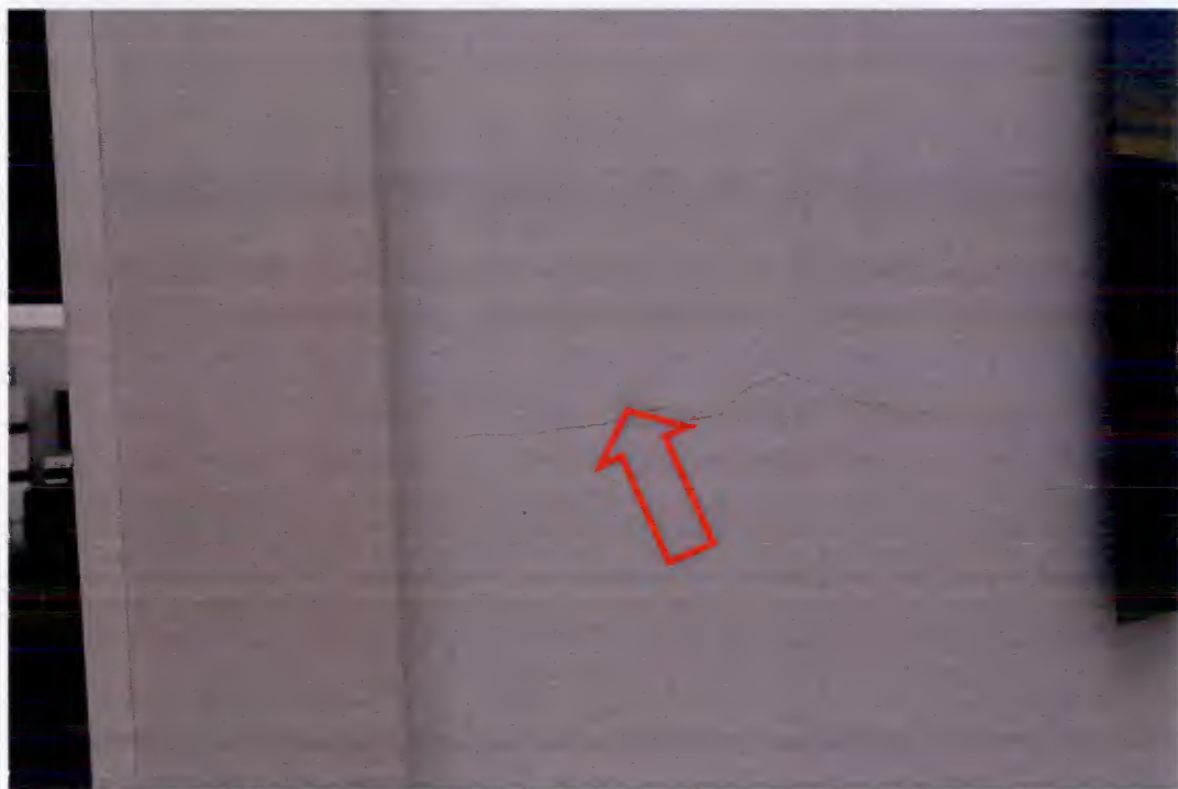
Abb. 38: Horizontalriss im Sichtputz
