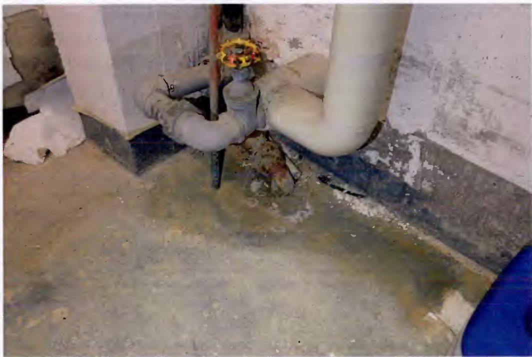
Abb. 72: Feuchteflecke auf dem Boden sowie veraltete Rohrleitungen u. Schieber
