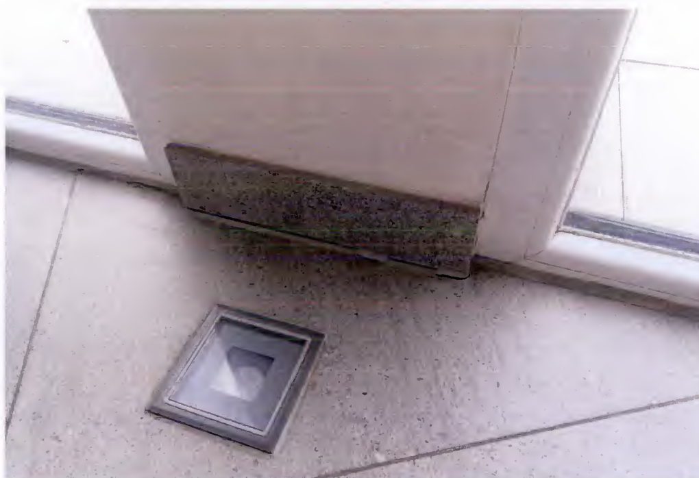
Abb. 23: abgerissene Silikonfuge und Feuchtflecke am Innenputz des Fensterpfeilers
