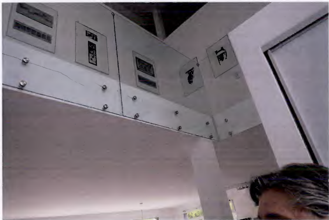
Abb. 42: Horizontalriss in der Deckenstirnseite des Galerieumgangs
