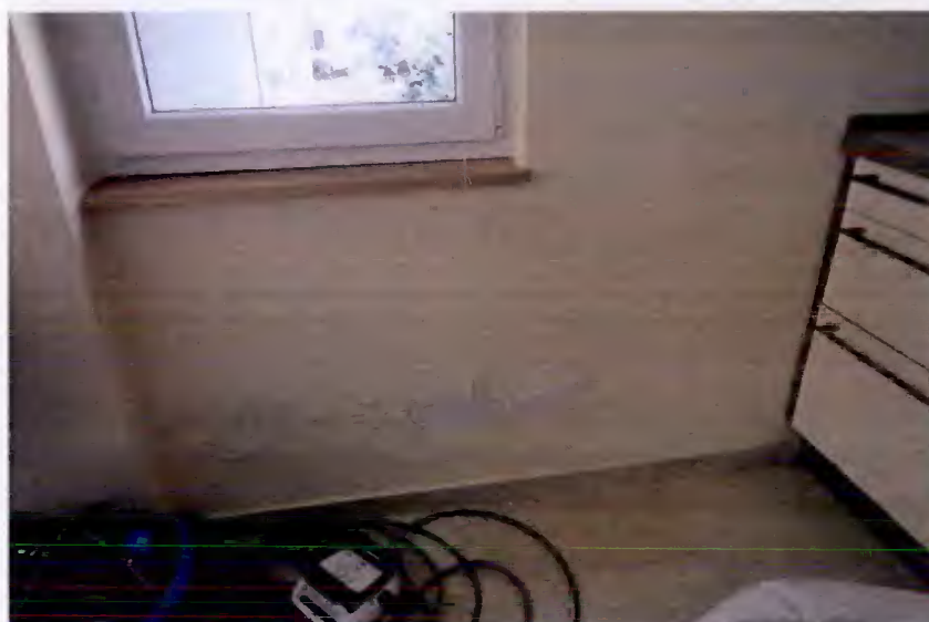
Abb. 63: Feuchteflecke u. Ausblühungen im Treppenabgangsbereich
