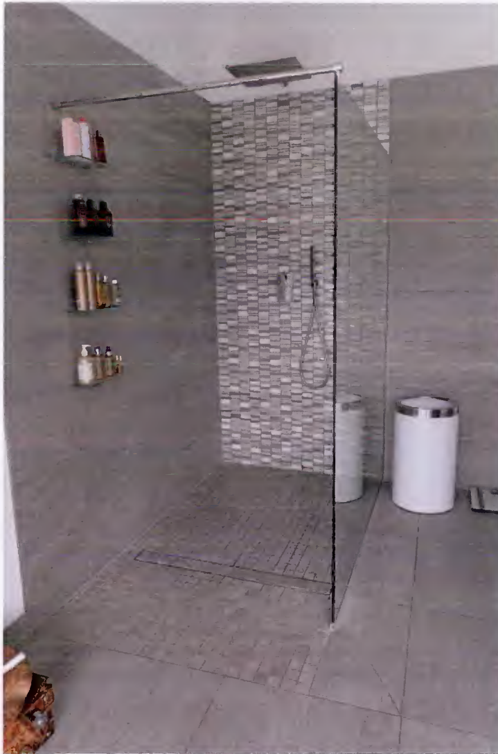
Abb. 29: geflieste offene Dusche im DG-Bad mit wahrscheinlich nicht fachgerechter Abdichtung
