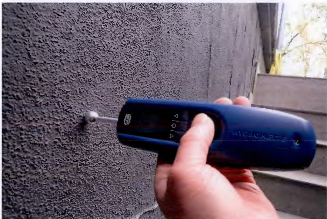
Abb. 53: 90,2 Digits auf dem Wandputz des Kellerabgangs (= stark feucht)
