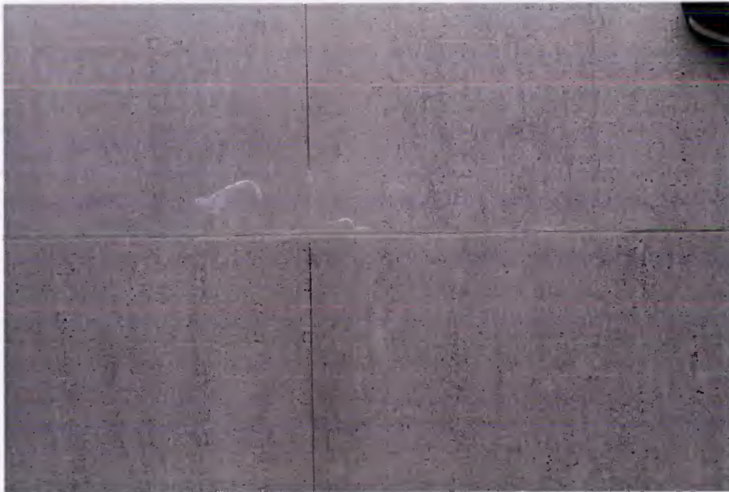
Abb. 19: Ausblühungen in den Fliesenfugen des Wohnzimmers deuten auf Feuchte hin
