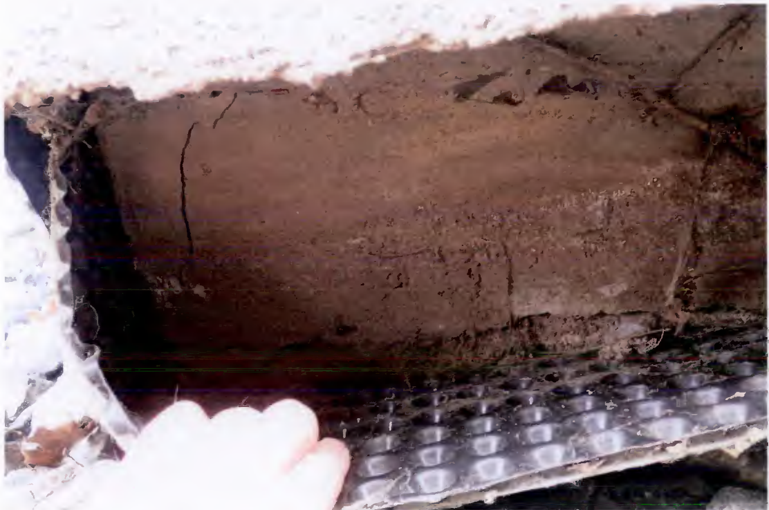
Abb. 13: nicht abgedichteter Gebäudesockel aus Mauerwerk
