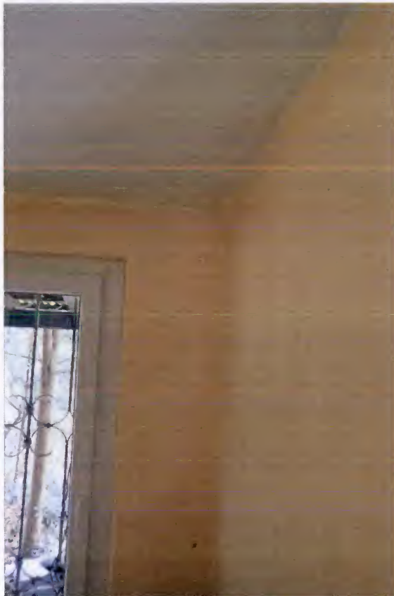
Abb. 64: Feuchteflecke in der Schwimmbadecke
