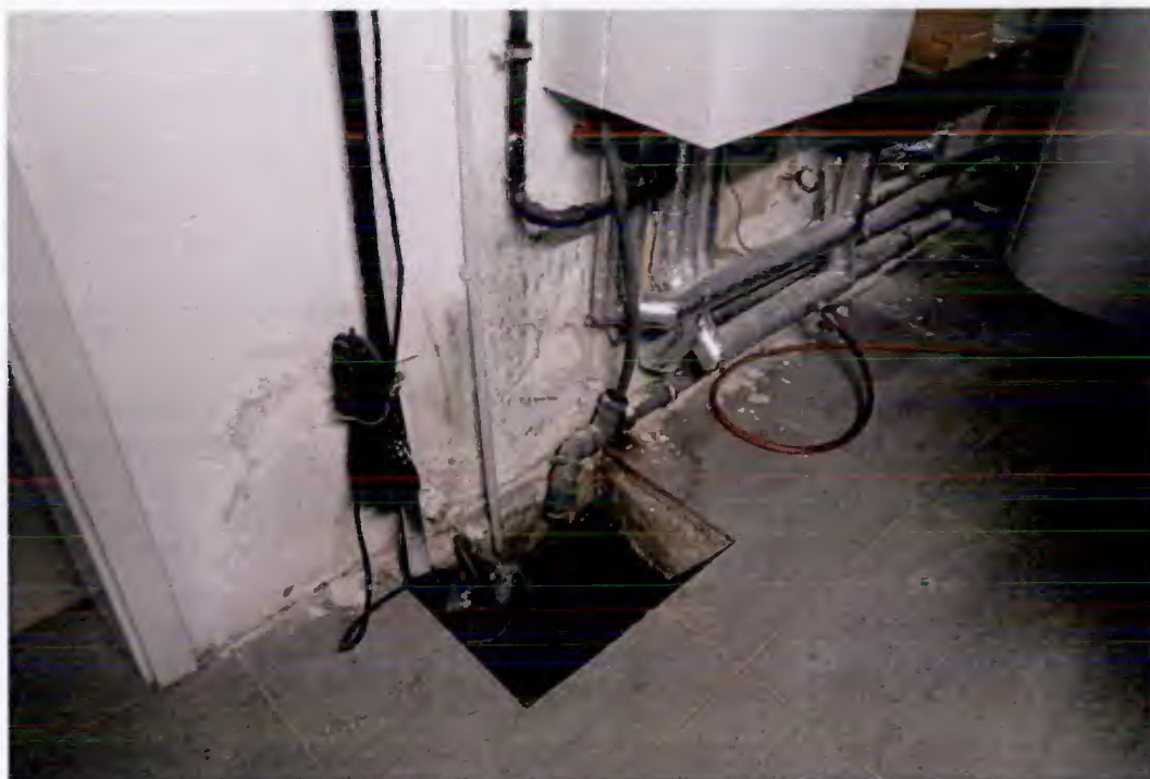
Abb. 50: nicht ausreichender Pumpensumpf unterhalb der Brennwerttherme
