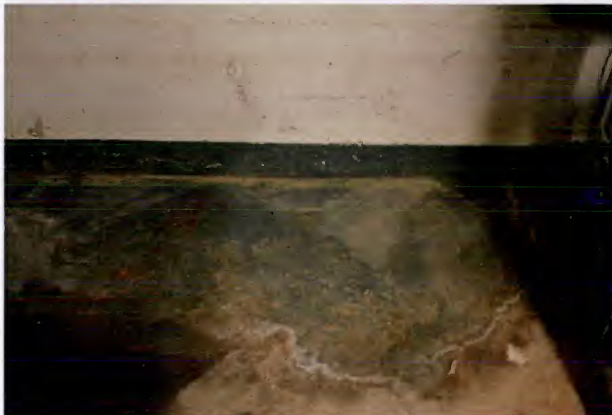
Abb. 69: Feuchteränder an Wand und Boden
