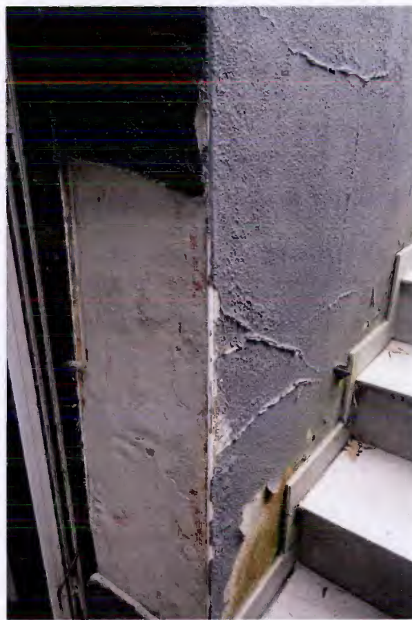
Abb. 55: abgelöster Wandputz im Kellerabgang
