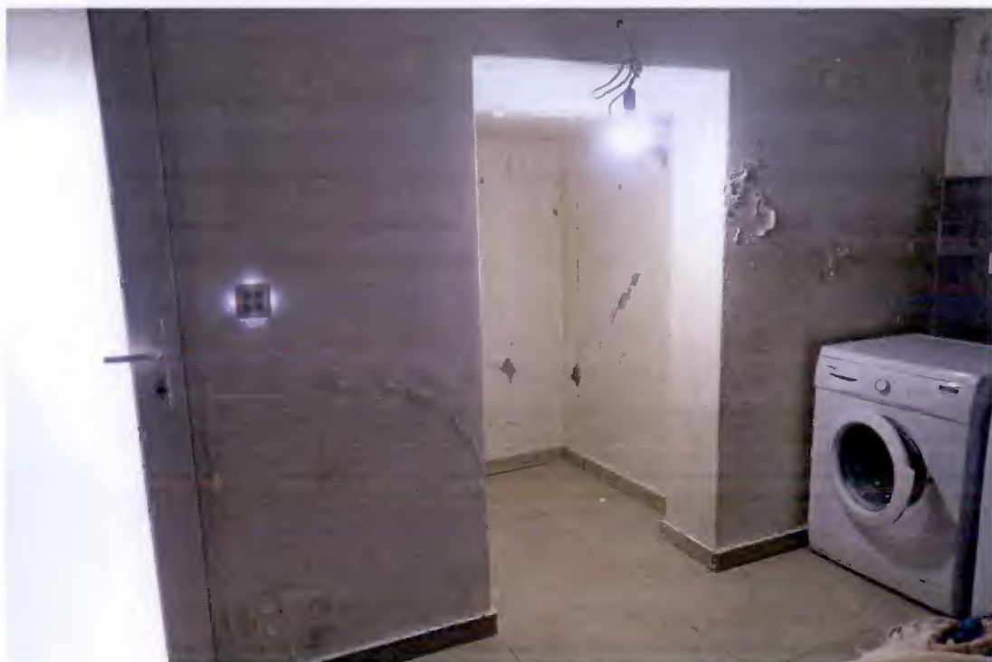
Abb. 49: Feuchteflecke und Ausblühungen bis zur Decke im Wasch- u. Trockenraum
