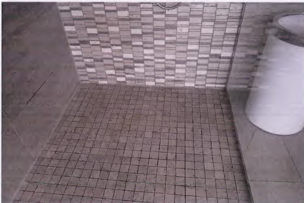
Abb. 30: abgerissene Dichtstofffugen im Übergang Boden-/Wandfliesen
