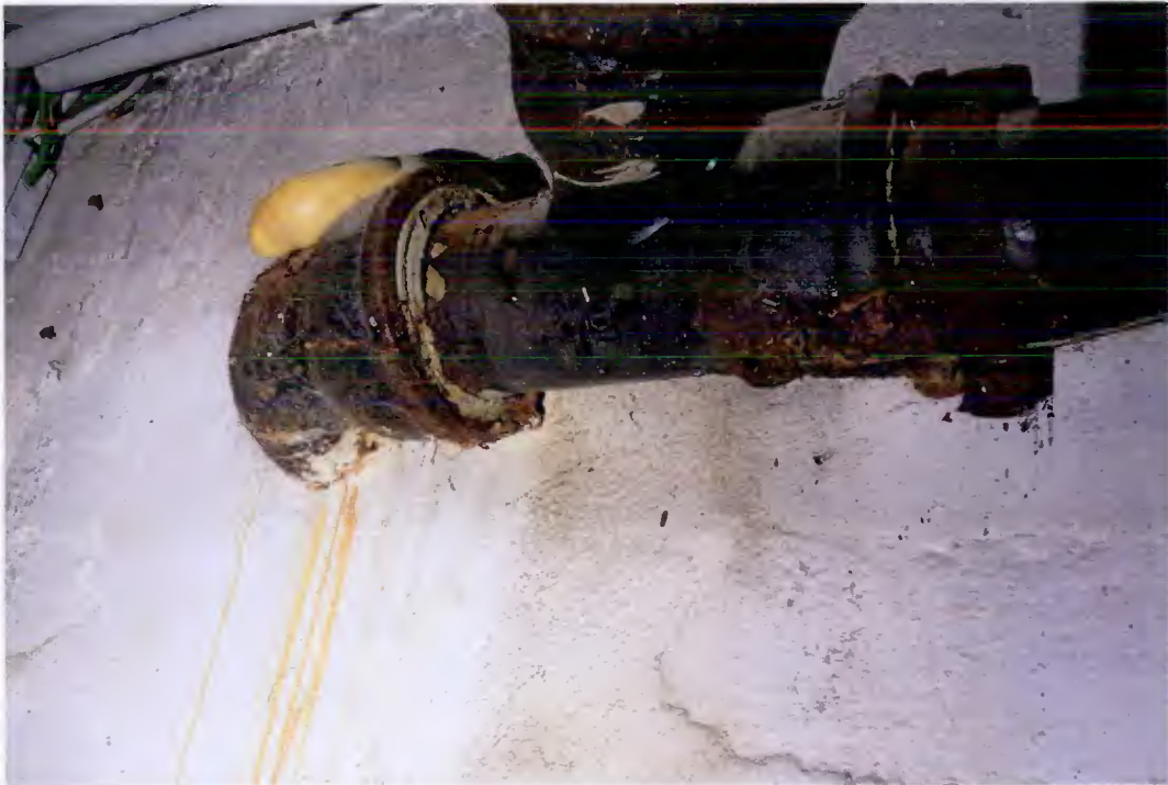
Abb. 71: stark korrodierte Gusseisen-Entwässerungsrohrleitungen
