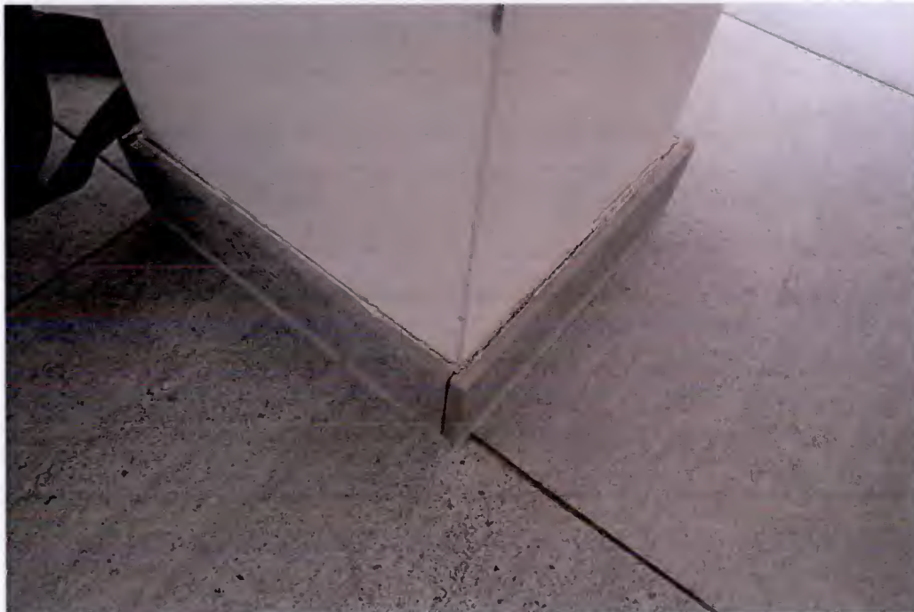
Abb. 20: vom Untergrund des Wohnzimmerpfeilers abgelöste Fliesensockel
