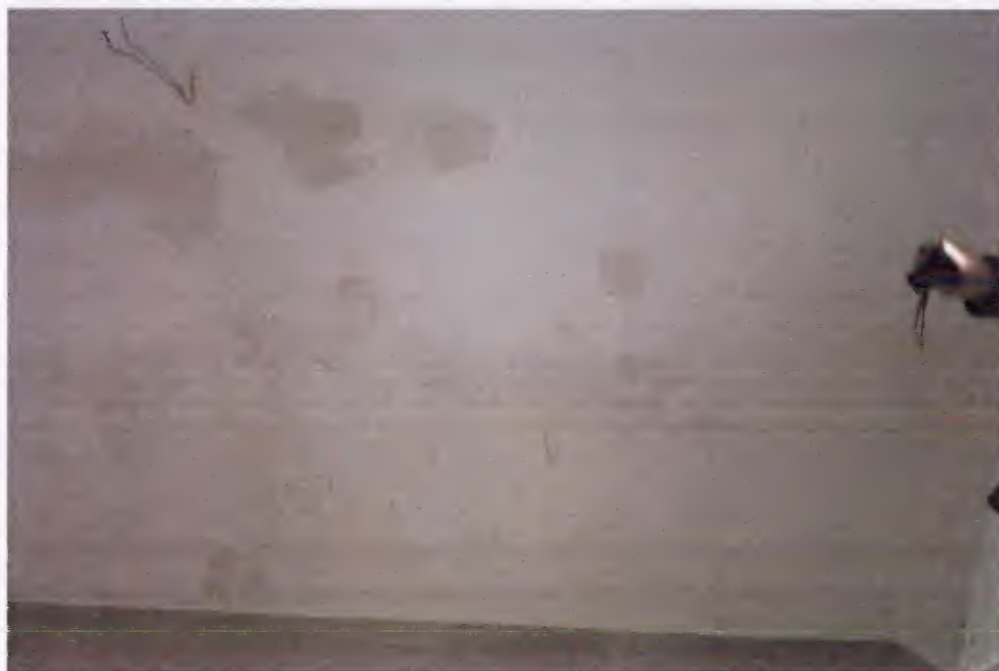
Abb. 45: Feuchtflecke auf der Kellerwand unterhalb des Wohnzimmers
