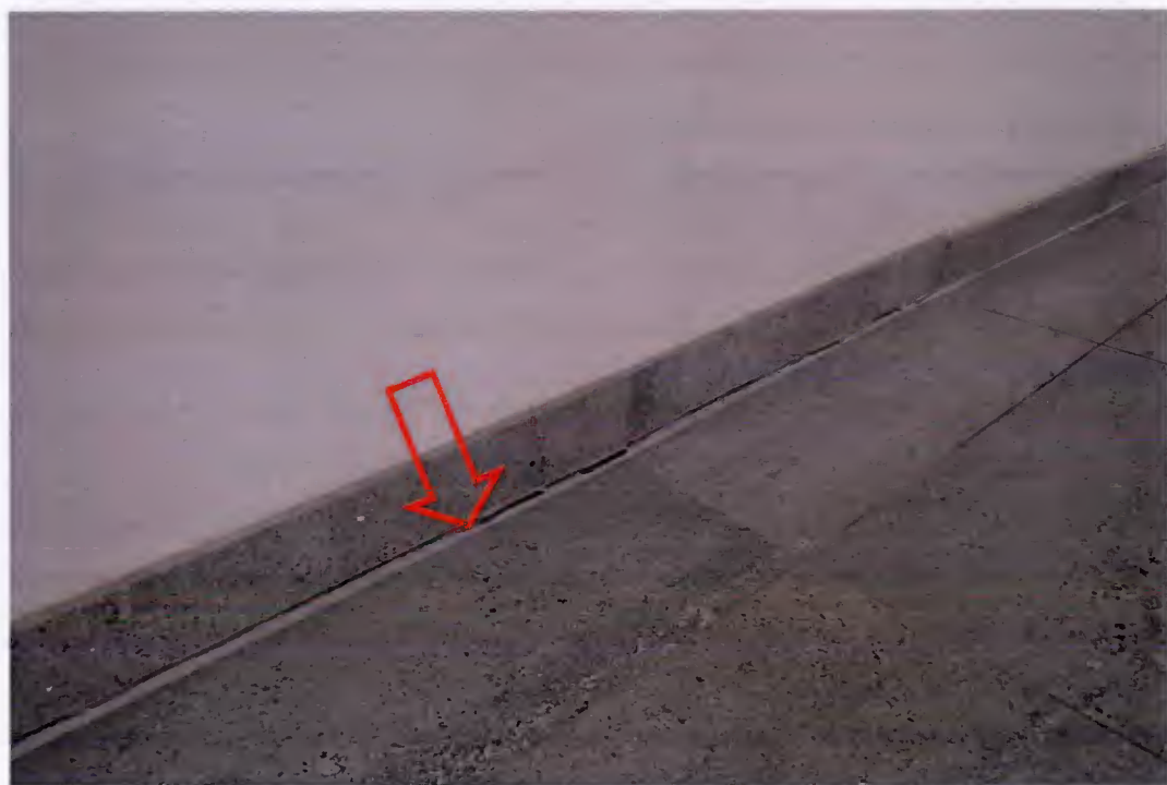
Abb. 22: Feuchteränder u. abgerissene Dichtstofffugen deuten auf Feuchte unter dem Estrich hin
