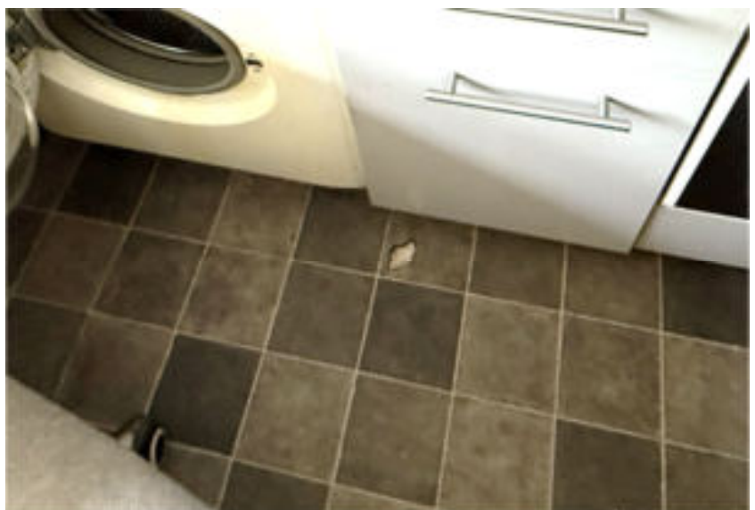
Abb. 4: Foto des SV; z.T. Bodenbelag (Küche) überaltert/ schadhaft
