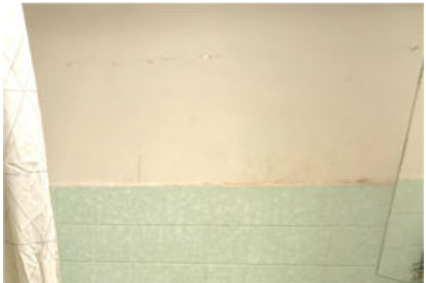
Abb. 3: Foto des SV; z.T. Wandbekleidung (Bad) überaltert/ schadhaft
