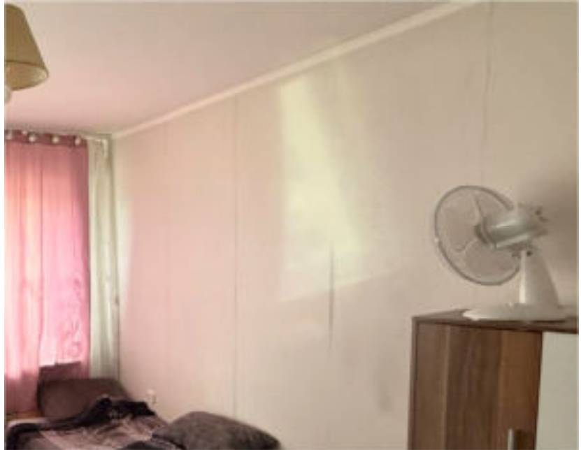
Abb. 5: Foto des SV; z.T. Wandbekleidung (Zimmer) überaltert/ schadhaft
