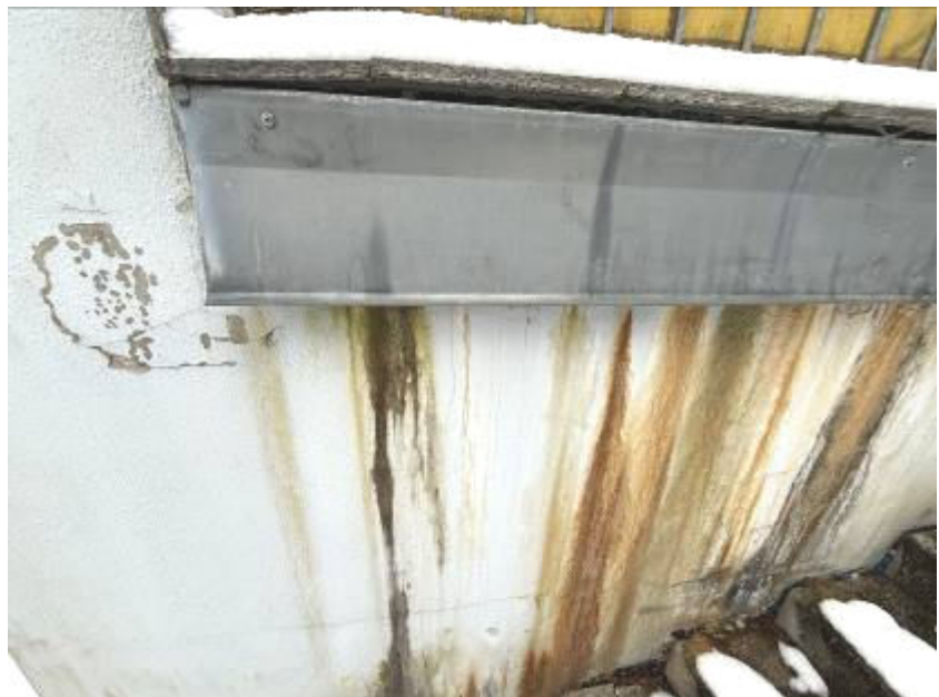
Abb. 3: Foto des SV; Terrassenbereich mit Feuchteschäden
