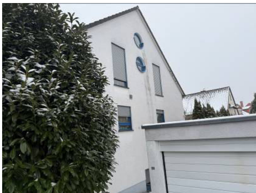
Abb. 5: Foto des SV; z.T. Außenputzverfärbungen/-verschmutzungen
