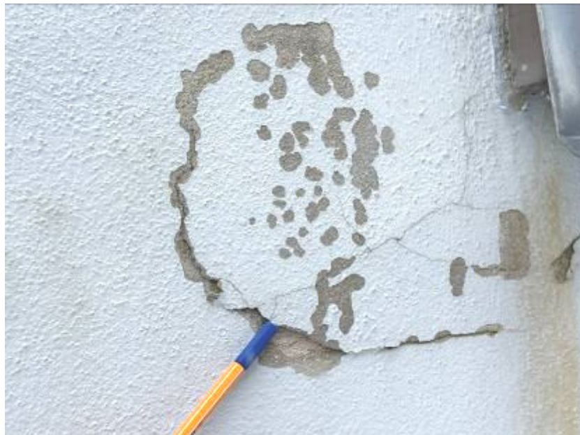
Abb. 4: Foto des SV; Terrassenbereich mit Feuchteschäden
