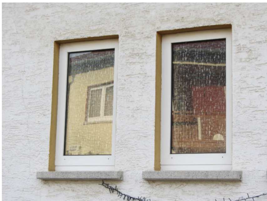
Bild 8: Zustand der PVC Fenster
