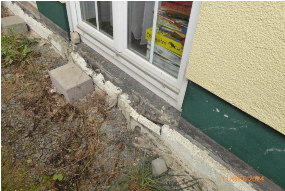
Foto 5: Zustand des Sockelbereichs der nordöstlichen Traufwand
