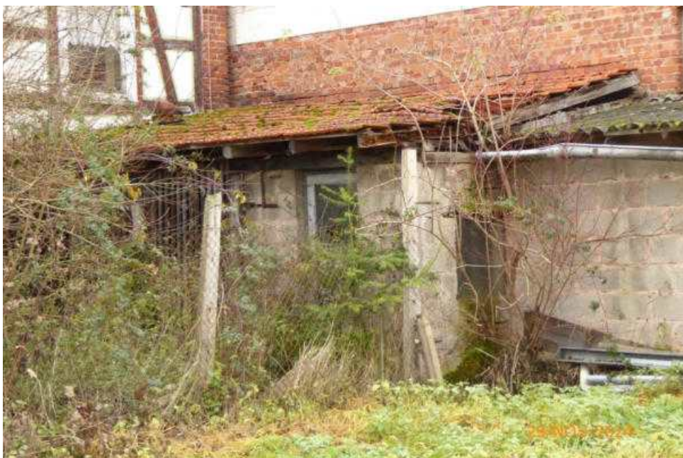
Foto 22: Kleinviehstall, baufällig und ohne Zeitwert
