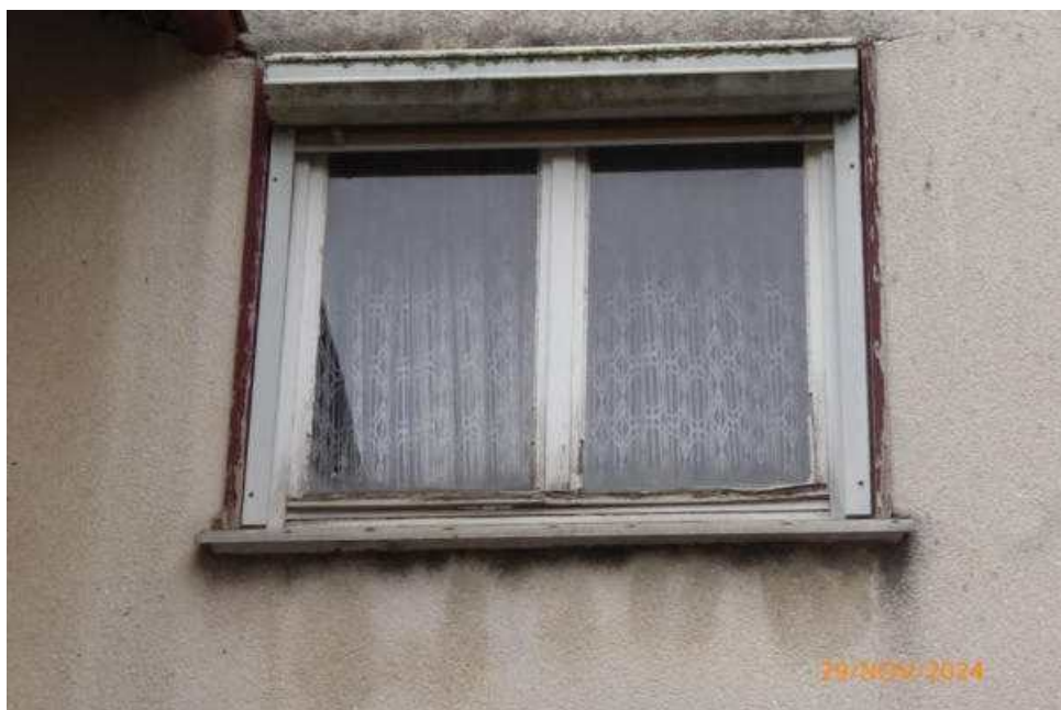
Foto 5: Zustand der Fenster am Wohnhaus
