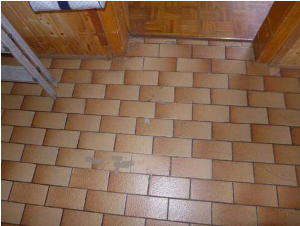
19 Beschädigte Fliesen Wohnungseigentum Nr. II
