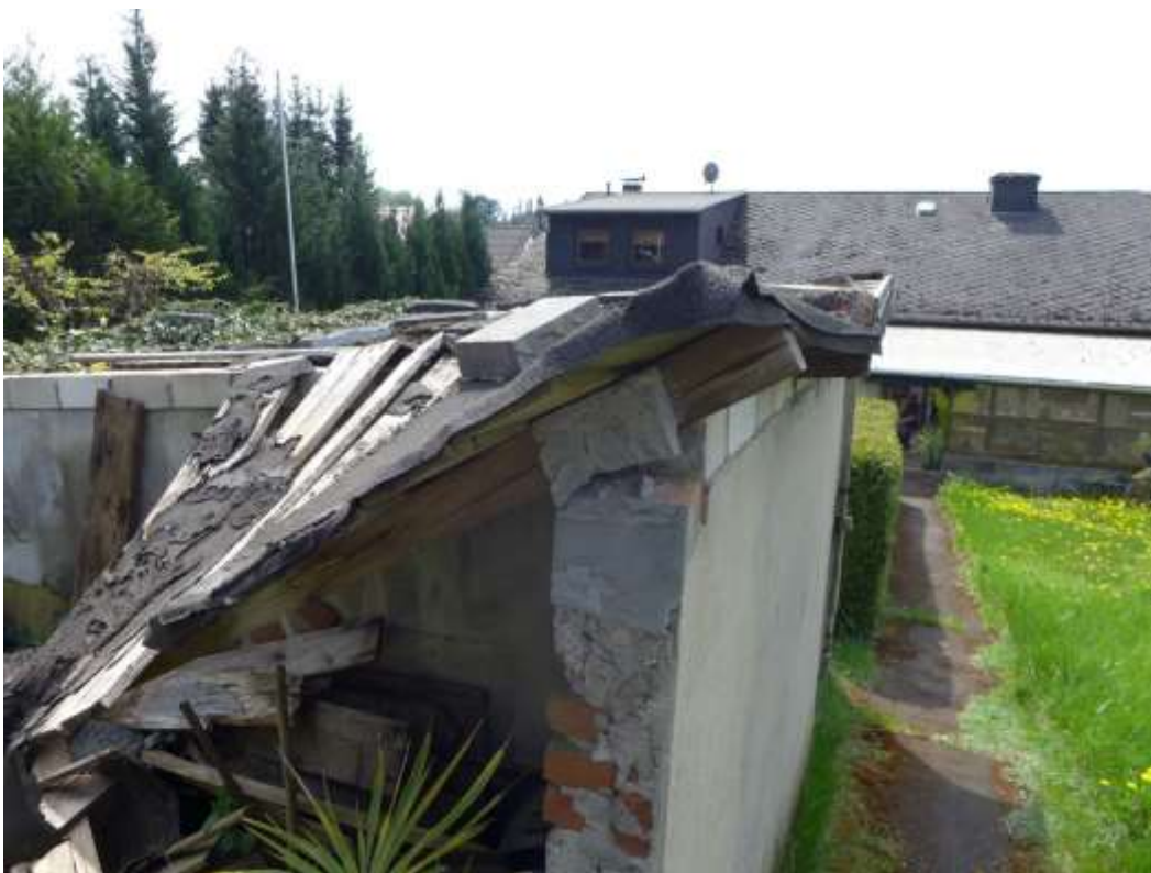
28 defektes Gartenhaus im oberen Bereich
