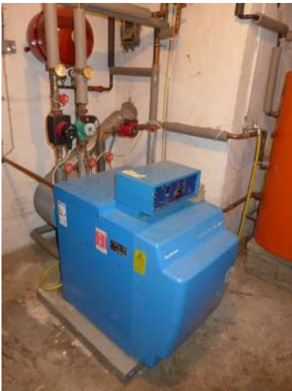
16 Heizung (gemeinschaftliches Eigentum)
