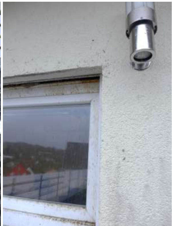
14 b verschmutztes Fenster Seminarraum
