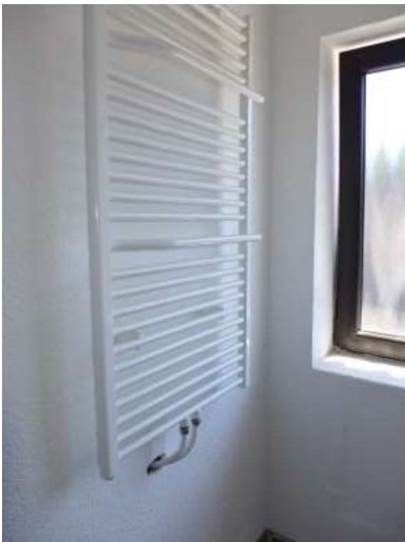
30 a Handtuchwärmekörper Bad OG
