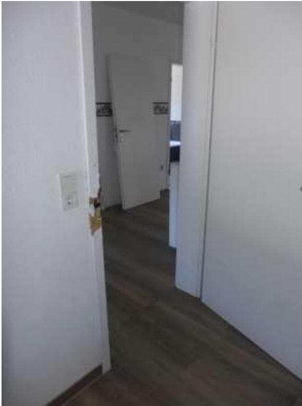
35 a beschädigte Türzarge
