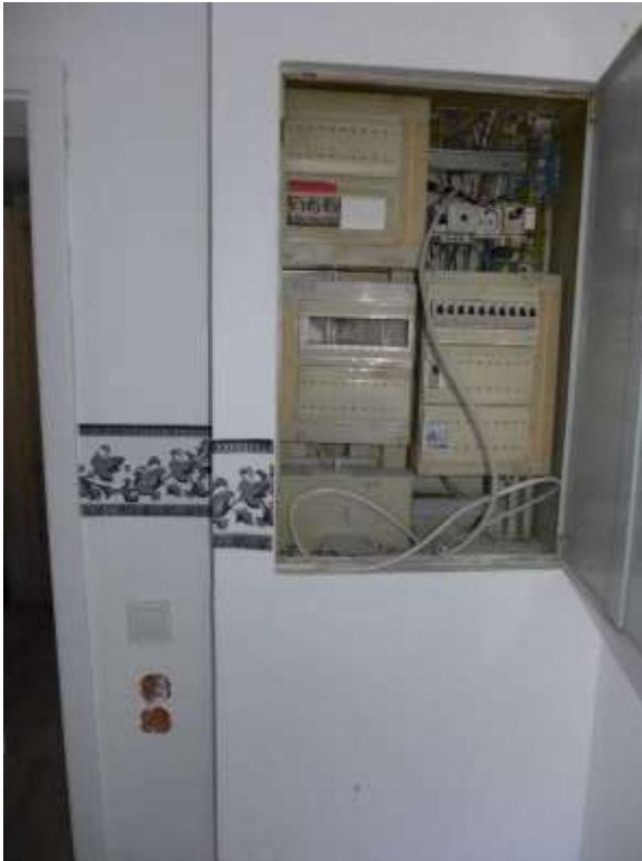
31 a Elektroinstallation Hauptwohnung OG
