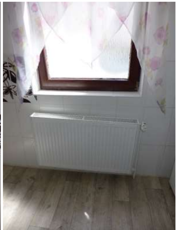
38 b mangelhafter Heizungseinbau
