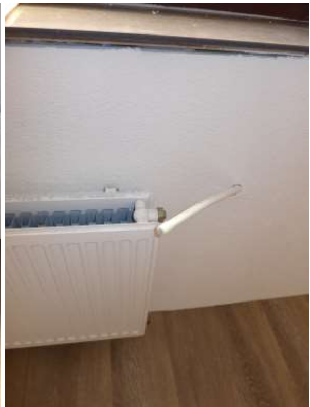
36 b fehlender Heizungsanschluss
