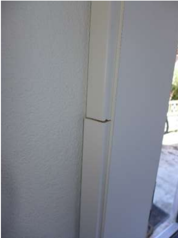
19 a schadhafte Türzarge
