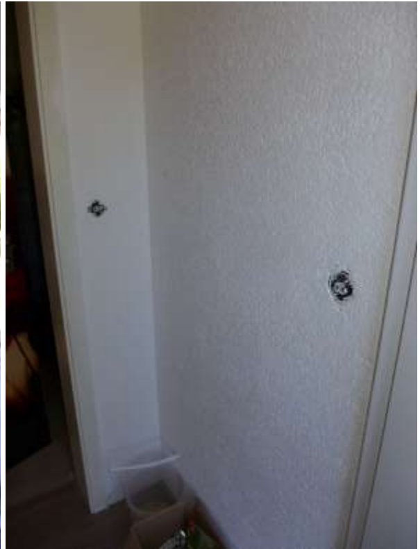
19 b fehlende Lichtschalter
