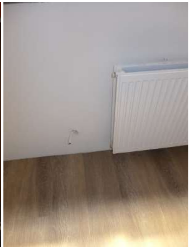
24 b fehlender Heizungsanschluss
