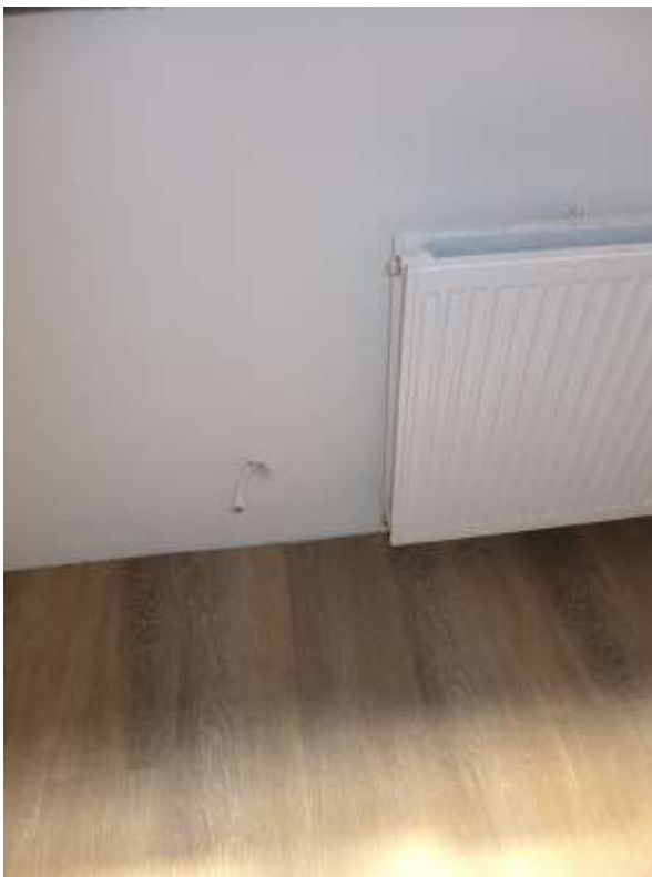
36 a fehlender Heizungsanschluss
