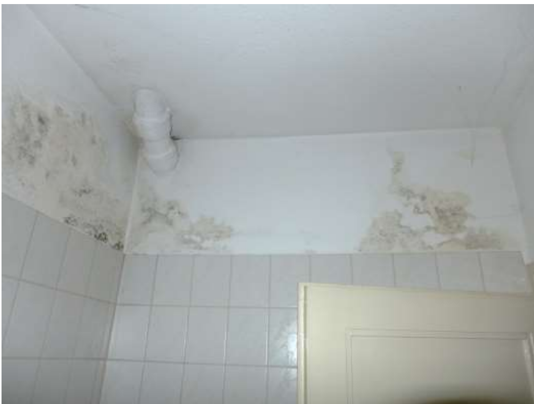
24 Schimmelbildung im Bad EG
