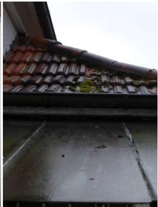
30 b schadhafte Dacheindeckung Eingangsvorbau
