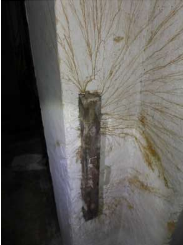
17 a Pilz durch Kellerfeuchte
