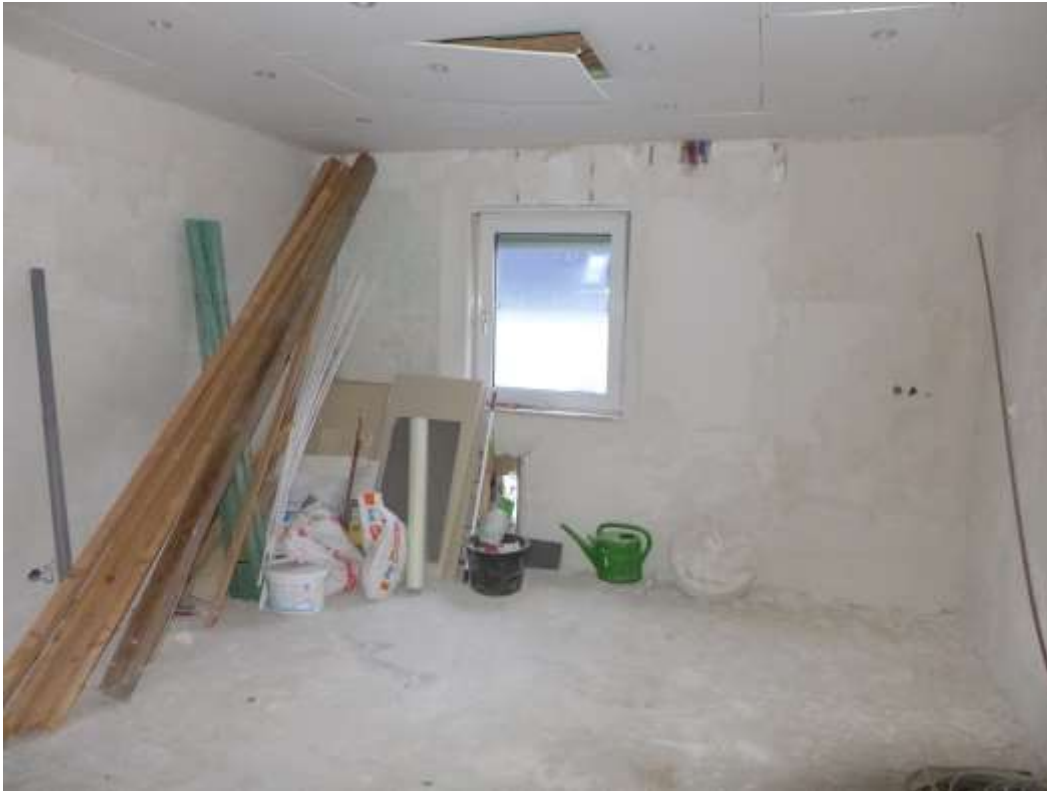
27 Zustand Zimmer Erdgeschoss, nicht fachgerecht abgehängte Decken
