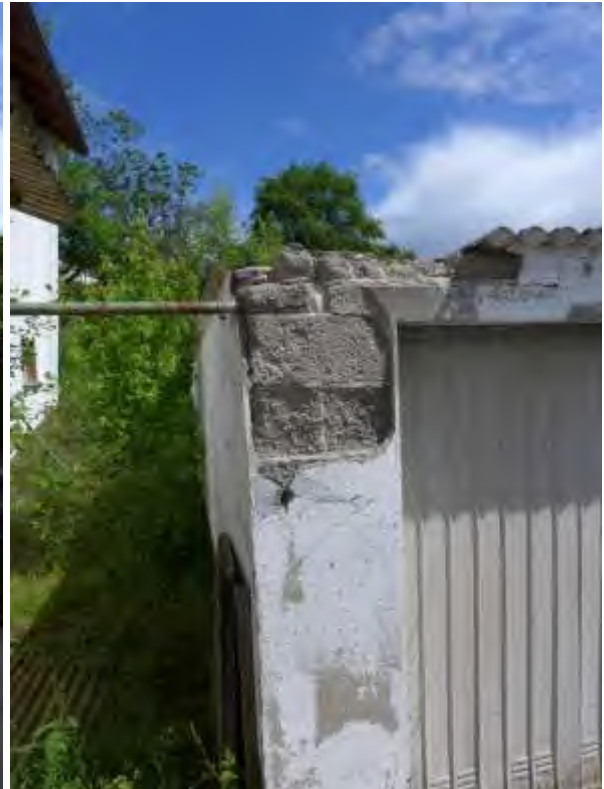
11 b Schaden am Garagendach
