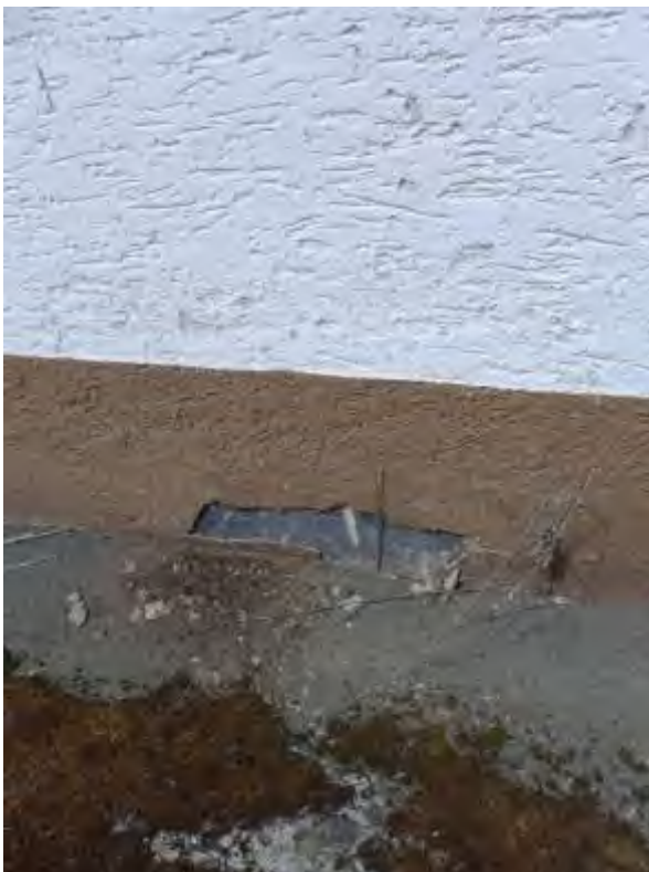
12 Schäden am Außenputz
