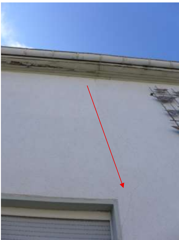
18 Schäden Dachrand, Fassadenriss
