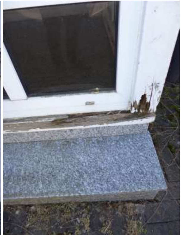
19 b Schäden Eingangsvorbau
