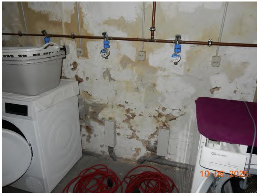
Feuchtigkeitsschaden im Keller
