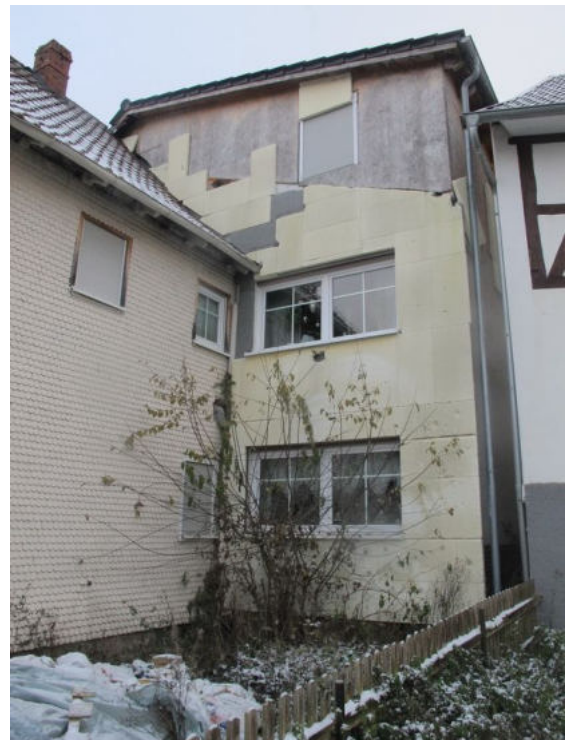
nicht fertig gestellter Fassadenbereich
