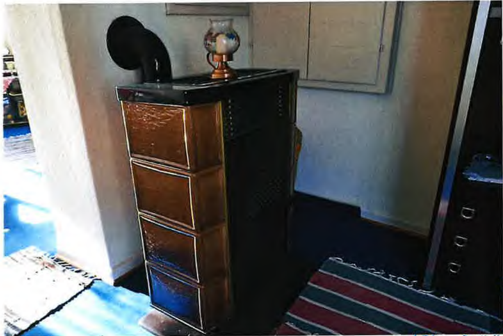
Bild 13: Beheizung nur über Kaminöfen, derzeit außer Betrieb (vgl. Ziff. 4.9) → Heizung und Energiebedarf bei Weitem nicht mehr zeitgemäß
