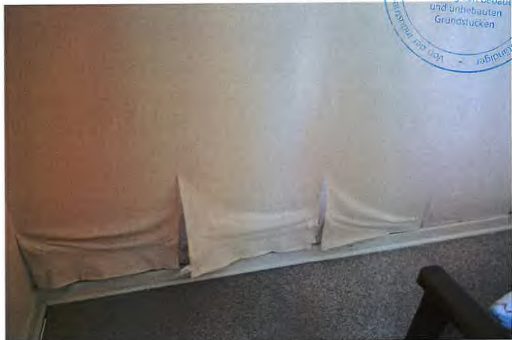
Bild 10: Tapeten in mehreren Räumen z. T. verschlissen mit Schimmelschäden
