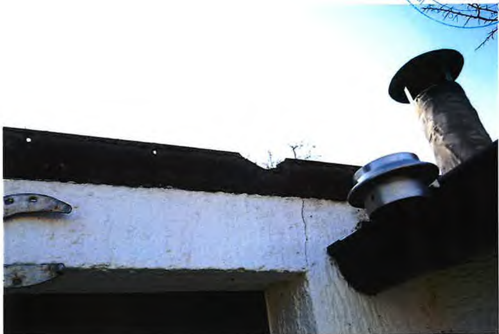
Bild 6: Welleternitdeckung (asbesthaltig) z. T. defekt
