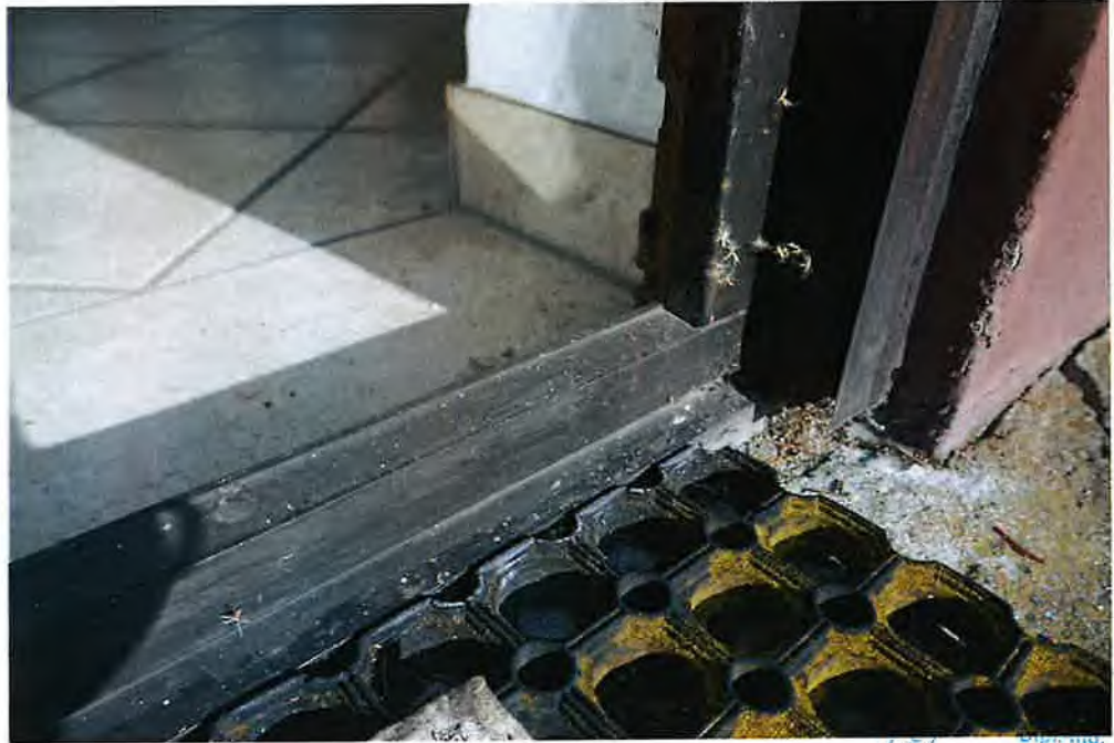
Bild 7: Schwellenhöhe zur Terrasse < als 15 cm → Einlaufrinne fehlt, Andichtung mangelhaft
