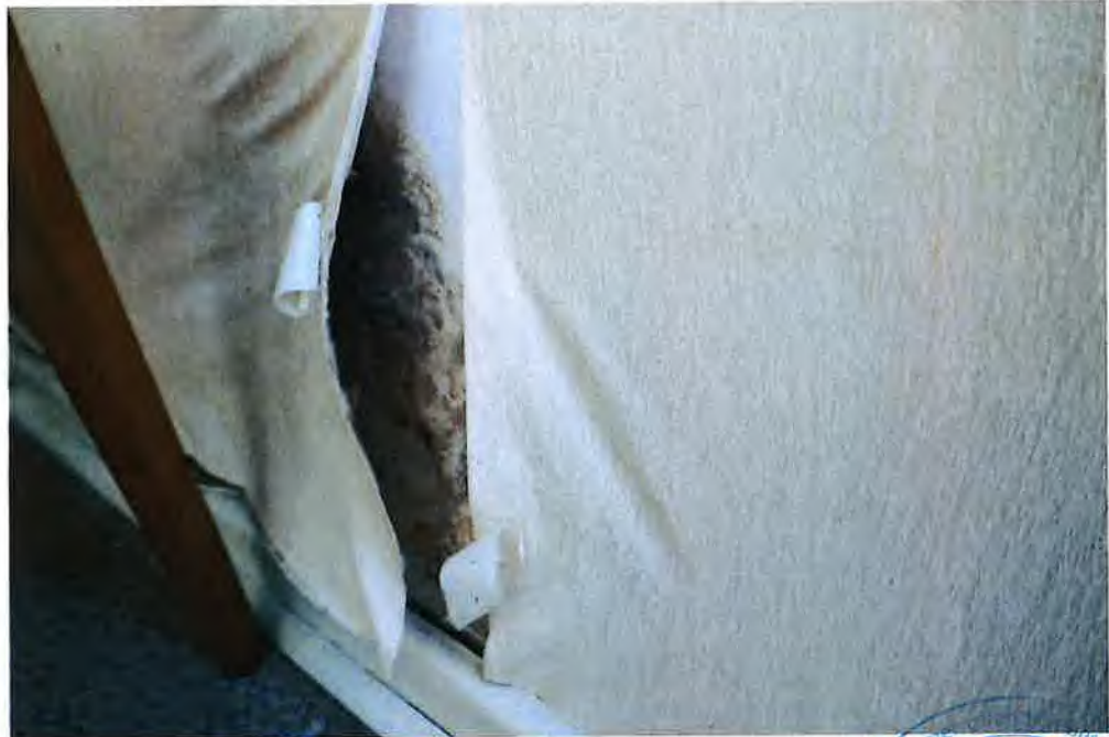
Bild 9: Tapeten in mehreren Räumen z. T. verschlissen mit Schimmelschäden
