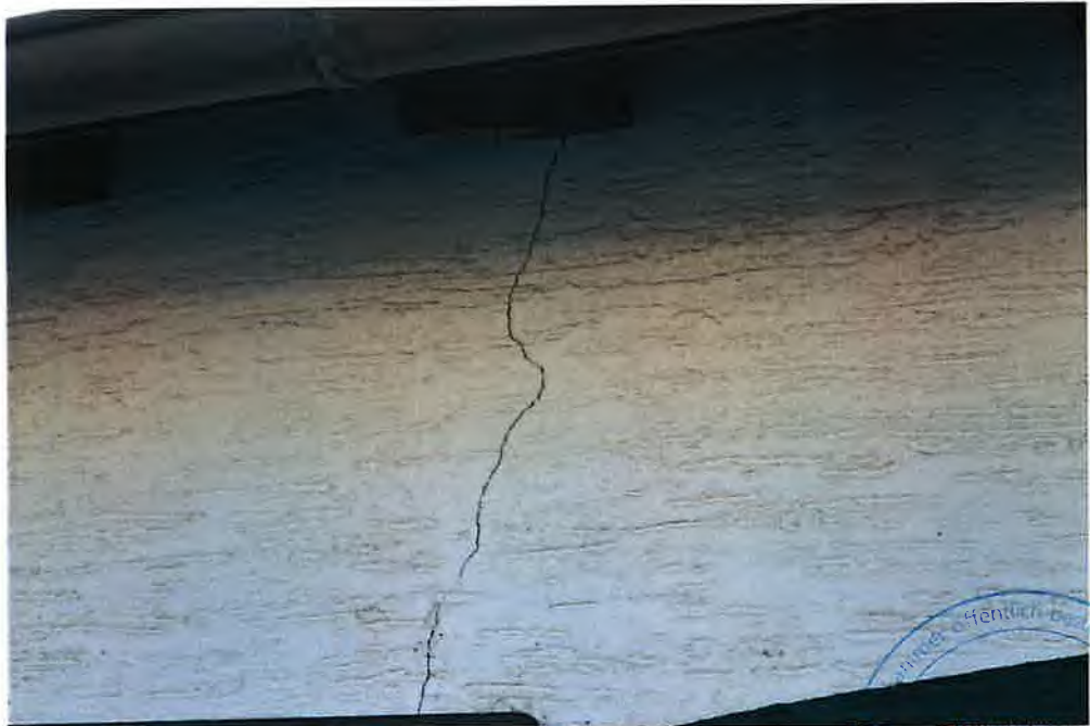
Bild 5: Außenputz z. T. defekt (Risse)
