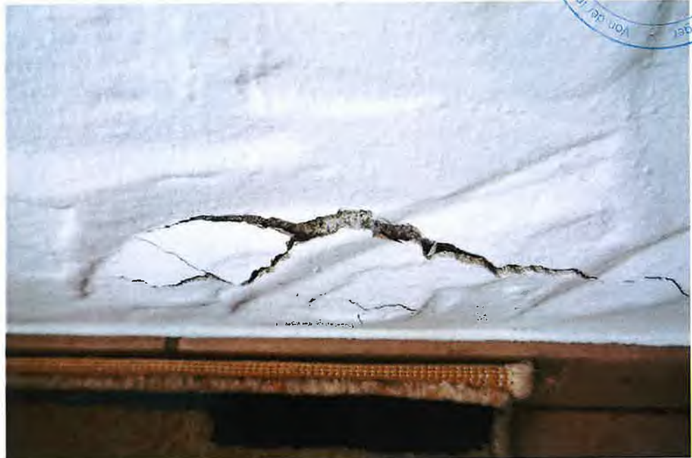
Bild 8: Innenputz z. T. defekt
