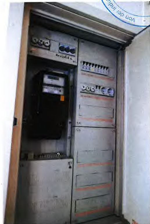
Bild 14: Zählerschrank mit Unterverteilung, FI-Schalter nicht vorhanden
