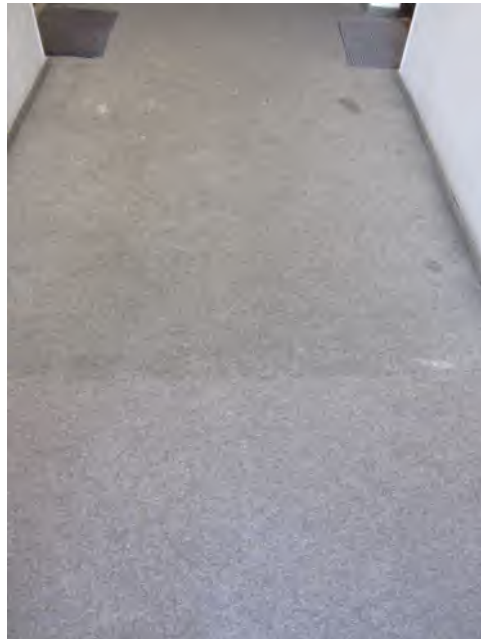
Bild 33: Überalterter Teppich im Flurbereich
