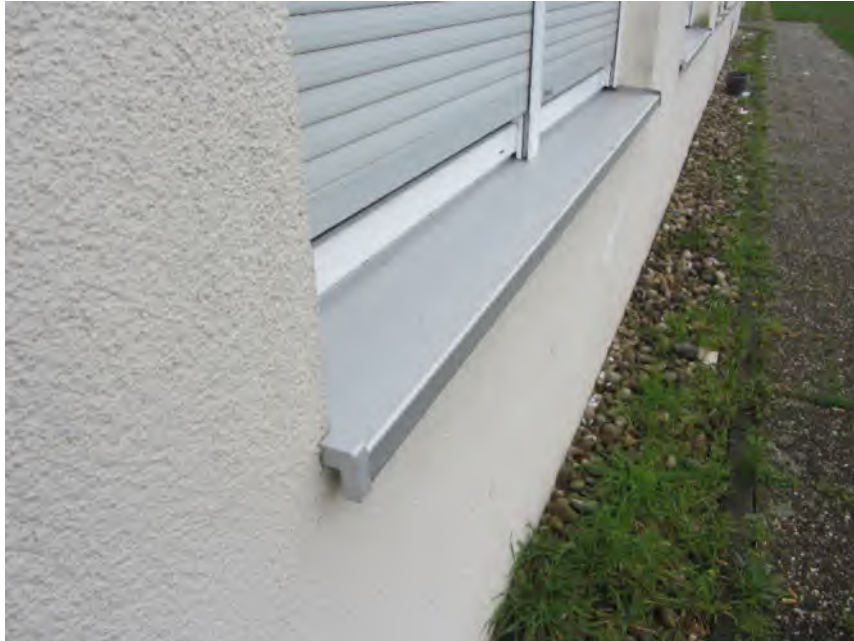
Bild 15: Zustand Rollladen und Fensterbank
