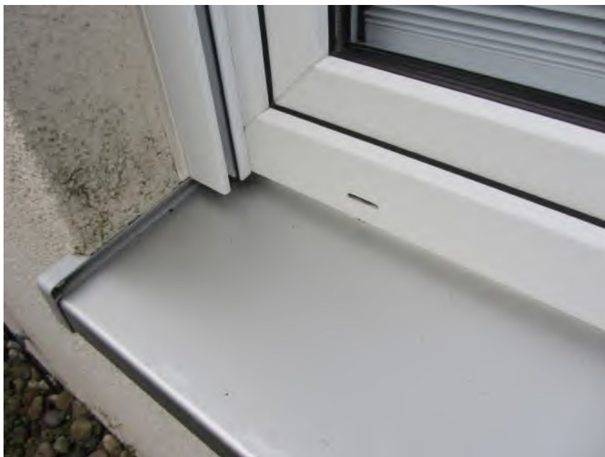
Bild 20: Zustand PVC-Fenster und Fensterbank
