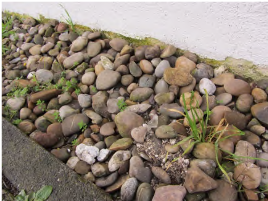
Bild 16: Putzschäden im Sockelbereich
