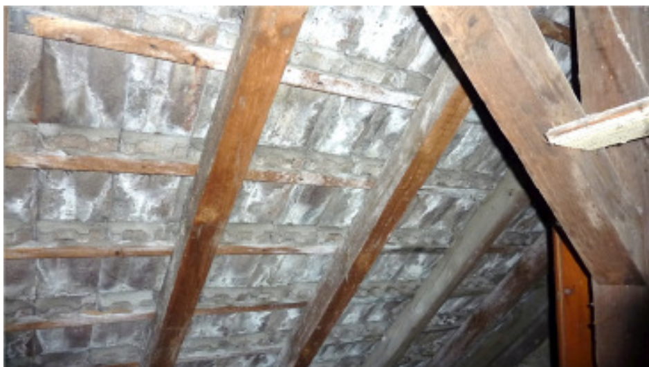
Ziegeldach Wohnhaus mit altersbedingten Abnutz.ersch.
