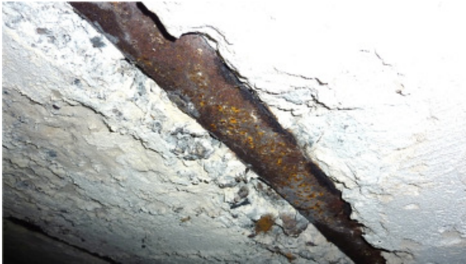
erhebl. Korrosion Stahldeckenträger in KG Scheune
