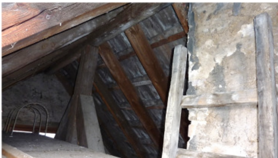
Dachstuhl Wohnhaus / Schornstein mit Versottungserscheinungen und Putzschäden
