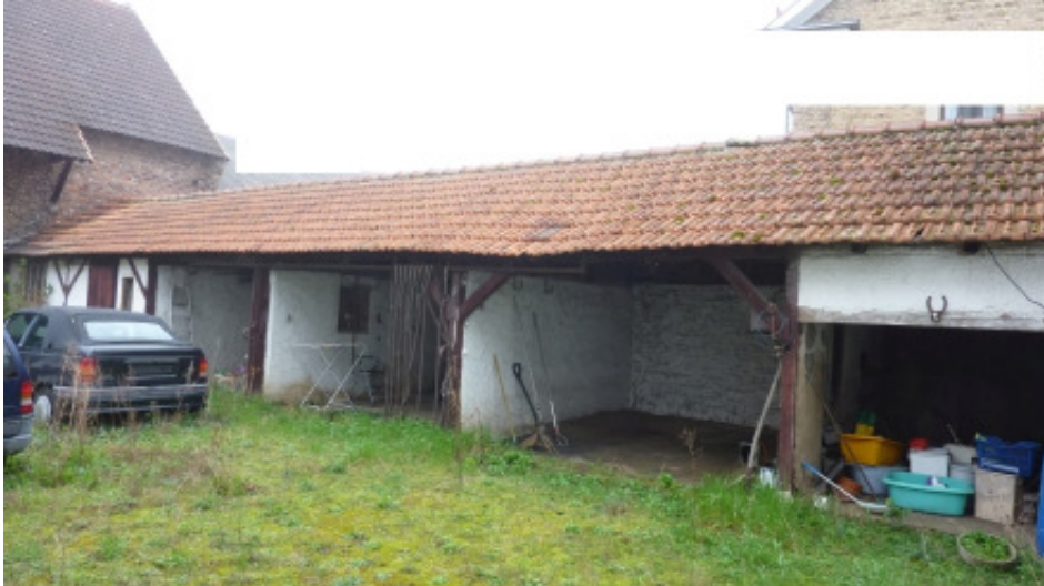
überalterter Anbau mit erheb. Abnutz.ersch./Schadstellen
