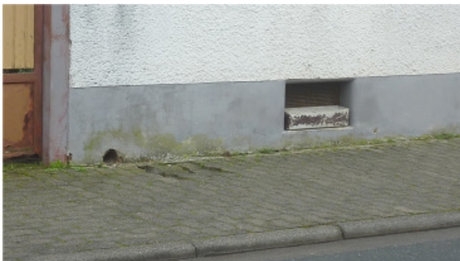
Haussockel mit Feuchteschäden
