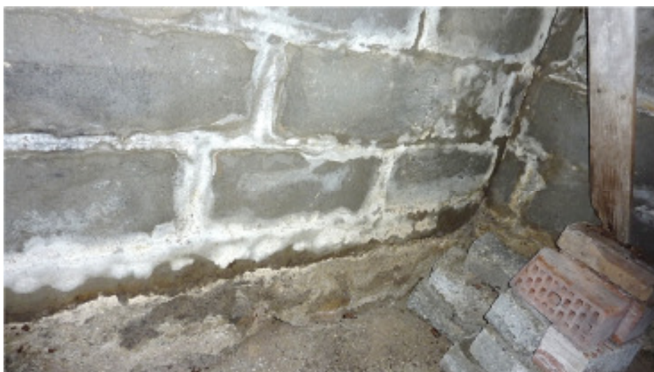
erhebl. Feuchte-/Putzschäden im Kellersockel- / Kellerwandbereich Wohnhaus
