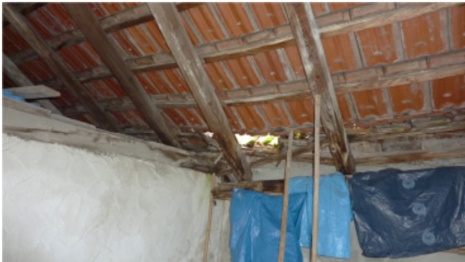
defekte Dachkonstruktion Anbau
