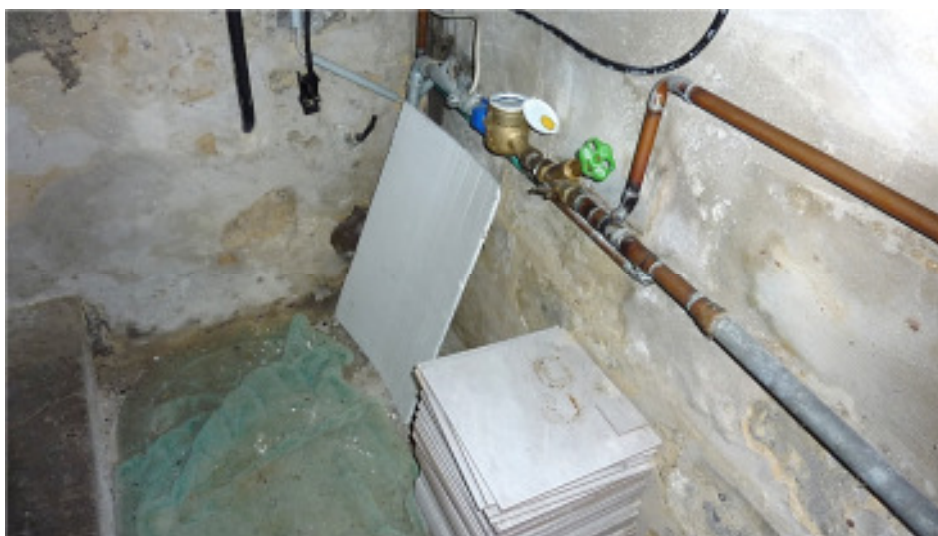
erhebl. Feuchte-/Putzschäden im Kellersockelbereich Wohnhaus
