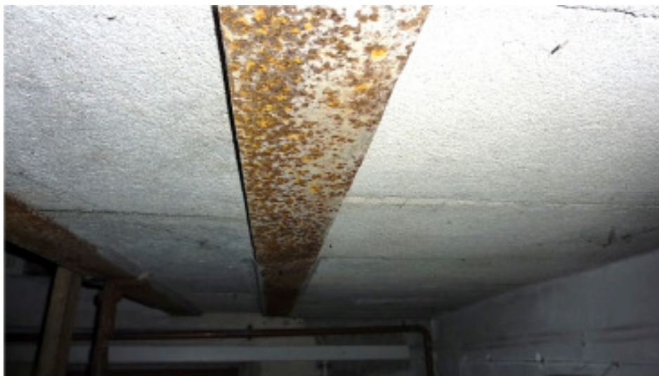
Stahlträger KG Wohnhaus mit Korrosionserscheinungen
