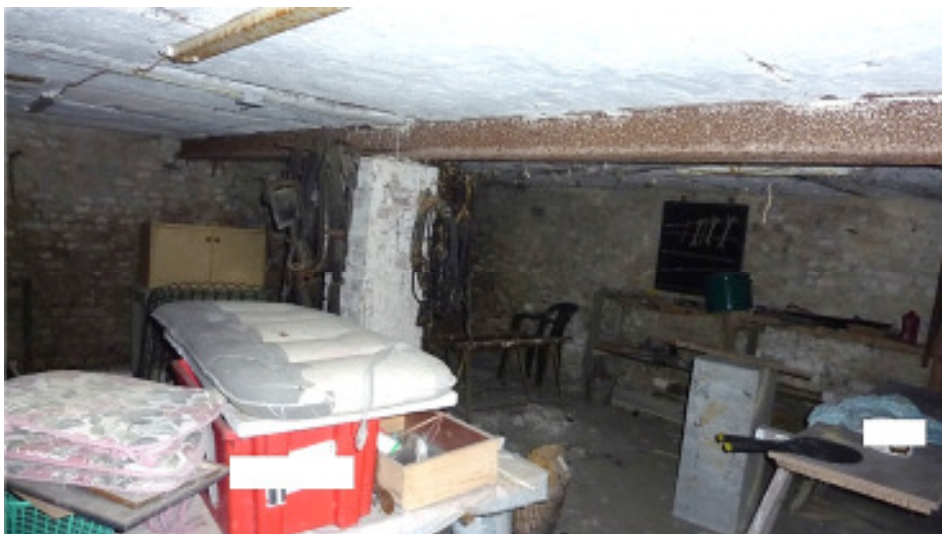
Teilunterkellerung Scheune mit erheb. Feuchteschäden
