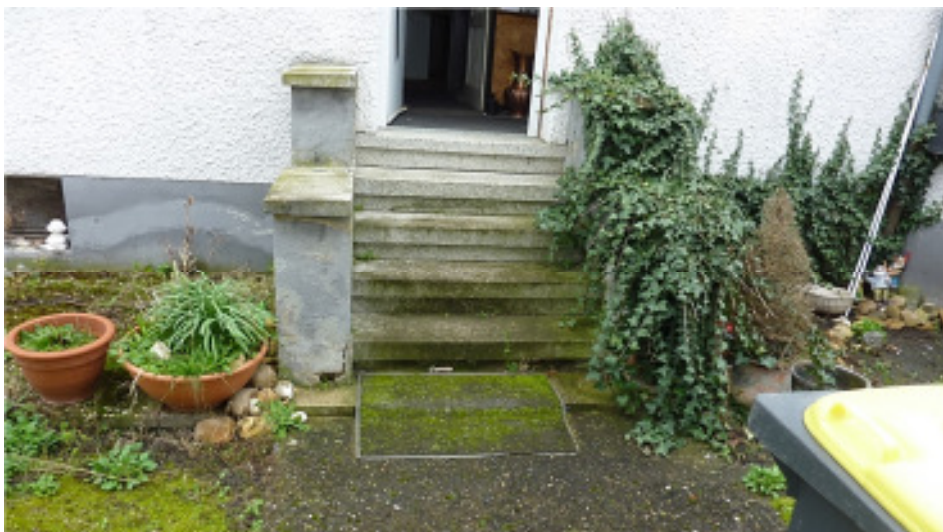
Eingangsbereich Wohnhaus mit Schadstellen
