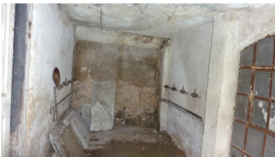
überalterter Anbau Innenraum mit erheb. Feuchteschäden
