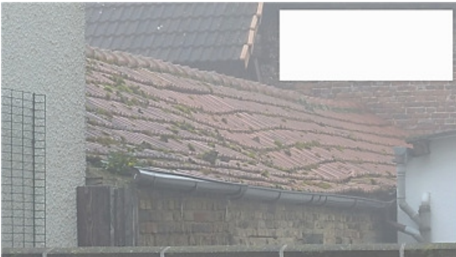
Anbau mit defektem, eingedrücktem, welligen Dach
