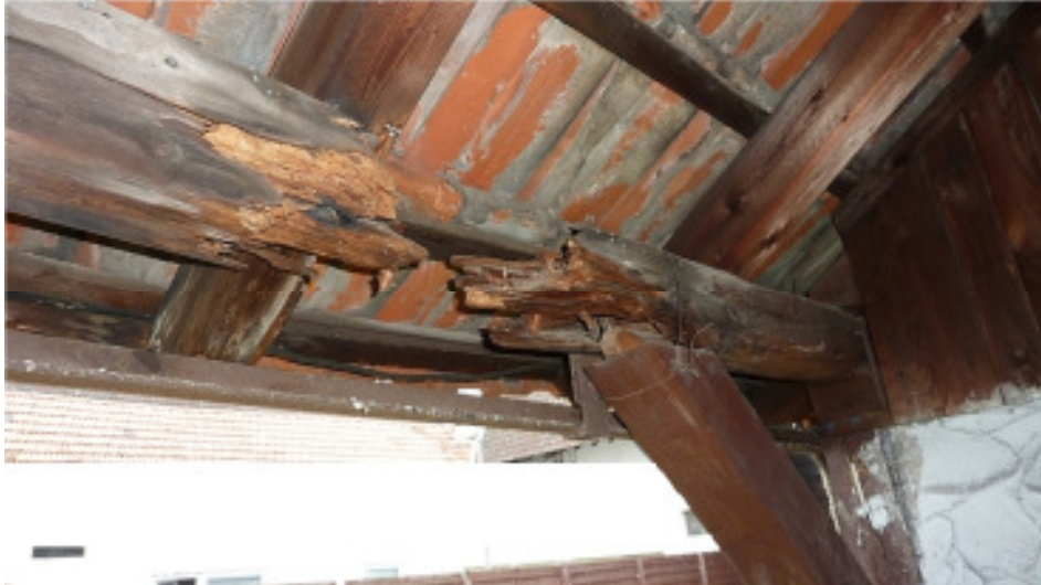
defekte Holzkonstruktion Dach Anbau
