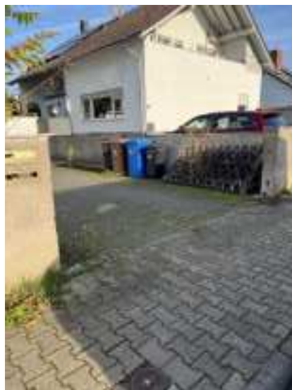
Kaputtes Hoftor (Hofeinfahrt)
