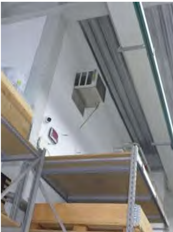
38 a Gebläseheizung kleine Halle
