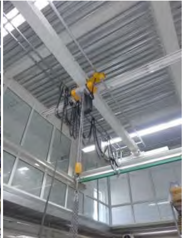
37 b Krananlage kleine Halle
