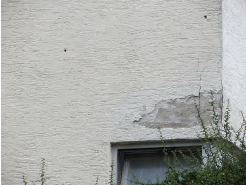
Bild 19: Kleinere Putzschäden vorhanden
