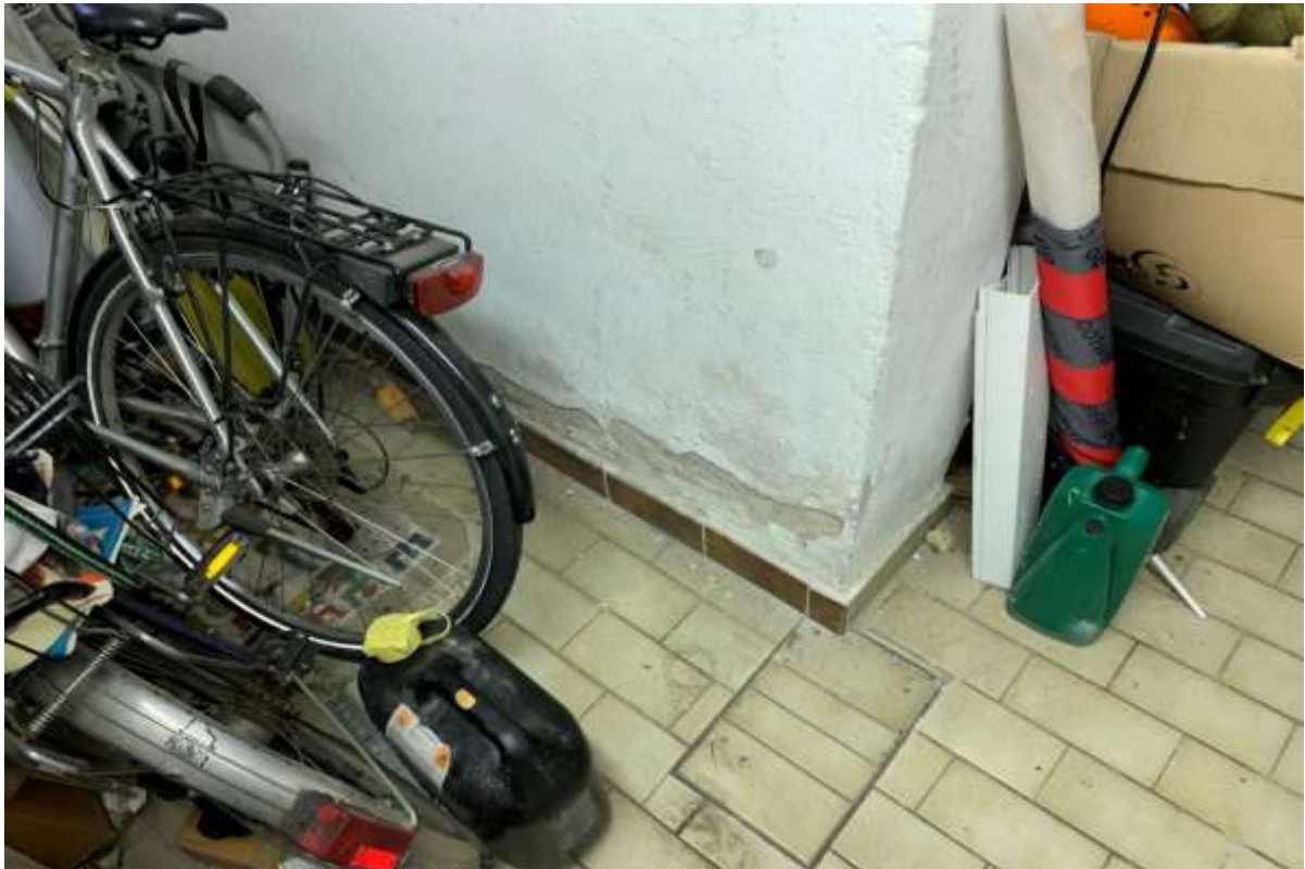
beispielhafter Kellerraum mit Feuchtigkeitsschaden
