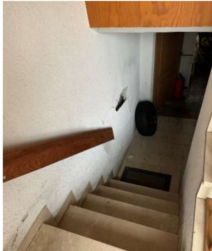
Treppenabgang vom EG ins KG und Putzschaden (links)
