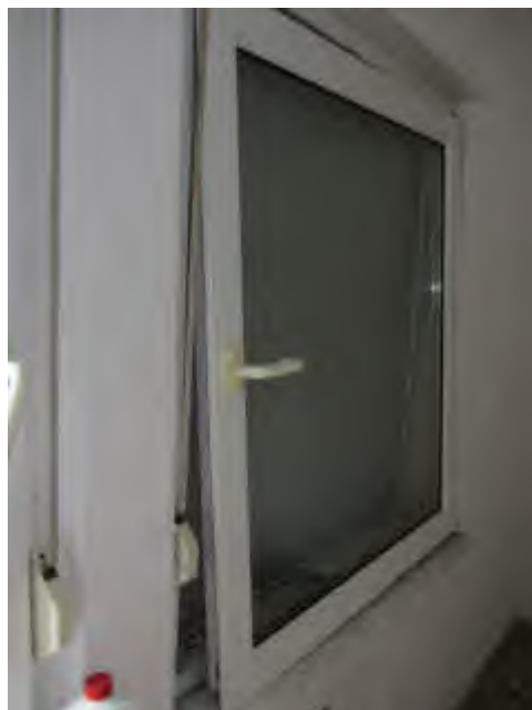
Bild 26: Obergeschoss, ausgehängtes Fenster
