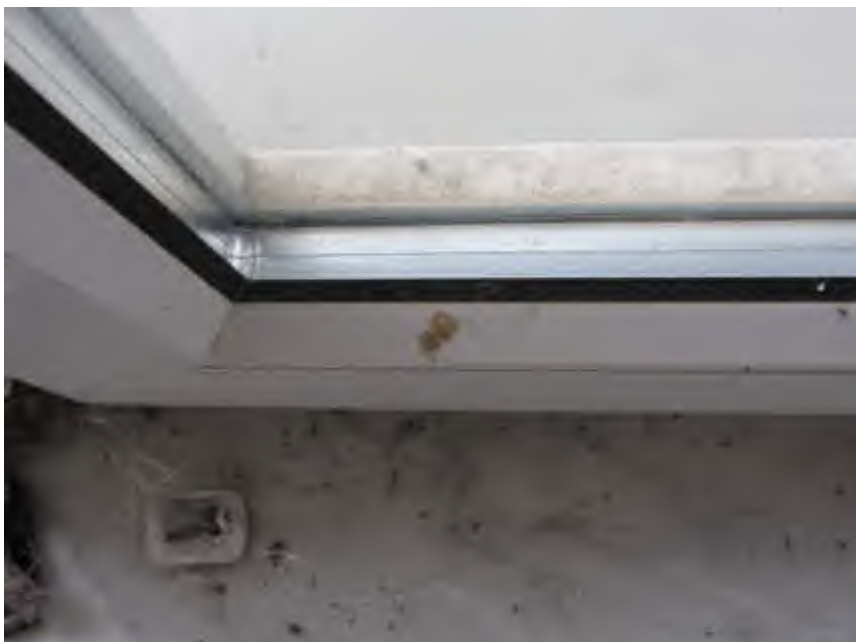
Bild 22: Obergeschoss, Zustand Fenster
