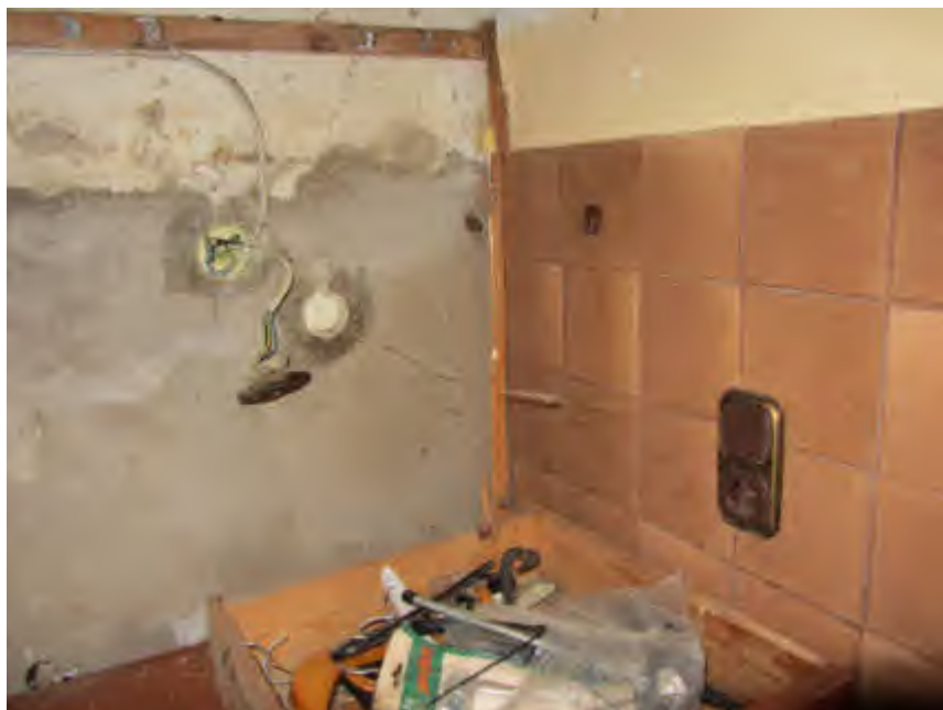
Bild 18: Erdgeschoss, Zustand Elektro
