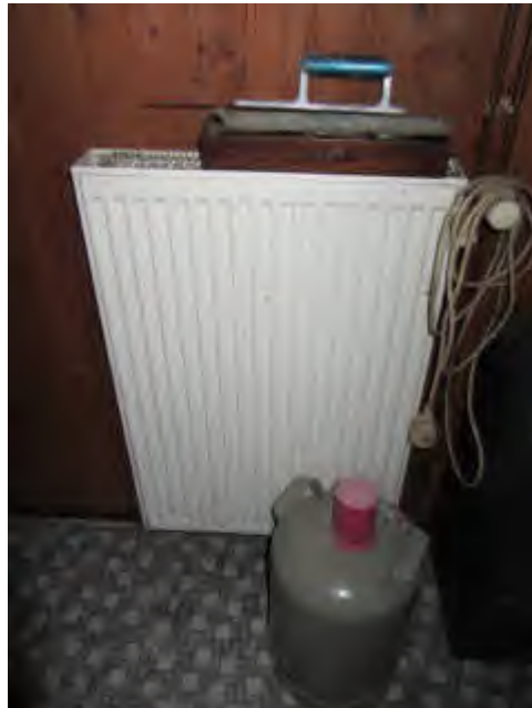
Bild 19: Erdgeschoss, Zustand Heizkörper (außer Betrieb)
