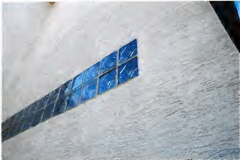
Bild 5: Glasbausteinelemente (Oberlicht) im KG und EG mit z. T. Frostschäden (abgeplatzt bzw. gerissen)
