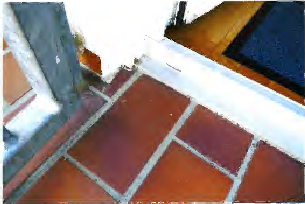
Bild 9: Balkontür 1.OG: Anschlusshöhe zu gering
