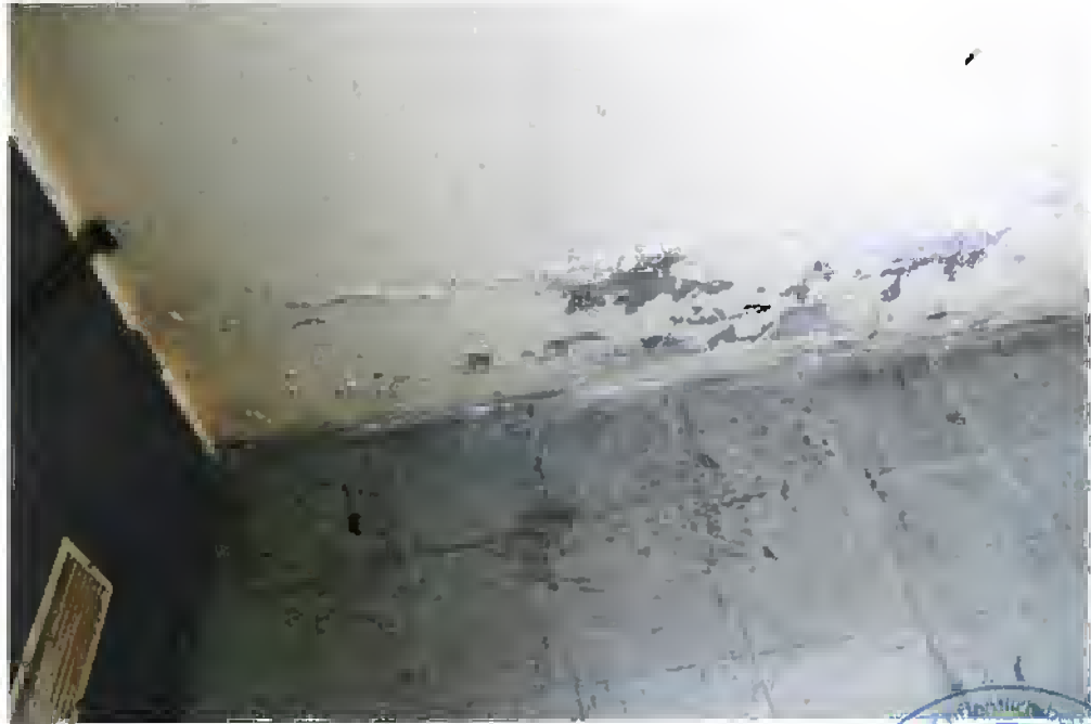
Bild 7: KG: Wände im Sockelbereich mit Putzablösung und Aussatzung (zurückliegender Wasserschaden)
