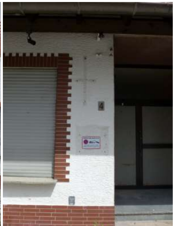
10 b Fassadenverschmutzung Eingang EG
