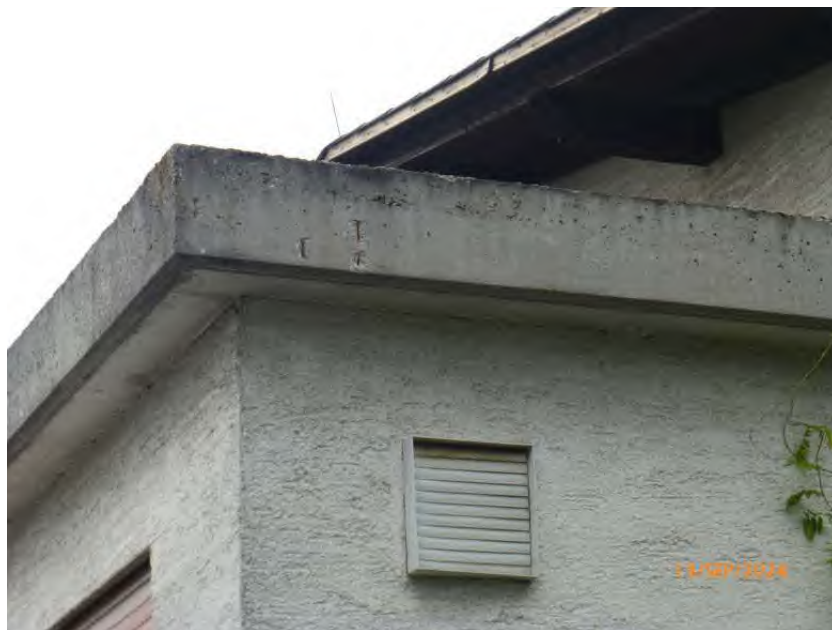
Schäden an der Fassade
