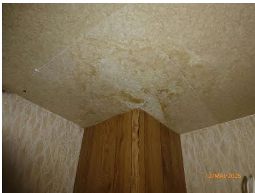
Wohnung mit Wasserschaden
