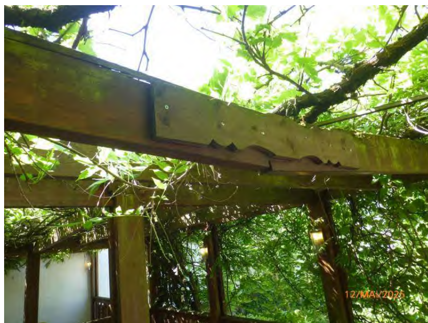
Schaden an der Pergola
