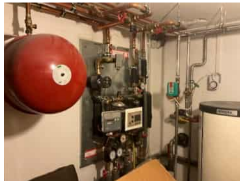
Keller Fernwärme- übergabe- station und Pufferspeicher (links)
