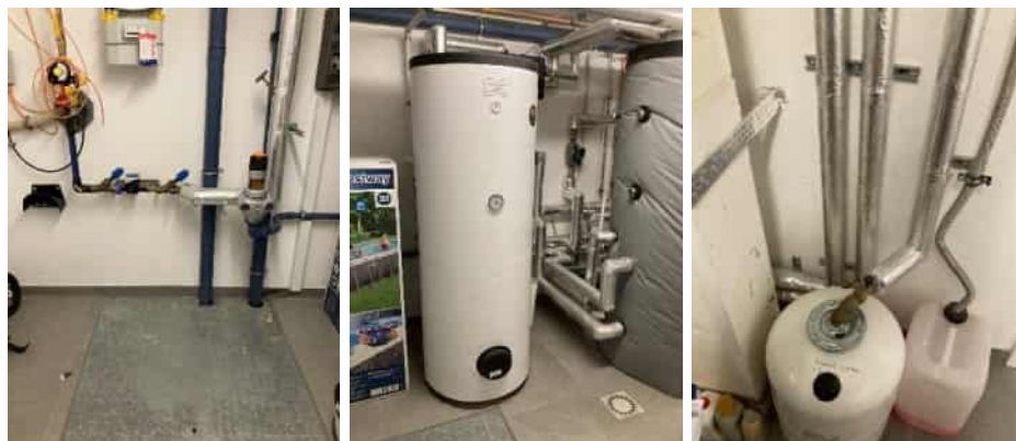
Heizungskeller Hebeanlage Pufferspeicher
