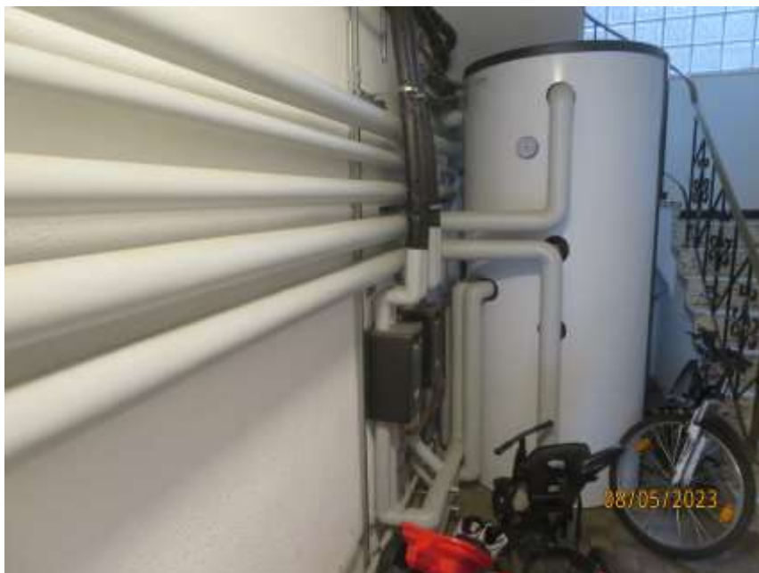
Bild 11: Teilansicht erneuerter Warmwasservorlagebehälter im Treppenraum
