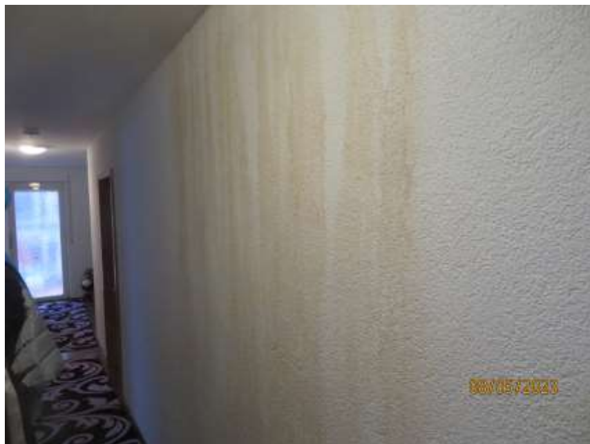
Bild 13: Teilinnenansicht Flur (ehemalige Feuchtespuren)
