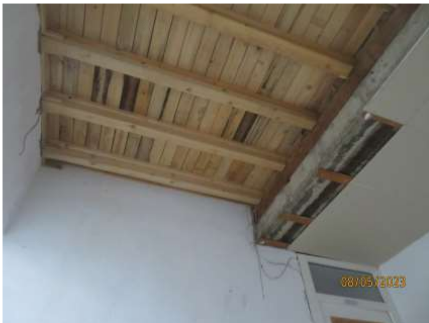
Bild 12: Teilinnenansicht zu dem entsprechenden Treppenraum mit Fertigstellungsbedarf
