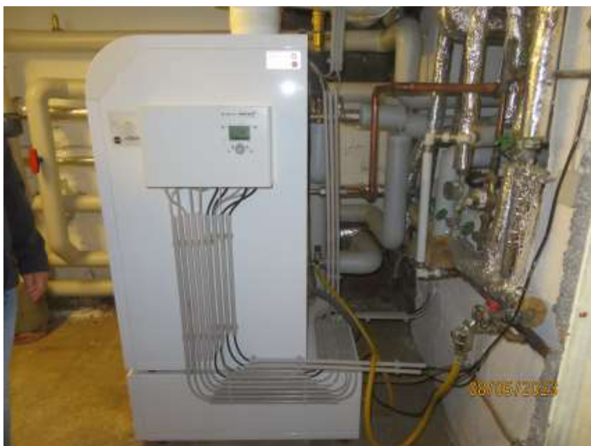
Bild 10: Teilansicht erneuerte Heizungsanlage
