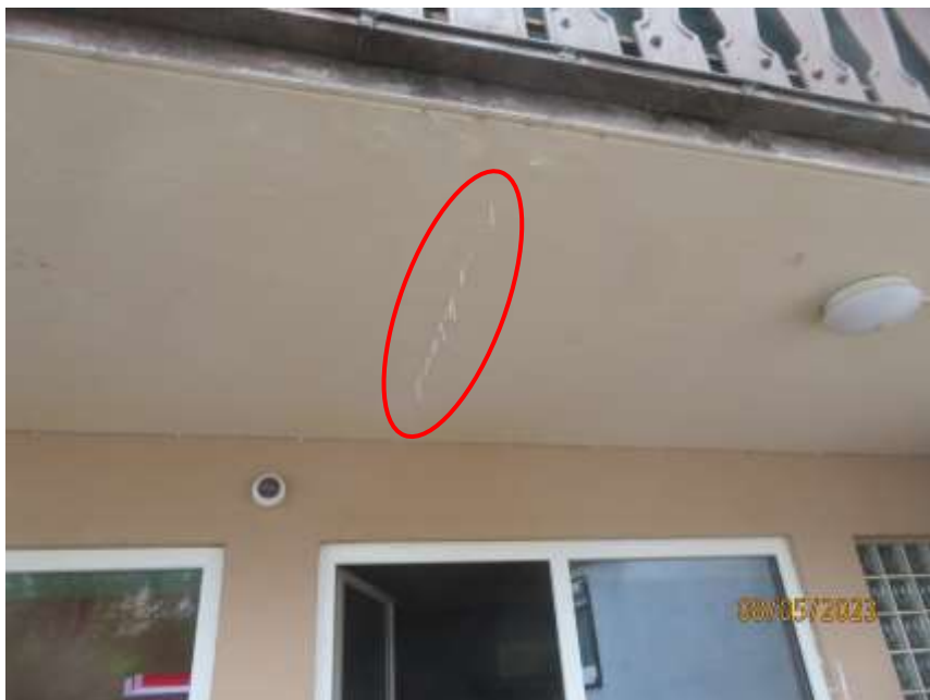
Bild 9: Teiluntersicht des Balkones mit Sanierungsbedarf / Feuchteschäden
