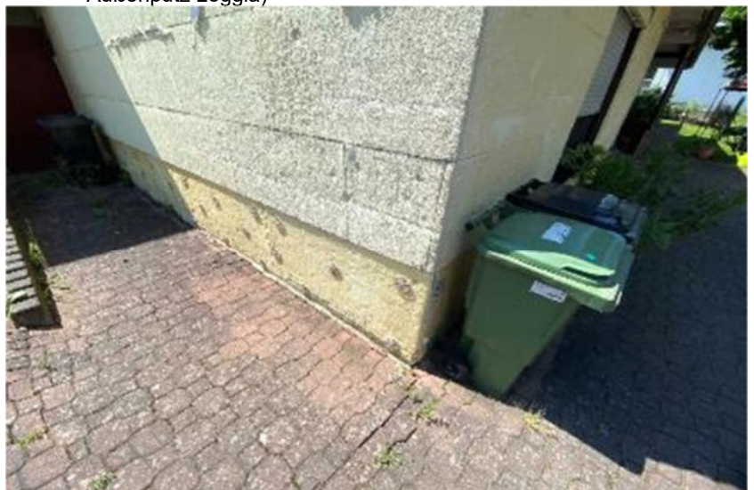
Abb. 6: Foto des SV; z.T. Fassade schadhaft (fehlender Oberputz WDVS)
