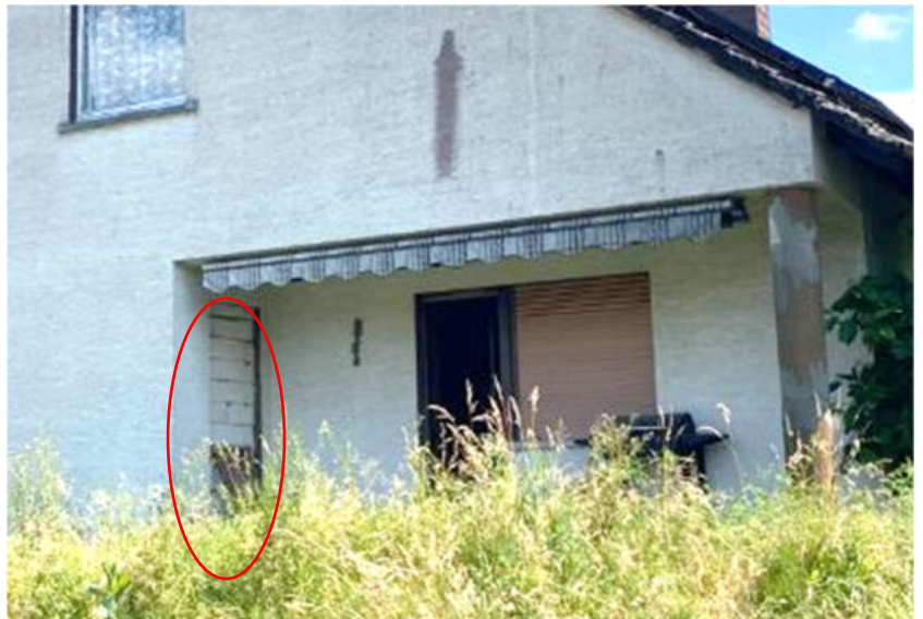
Abb. 5: Foto des SV; z.T. Fassade schadhaft (Putzverfärbungen, fehlender Außenputz Loggia)
