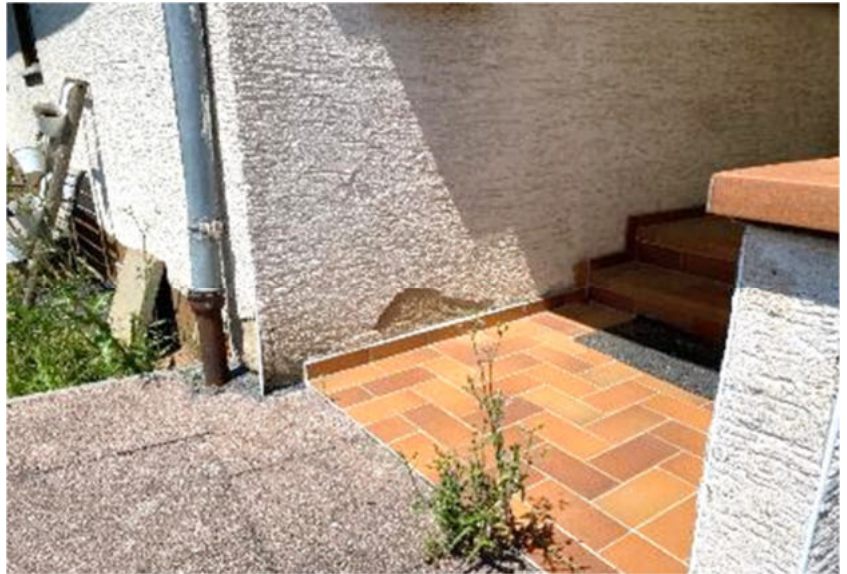
Abb. 4: Foto des SV; z.T. Fassade schadhaft (Putzschäden)
