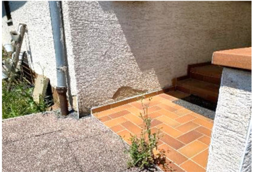
Abb. 4: Foto des SV; z.T. Fassade schadhaft (Putzschäden)
