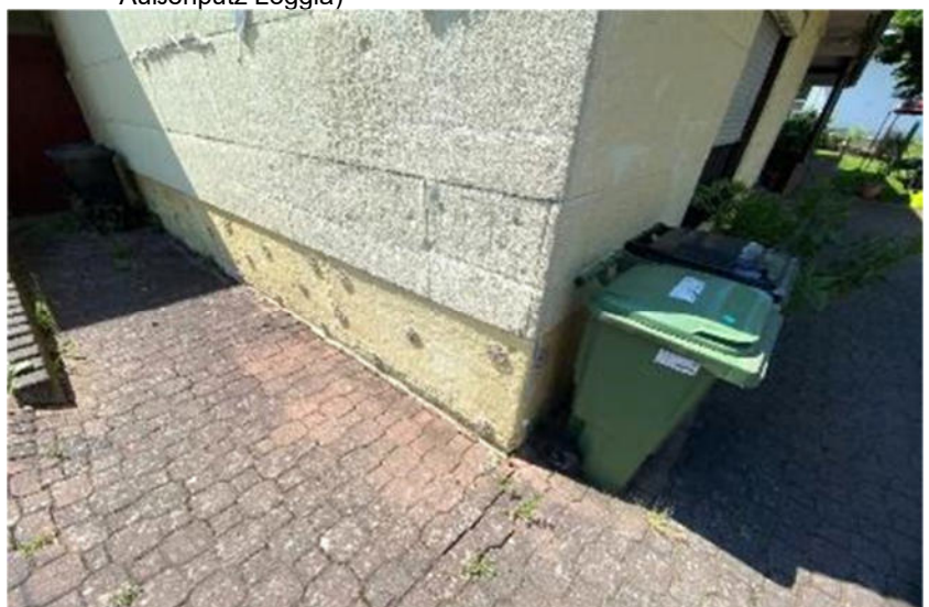
Abb. 6: Foto des SV; z.T. Fassade schadhaft (fehlender Oberputz WDVS)
