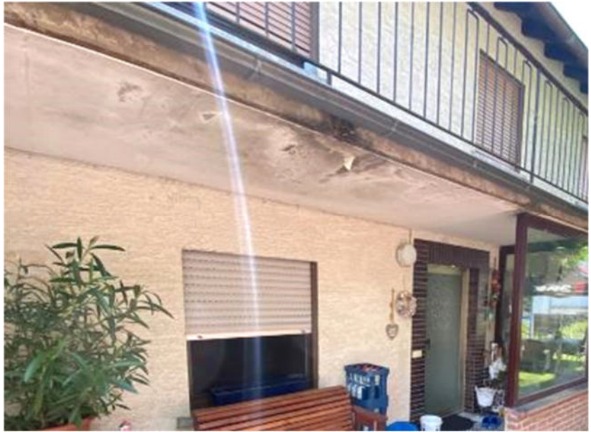
Abb. 7: Foto des SV; z.T. Feuchteschäden an Betonkragplatte des Balkons
