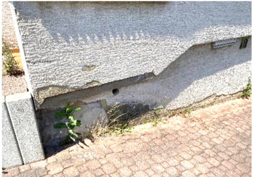
Abb. 3: Foto des SV; z.T. Fassade schadhaft (Putzschäden im Sockelbereich, Putzverfärbungen)
