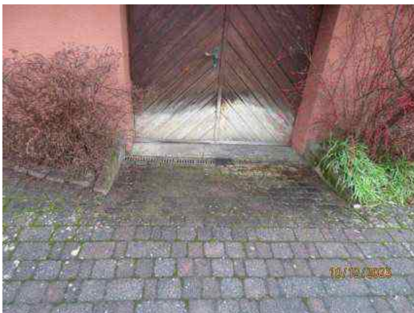
Bild 6: Eingangstor im Untergeschoss mit anstehendem Überholungsanstrich
