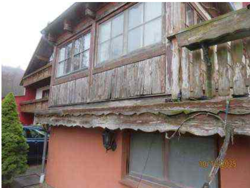
Bild 5: Teilansicht des Terrassengeländers und dem Wintergarten mit Sanierungsbedarf
