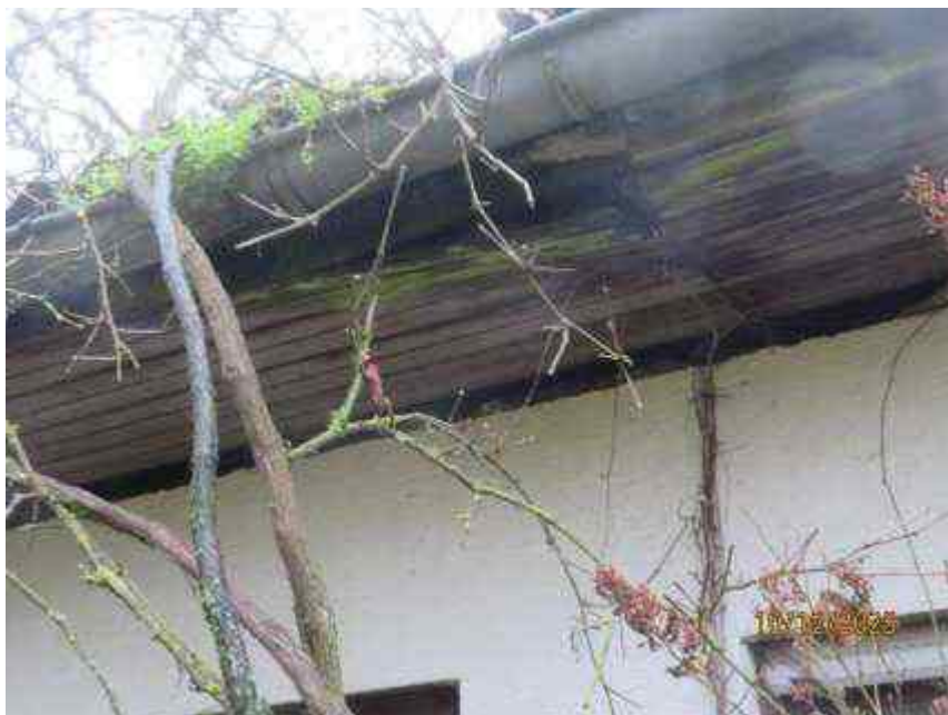
Bild 11: Teilansicht der Werkstatt mit Feuchteschaden
