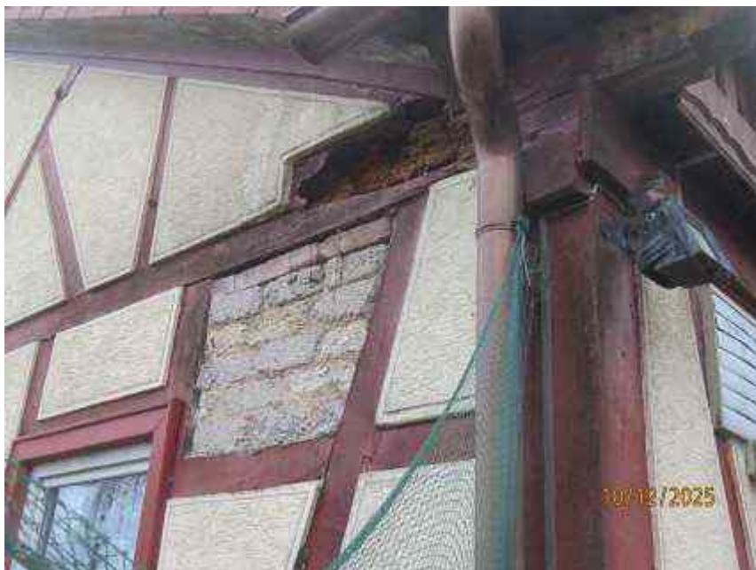
Bild 19: Teilseitenansicht mit Sanierungsbedarf
