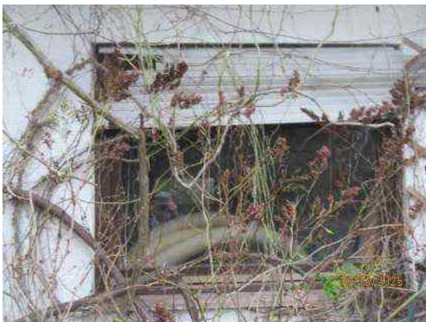
Bild 12: Teilansicht der Werkstatt, Schäden am Fenster / Rollladen
