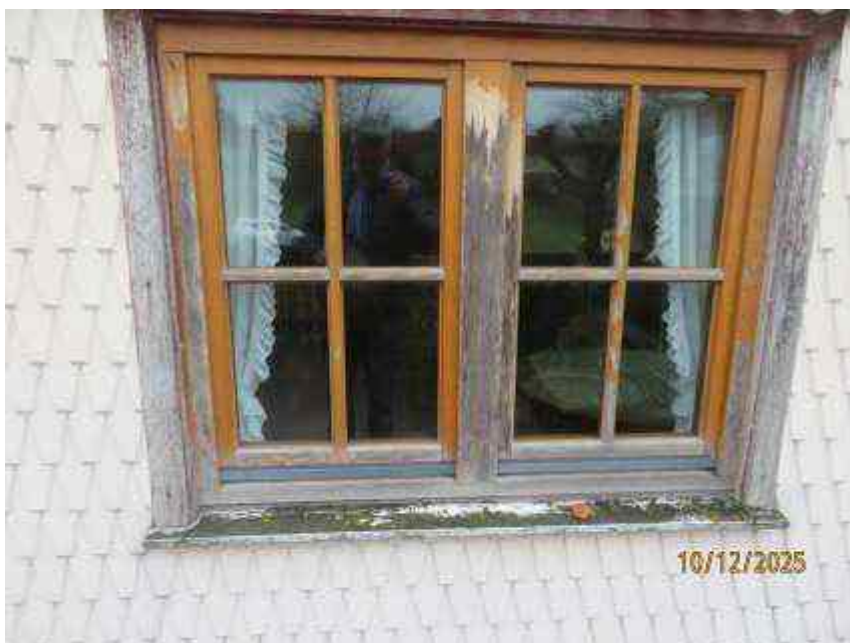
Bild 4: Teilansicht von einem Fenster mit anstehendem Überholungsanstrich, stellvertretend für Weitere
