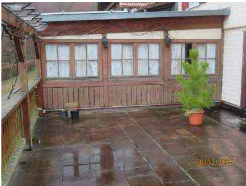
Bild 3: Terrassenfläche (Sondernutzungsrecht zu der Einheit 2) und Teilansicht des Wintergartens mit Sanierungsbedarf
