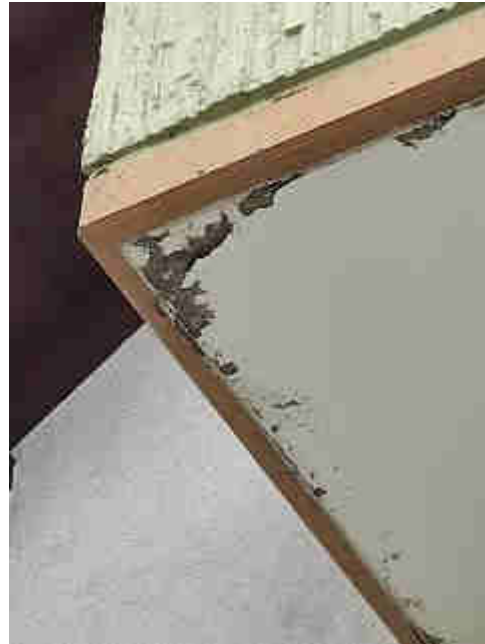
Bild 8: Schaden am Balkon
