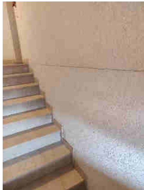
Bild 10: Risse an der Treppenhauswand
