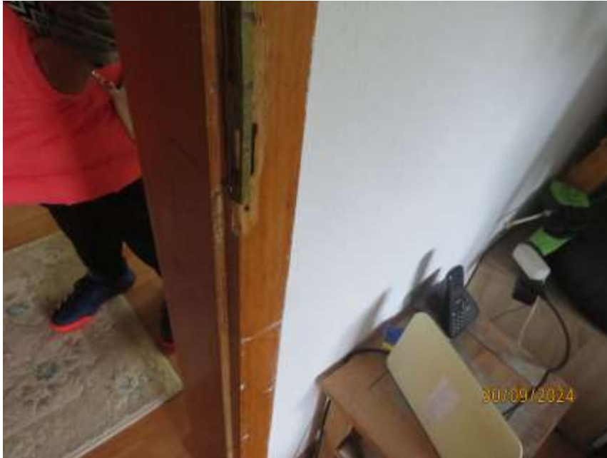
Bild 23: Teilansicht einer schadhaften Tür; stellvertretend für Weitere
