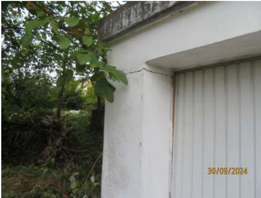
Bild 5: Risse an der Außenwand der Garage
