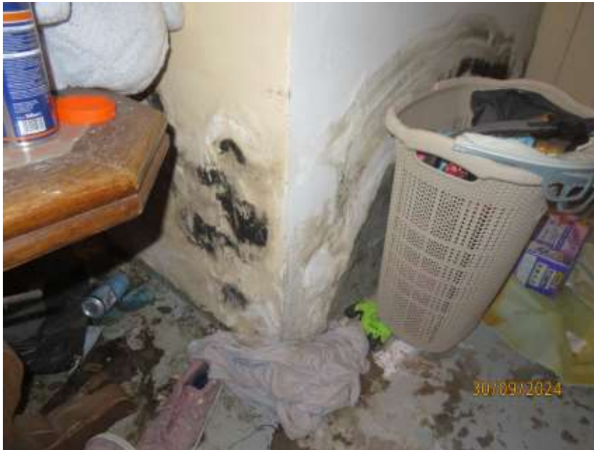
Bild 17: Teilansicht zu dem Wasserschaden (Verdacht auf Hausschwamm im UG.)
