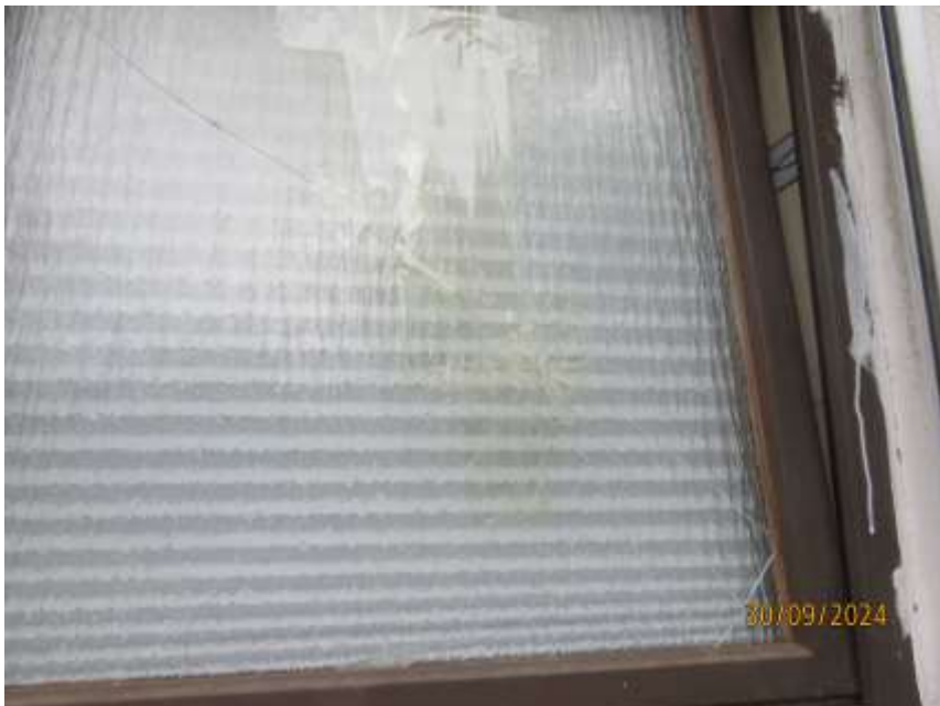
Bild 30: Gerissene äußere Glasscheibe an dem Fenster zum Bad im Erdgeschoss
