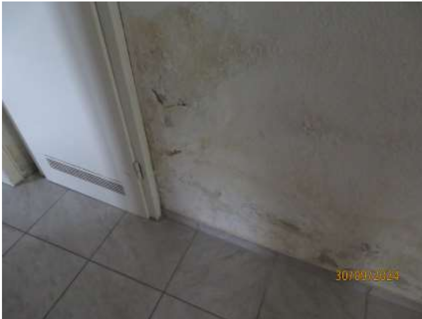
Bild 19: Teilansicht zu dem Wasserschaden (Verdacht auf Hausschwamm im UG.)
