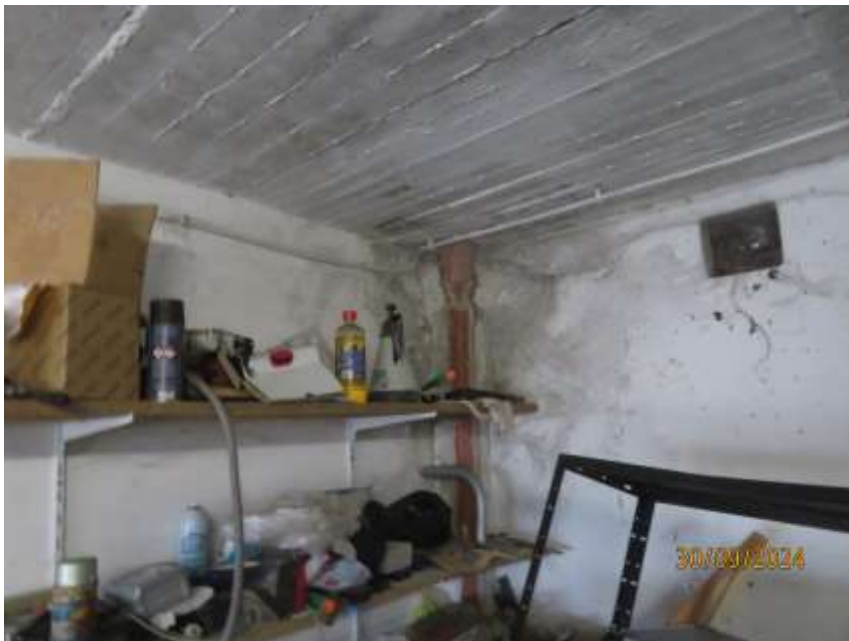
Bild 6: Teilinnenansicht der Garage; unsachgemäße Regenwasserableitung
