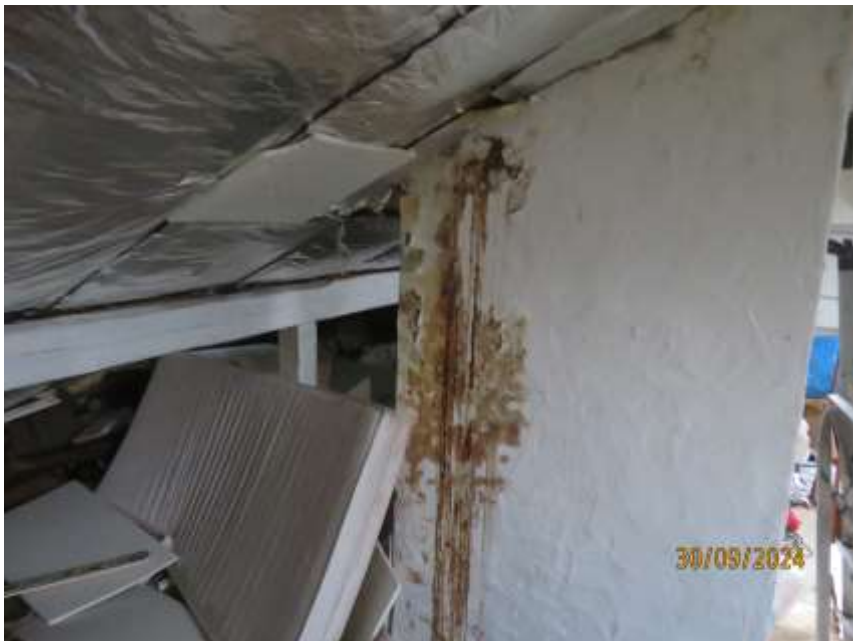
Bild 26: Teilansicht Feuchte am Kamin im Spitzbodenbereich
