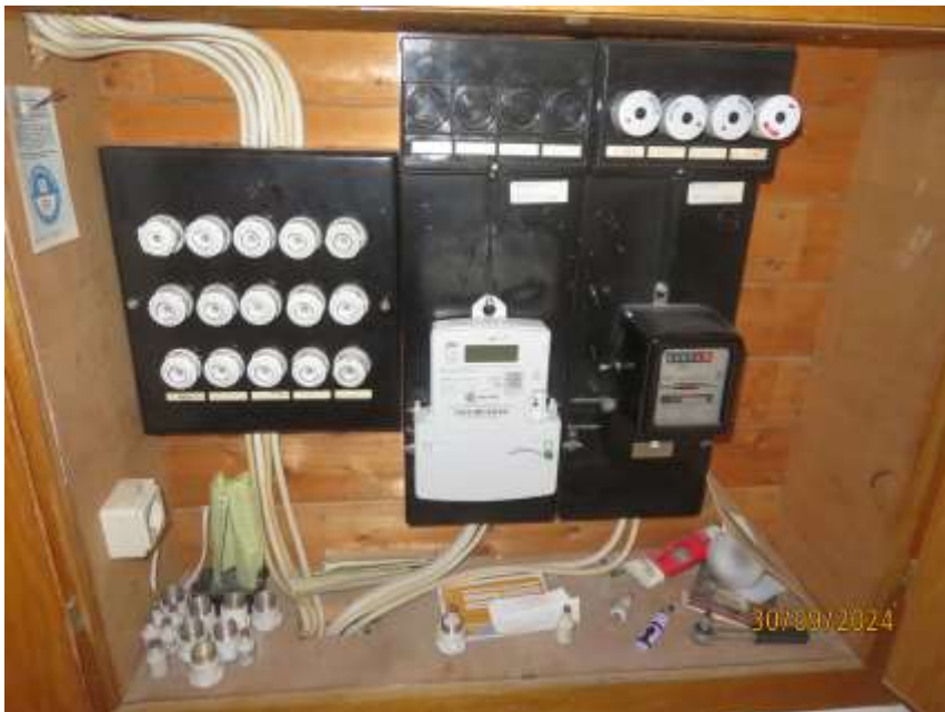
Bild 24: Ansicht der Elektrounterverteilung
