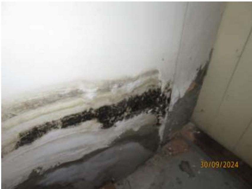
Bild 18: Teilansicht zu dem Wasserschaden (Verdacht auf Hausschwamm im UG.)
