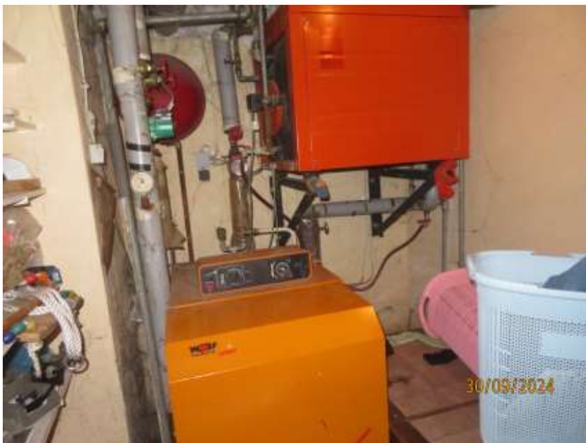
Bild 28: Teilansicht der Heizungsanlage
