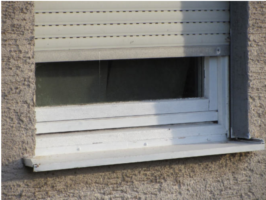
Bild 13: Zustand alte Holzfenster
