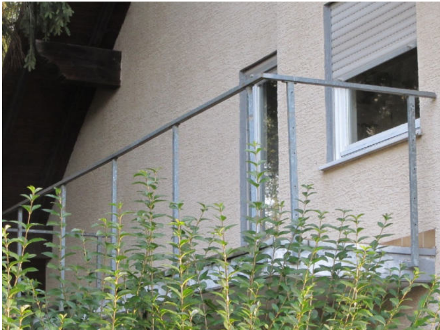
Bild 7: Fehlende Balkonstäbe (Balkon im DG)
