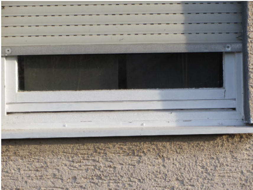
Bild 11: Zustand alte Holzfenster
