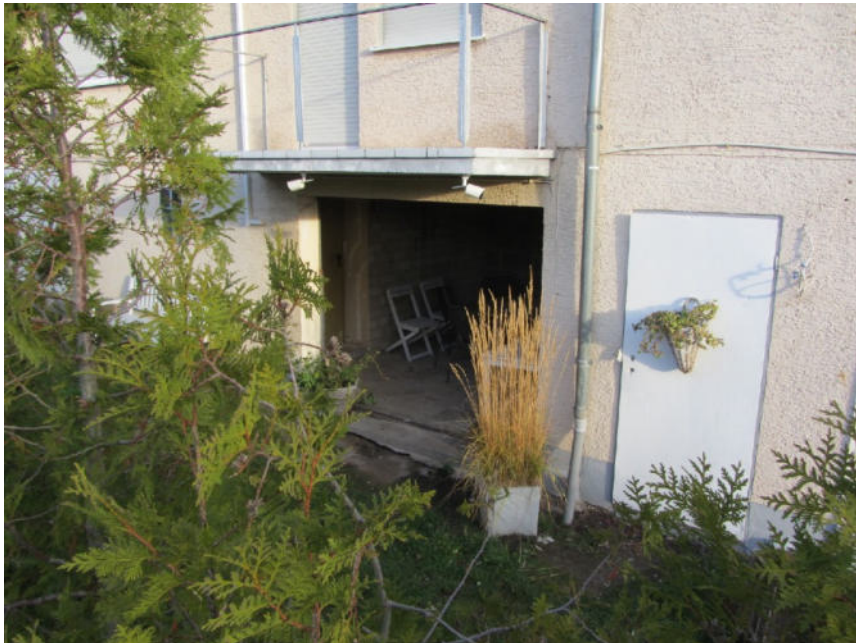
Bild 15: Fehlende Balkonstäbe (Balkon im 1.OG)
