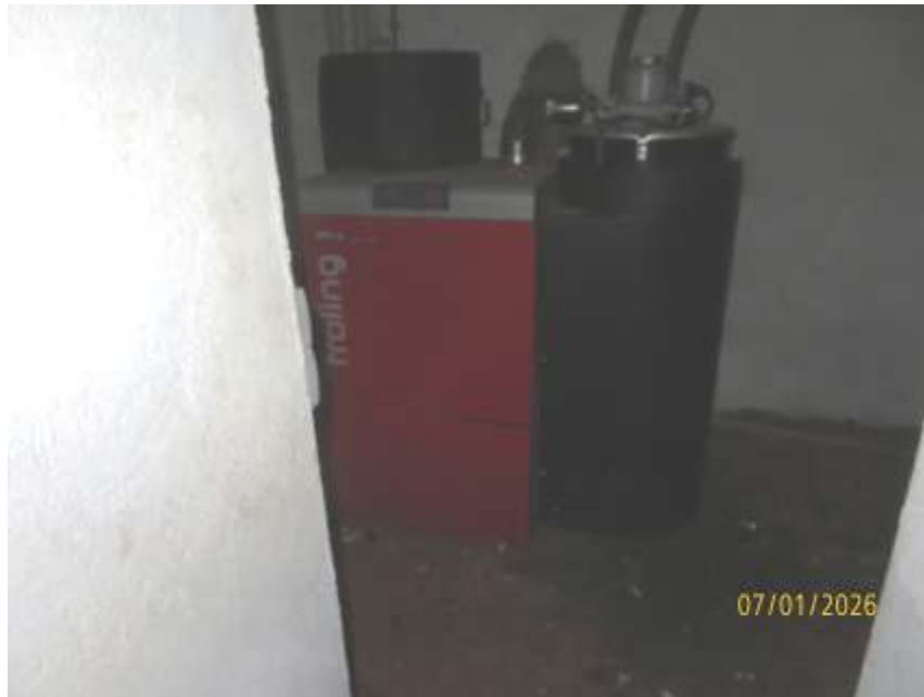
Bild 9: Teilansicht der Heizungsanlage
