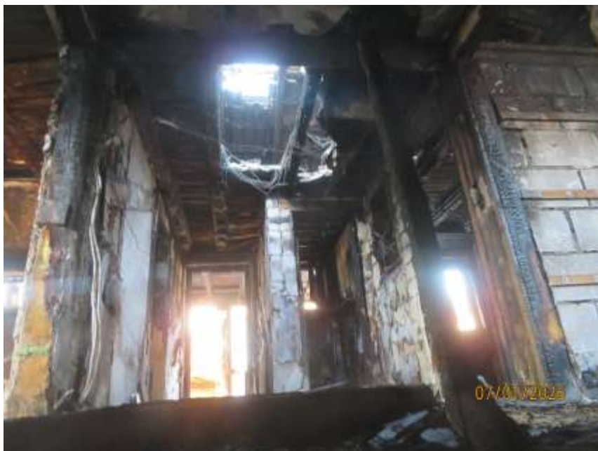
Bild 24: Teilansicht im DG. mit Brandschaden, stellvertretend für Weitere
