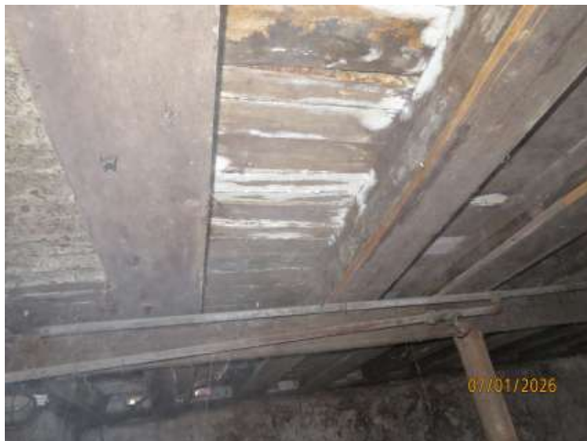
Bild 28: Teilansicht Hausschwamm an der Deckenunterseite zu den ehemaligen Stallungen
