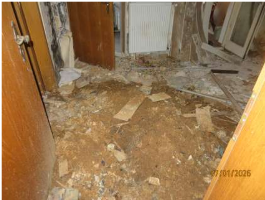
Bild 17: Schäden im EG., stellvertretend für Weitere
