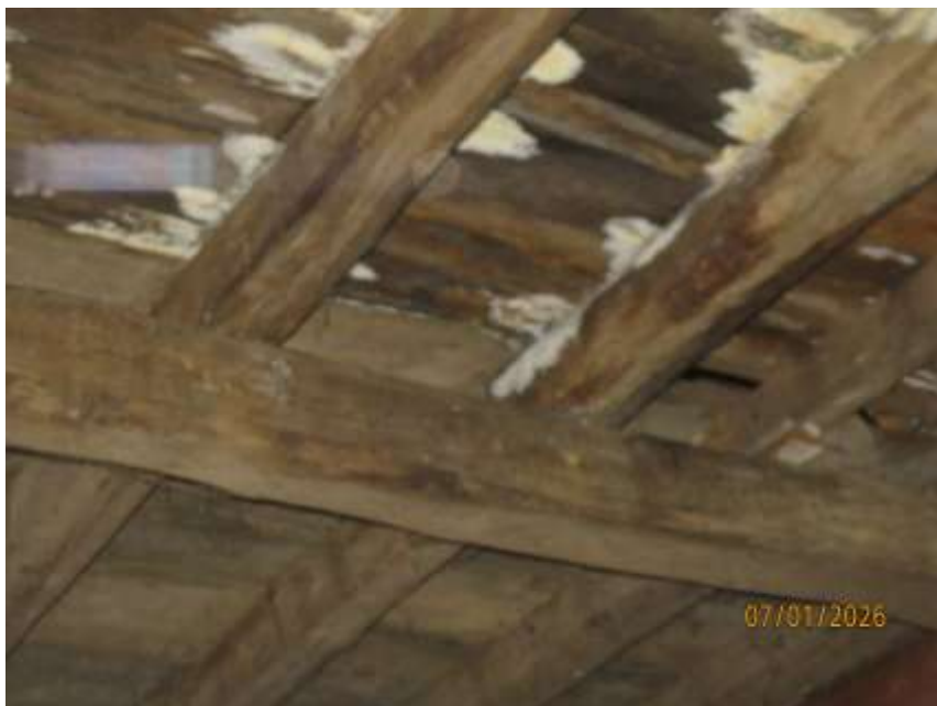
Bild 12: Teilansicht Hausschwamm im Bereich der Garage, rechts neben dem Wohnhaus
