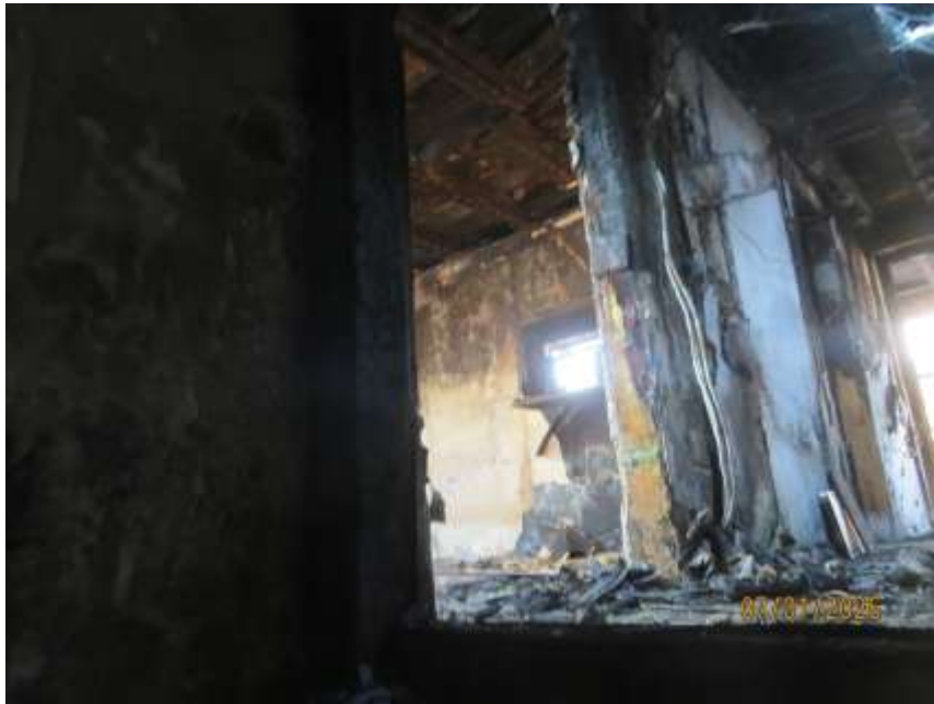
Bild 25: Teilansicht im DG. mit Brandschaden, stellvertretend für Weitere
