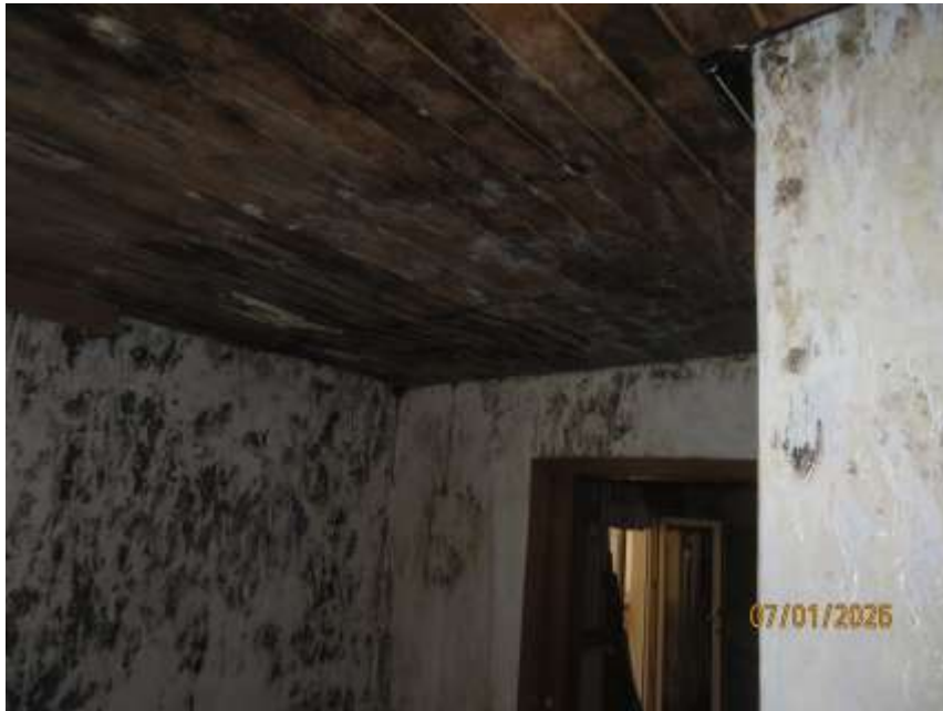
Bild 23: Teildeckenuntersicht im EG. mit Feuchteeinwirkung bzw. Hausschwammbildung
