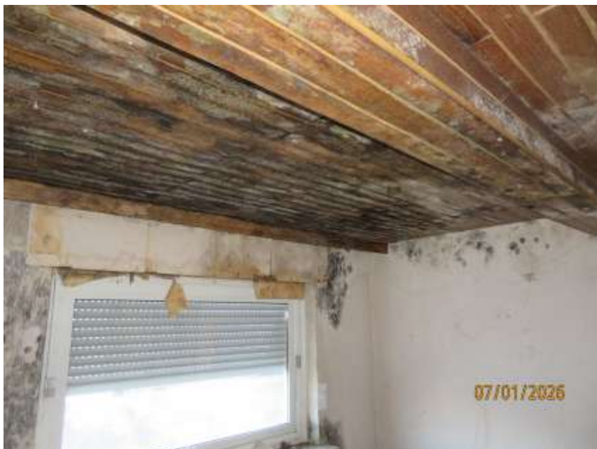
Bild 20: Teildeckenuntersicht im EG. mit Feuchteinwirkung bzw. Hausschwammbildung
