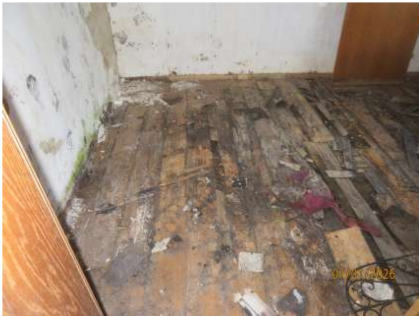
Bild 15: Bodenbelagsschäden im EG., stellvertretend für Weitere
