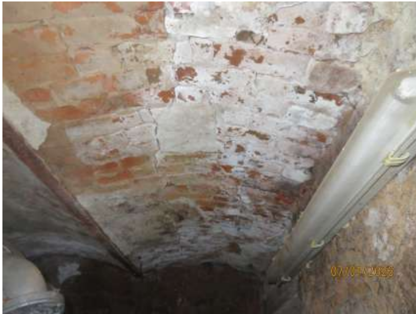
Bild 29: Teilansicht schadhafte Kellerdecke
