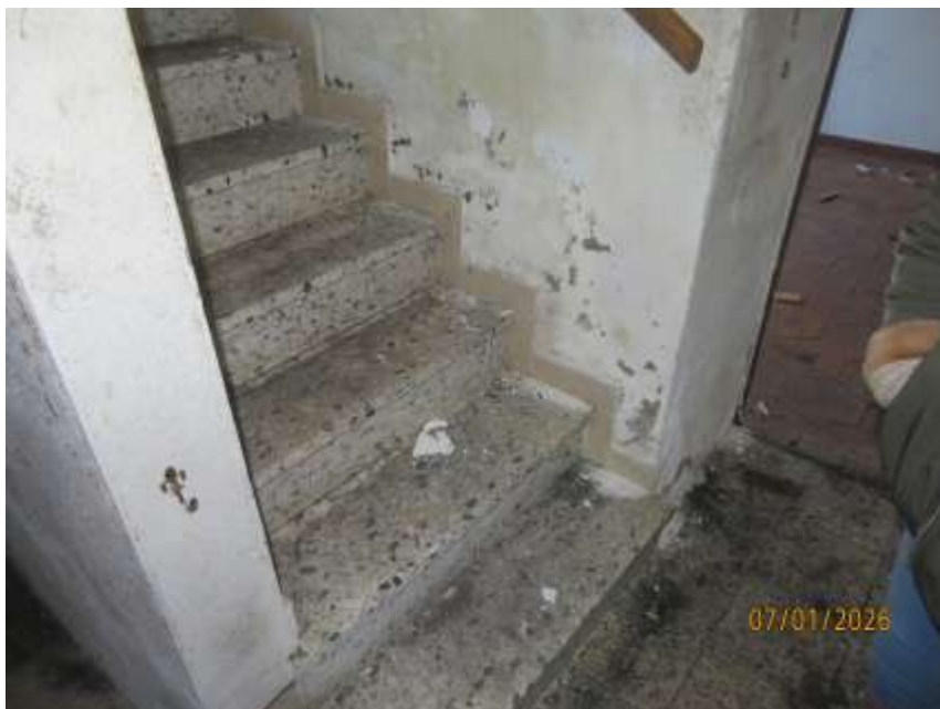
Bild 14: Feuchteschäden im UG., stellvertretend für Weitere
