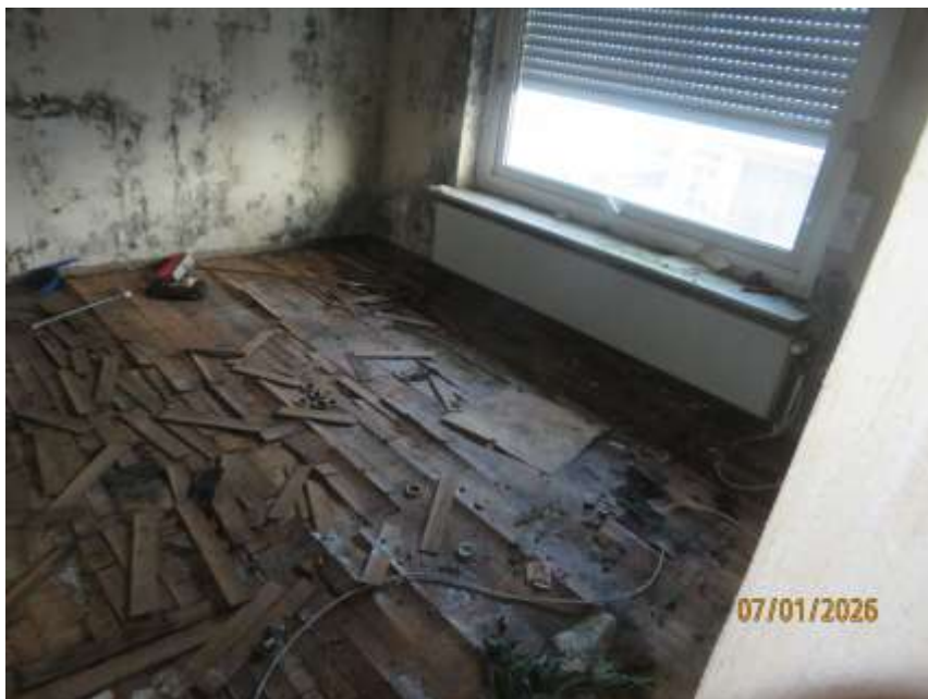
Bild 22: Bodenbelagsschäden im EG., stellvertretend für Weitere
