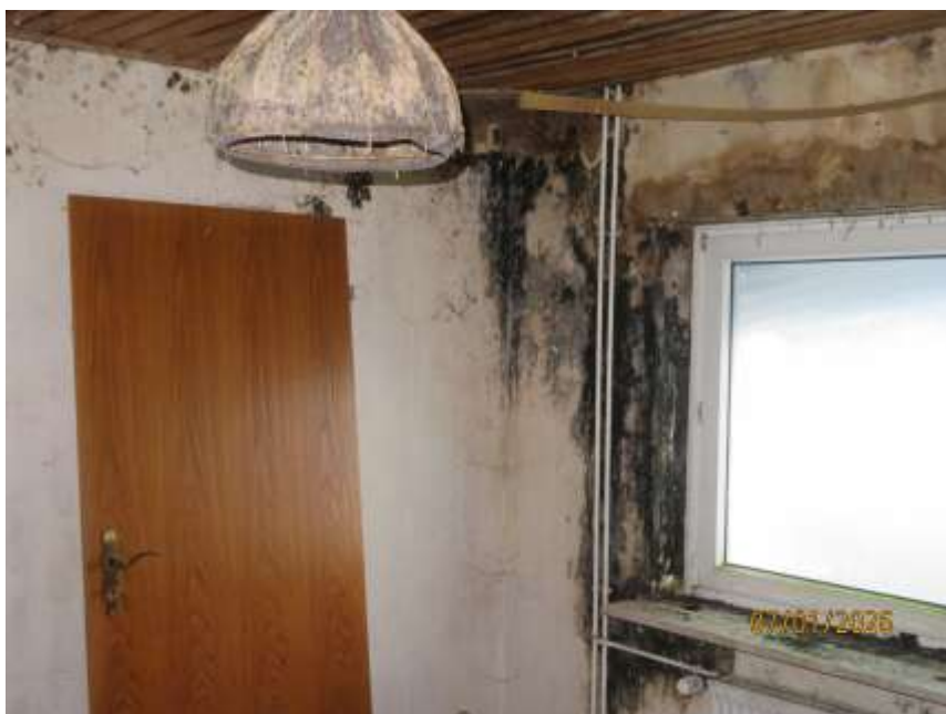
Bild 16: Feuchtschäden / Hausschwamm im EG., stellvertretend für Weitere
