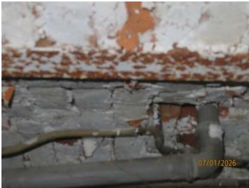
Bild 13: Stark angerostete „Preussisches Kappengewölbe“ mit erheblichen Schäden
