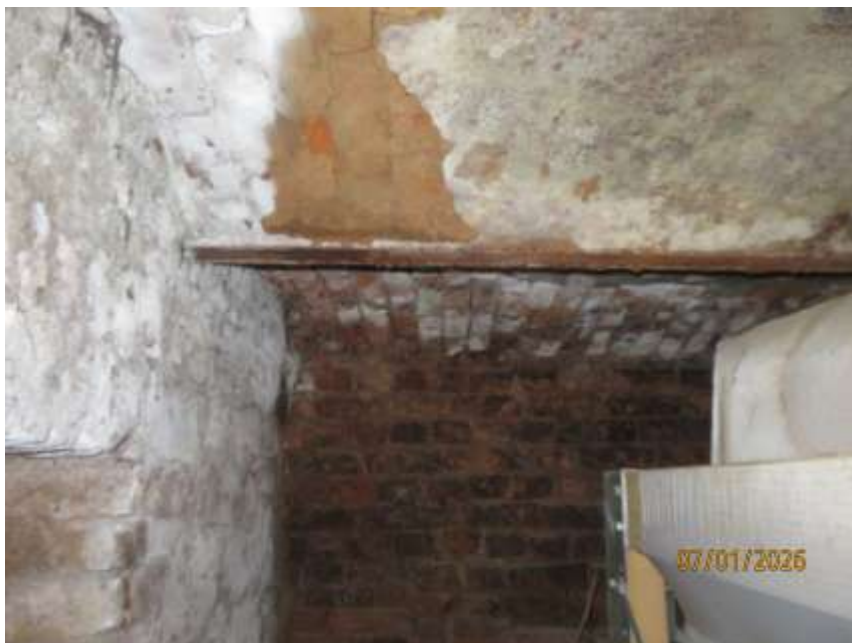
Bild 30: Teilansicht schadhafte Kellerdecke im Bereich des Pelletlagers
