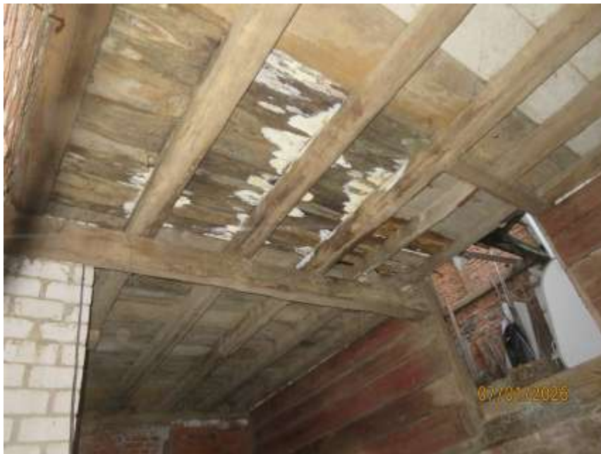
Bild 11: Teilansicht Hausschwamm im Bereich der Garage, rechts neben dem Wohnhaus
