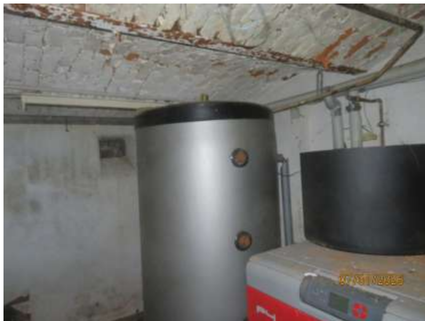
Bild 10: Teilansicht der Heizungsanlage
