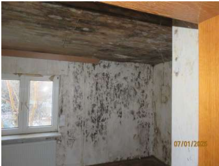
Bild 21: Teildeckenuntersicht im EG. mit Feuchteinwirkung bzw. Hausschwammbildung
