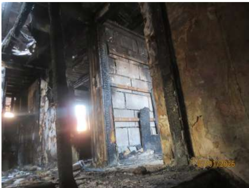
Bild 26: Teilansicht im DG. mit Brandschaden, stellvertretend für Weitere
