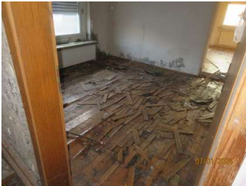
Bild 19: Bodenbelagsschäden im EG., stellvertretend für Weitere
