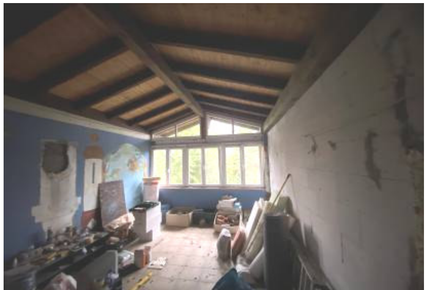
Abb. 4: Foto des SV; z.T. nicht fertiggestellter Raum (EG), fehlende Wandbekleidungen
