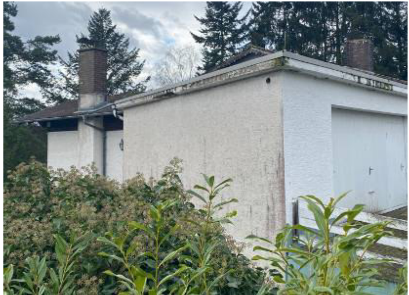
Abb. 3: Foto des SV; z.T. Betonschäden der Dachrandbereiche des Garagenanbaus
