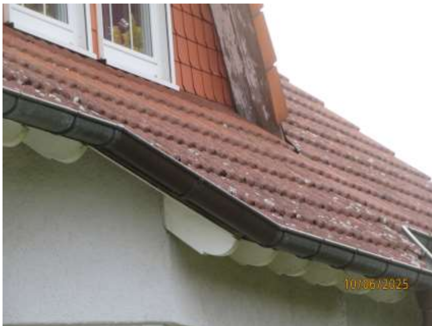
Bild 11: Teilansicht der Gesimse mit anstehendem Überholungsanstrich, stellvertretend für Weitere
