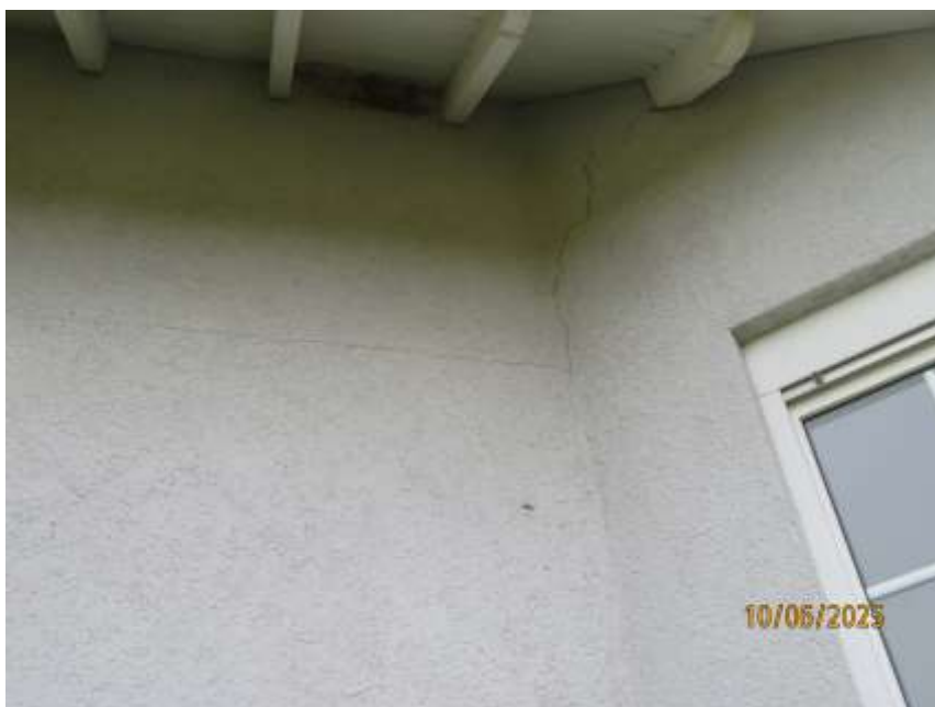
Bild 10: Teilansicht Putzrisse, stellvertretend für Weitere
